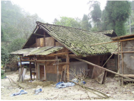
写真 4.2.7.3 木造の住宅 (No.4) 相当傾いているものの倒壊は免れている
