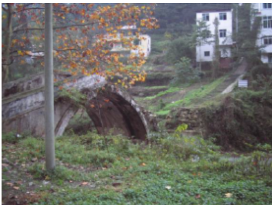
写真 4.2.4.7 崩落した敷地前の橋(2連のアーチ橋であるが、奥のアーチが崩落している。左手前が中学校である。)
