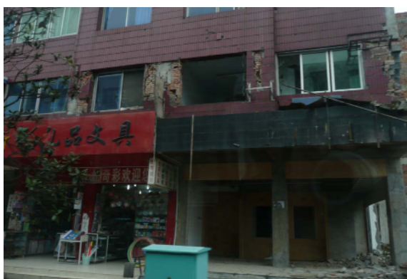
写真 4.3.4 市街地（都江堰）における店舗併用住宅（1階はRC造2階以上は枠組み組積造）の被害
