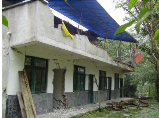
写真 4.2.7.6 レンガ造の建物 (No.9) 2 階パラペットが落下。1階の壁にも重大 なせん断クラックを生じている
