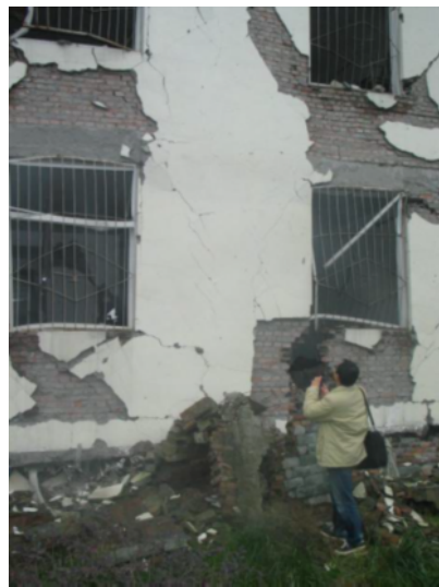
写真 4.2.1.8 写真 4.2.1.7 の建物の詳細 (白い壁部分の中央が RC 柱であるが、RC 柱およびレンガのそで壁にもせん断ひび割れが見られた。)
