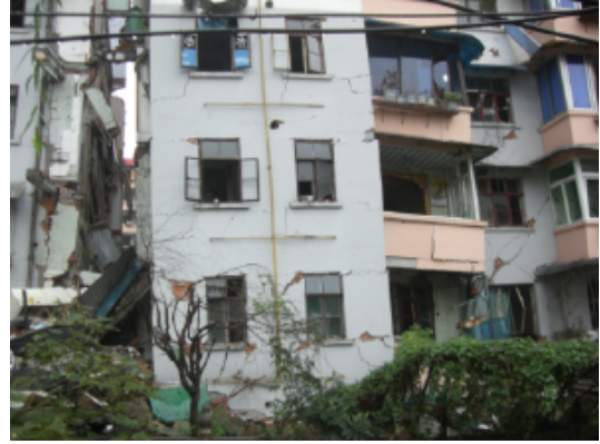
写真 4.2.3.25 立入禁止区域内住宅の被害状況
