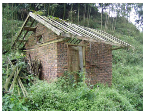
写真 4.2.7.2 レンガ造小規模建物 (No.6) 壁の大きなせん断クラック、瓦の落下などが見られるが、原型を留めている。
