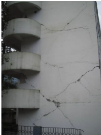
写真 4.2.4.5 写真 4.2.4.4 の左の妻面 (妻面の壁は大きく損傷している。)
