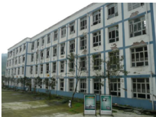
写真 4.2.4.3 断層下側の建物 ( 腰壁、方立て壁のほとんどが大きく損傷し、特に奥側 4 階の方立て壁の損傷は激しい。 )
