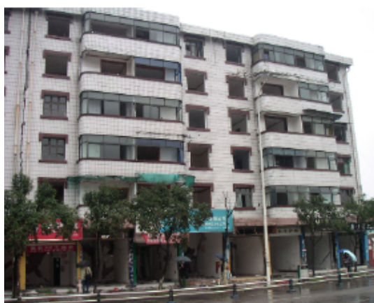
写真 4.2.3.1 （店舗兼住宅 1）1 階柱の曲げ破壊 + 組積壁のせん断破壊
