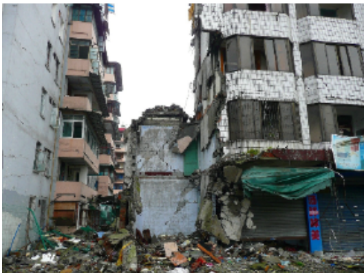
写真 4.2.3.22 (店舗兼住宅 8) 部分的崩壊
