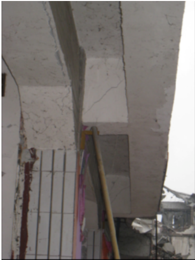
写真 4.2.2.13 写真 4.2.2.11 の張り出し部（1、2階の柱芯のずれのため、片持ち梁が、大きなせん断力を負担したと思われる。）
