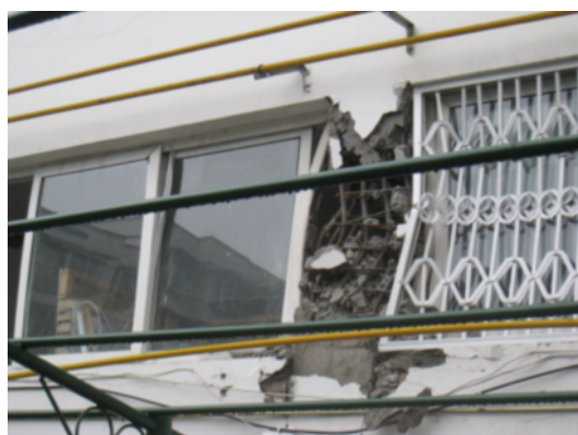
写真4.2.2.8 短柱のせん断破壊（ブロックの腰壁が剛強で短柱化したと思われる。）
