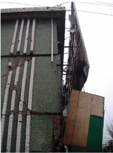
写真 4.2.3.15 (店舗兼住宅 6) 3階組積妻壁のせん断破壊
