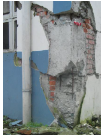
写真 4.2.4.6 写真 4.2.4.3 の手前の柱脚 (RC柱が激しく損傷している。)
