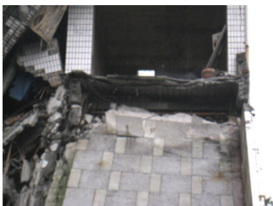
写真 4.2.2.3 写真 4.2.2.1 の 2 階床部分（床版下面のコンクリート剥落により、露出したメッシュ筋が確認できる。）
