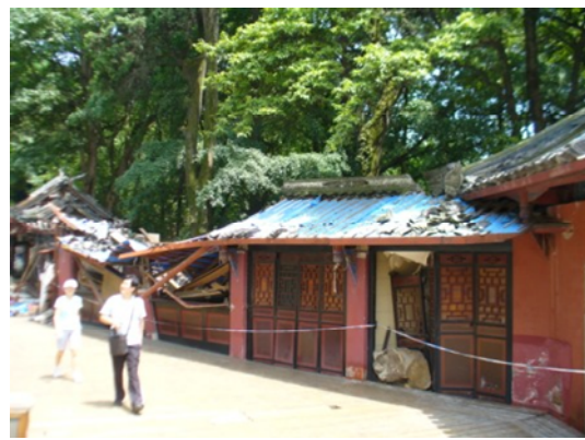
写真 4.2.2.19 歴史的建築物(落石により屋根が陥没している。)
