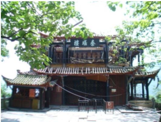
写真 4.2.2.18 歴史的建築物(屋根瓦の脱落)
