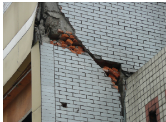
写真 4.2.3.18 (店舗兼住宅 7) 2階組積妻壁の破壊
