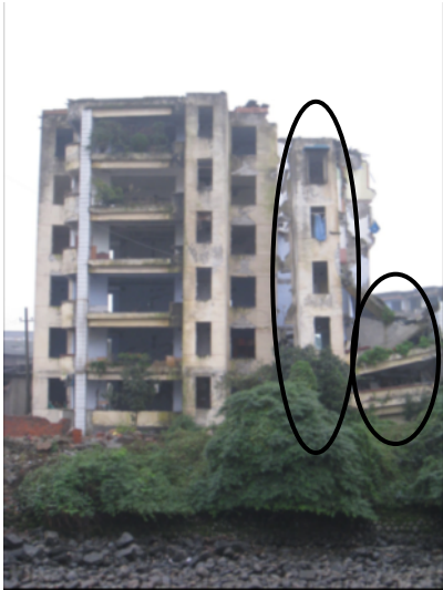
写真 4.2.2.17 部分崩壊した共同住宅 (写真 4.2.2.15 の左奥に見える建物。 建物右側の階段室と思われる部分は、左 側に比べて1層分落下し、右側階段室奥 の部分は完全に崩壊している)
