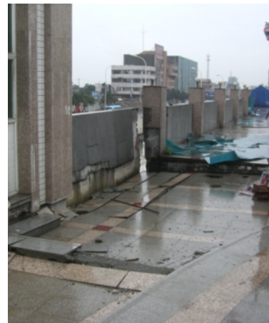
写真 4.2.3.27 擁壁背面部分の地盤沈下
