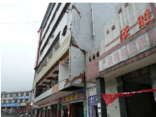
写真 4.2.3.17 (店舗兼住宅 7) 建物崩壊状況(1階と2階柱の不連続による破壊)
