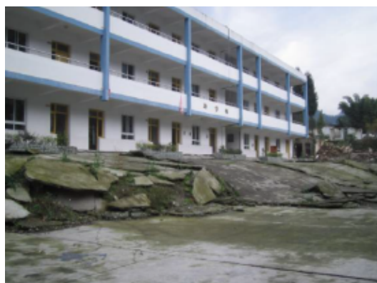
写真 4.2.4.2 断層上側の建物 ( この建物の被害は軽微である。手前の地盤と建物の地盤は地震前には同一の高さ。 )
