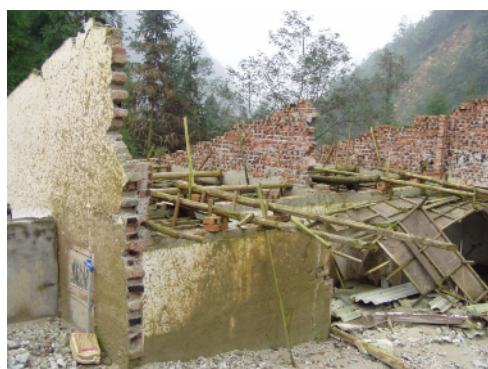
写真 4.2.7.1 レンガ造住宅 (No.3) ゲープルなどが崩壊し、屋根が落下している
