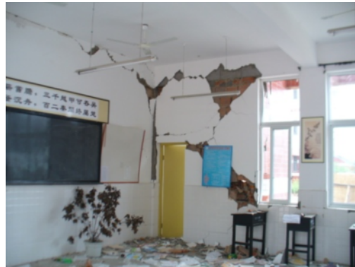
写真10 学校教室内の組積造壁の脱落 (綿竹市市街地)
