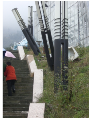
写真 4.2.3.29 公園内構造物の被害 2 (照明灯の傾斜)
