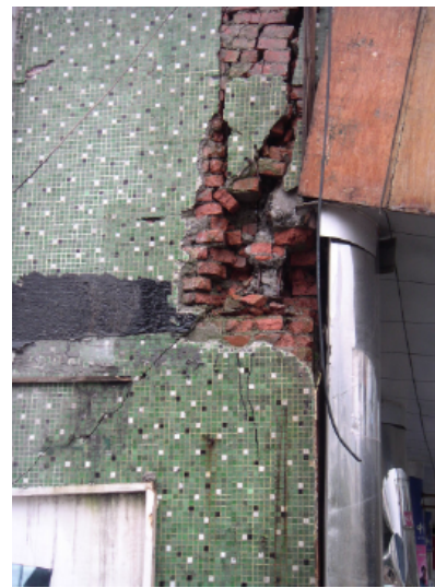
写真 4.2.3.16 (店舗兼住宅 6) 2階の壁端脚部の破壊
