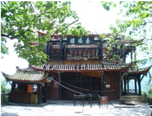
写真 4.2.2.18 歴史的建築物(屋根瓦の脱落)
