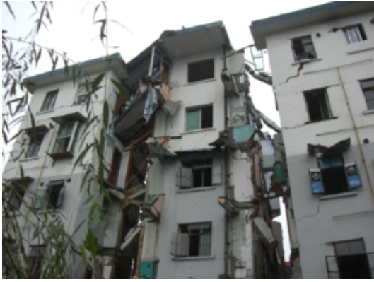
写真 4.2.3.24 立入禁止区域内住宅の部分的崩壊
