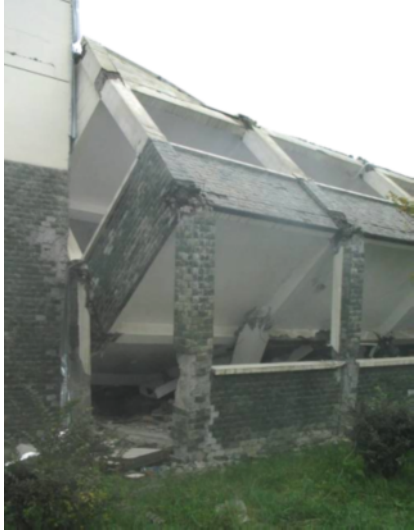
写真 4.2.1.6 写真 4.2.1.4 の建物の裏側 (裏側の 1 階柱も柱頭柱脚で曲げ破壊しているが、残留変位はさほど見られない。)
