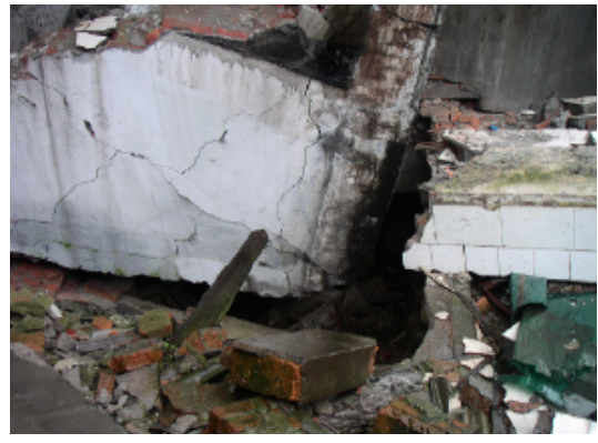
写真 4.2.3.14 (店舗兼住宅 5) 基礎部からの脱落
