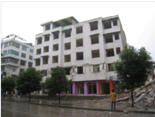
写真 4.2.2.11 2 層が大きく損傷（1 階 柱と 2 階以上の柱位置が異なる。）
