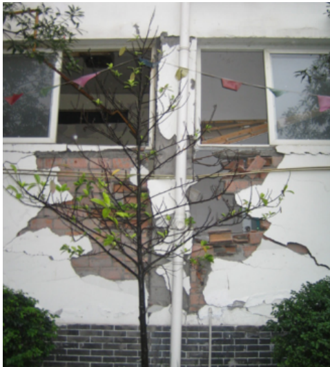
写真 4.2.2.9 長柱化した柱（腰壁（ブ ック）の崩壊が先行したことで、RC 柱 が長柱化したと推察される。）
