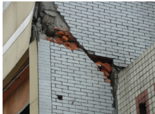
写真 4.2.3.18 (店舗兼住宅 7) 2階組積妻壁の破壊
