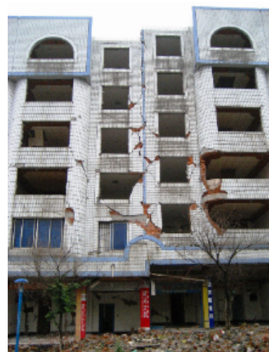
写真 4.2.3.8 (金融ビル) 2階以上の組積壁せん断破壊 (正面)
