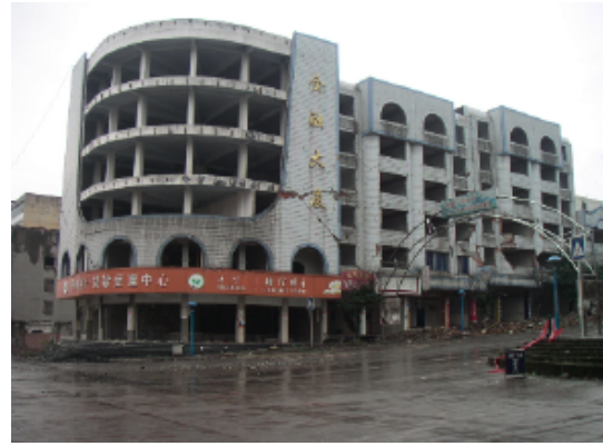
写真 4.2.3.6 (金融ビル) 1階柱曲げ破壊および2階以上組積壁のせん断破壊
