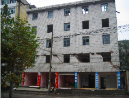
写真 4.2.3.9 (店舗兼住宅 4) 1階柱曲げ 破壊 + 1・2階組積壁せん断破壊
