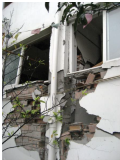
写真 5.10 腰壁が先に壊れて短柱とはならなかった柱（写真 5.9 と同じ建物）
