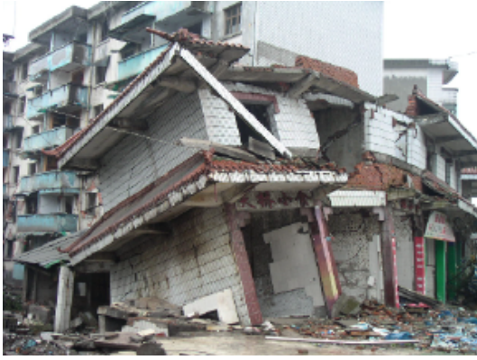
写真 4.2.3.13 (店舗兼住宅 5) 建物崩壊状況
