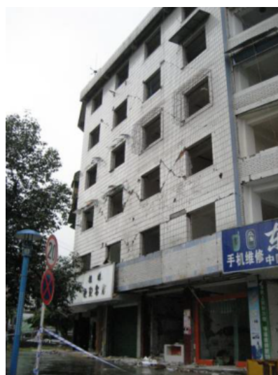
写真 5.16 組積造方立て壁のせん断破壊 写真 5.17 非構造壁の破壊（漢旺） （都江堰）
