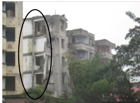
写真 4.2.2.16 部分崩壊した共同住宅(写真 4.2.2.15 の右奥に見える建物。外壁に見える白い壁は、部分崩壊により露出した内壁の一部と思われる。)
