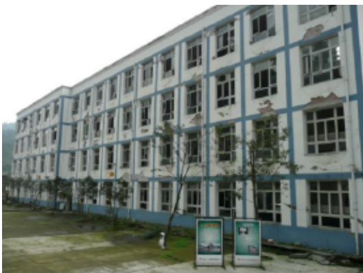
写真 4.2.4.3 断層下側の建物 ( 腰壁、方立て壁のほとんどが大きく損傷し、特に奥側 4 階の方立て壁の損傷は激しい。 )
