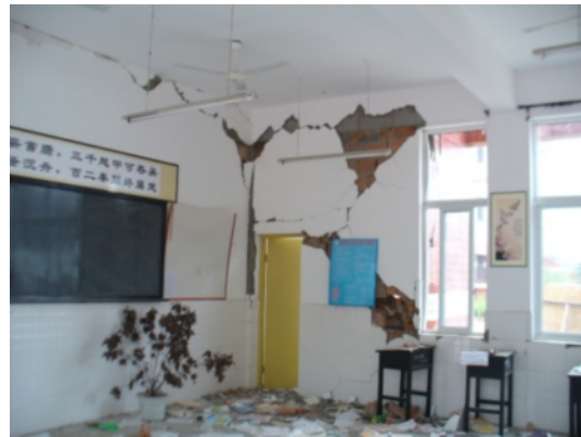
写真 4.2.6.2 学校教室内の内装材の脱落
