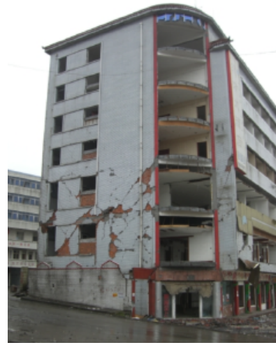
写真 4.2.3.4 (店舗兼住宅 2) 2階以上の組積壁のせん断破壊
