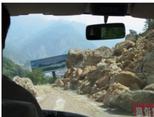
写真 4.2.5.1 落石による道路損傷 (北川県入口)
