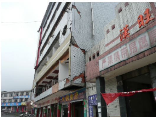
写真 4.2.3.17 (店舗兼住宅 7) 建物崩壊状況(1階と2階柱の不連続による破壊)
