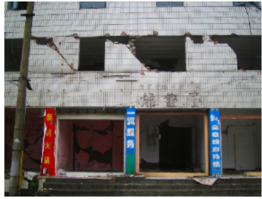
写真 4.2.3.10 (店舗兼住宅 4) 破壊状 況 (拡大)
