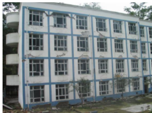
写真 4.2.4.4 写真 4.2.4.3 の奥のほう ( 4 階の方立て壁の上部がせん断破壊している )
