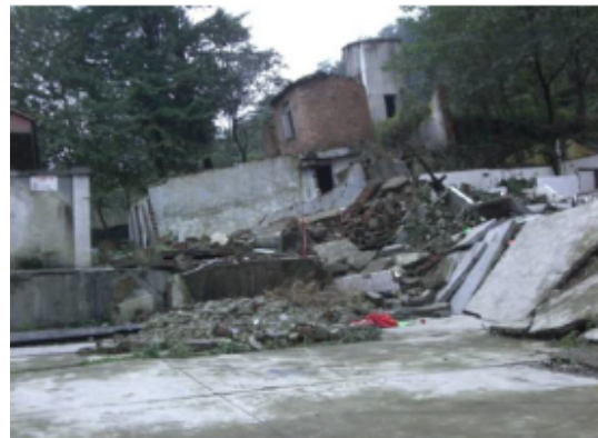
写真 4.2.4.8 敷地内の倒壊した建物(断層直上にあり手前の建物は崩壊、奥の建物は傾いている。)
