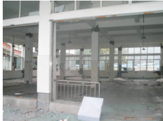
写真 4.2.1.3 写真 4.2.1.2 の内部（柱の柱頭柱脚が曲げ破壊し、主筋の座屈も若干見られた。）
