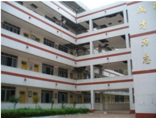
写真 4.2.6.1 天井脱落等の学校建築
