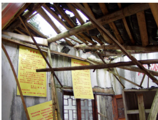
写真 4.2.7.9 組積造の典型的な倒壊パターンの一つであるゲートル崩壊による屋根の落下 (No.7)
