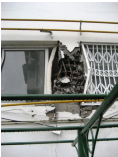
写真 5.9 短柱のせん断破壊（都江堰）
