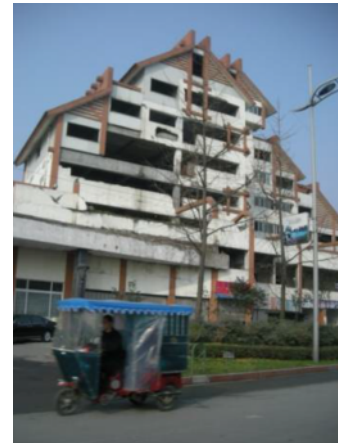
写真 6.2.3.1 都江堰市内の被災ビル
