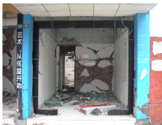
写真 4.2.3.2 （店舗兼住宅 1）1 階内部の破壊状況
