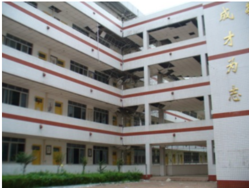
写真9 学校建築の天井脱落等 (綿竹市市街地)
