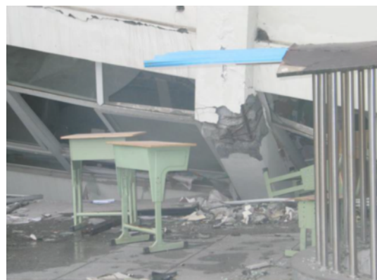
写真 4.2.1.5 写真 4.2.1.4 の建物の1階柱（柱頭の曲げ破壊が見られ、手前に大きく傾斜している。）
