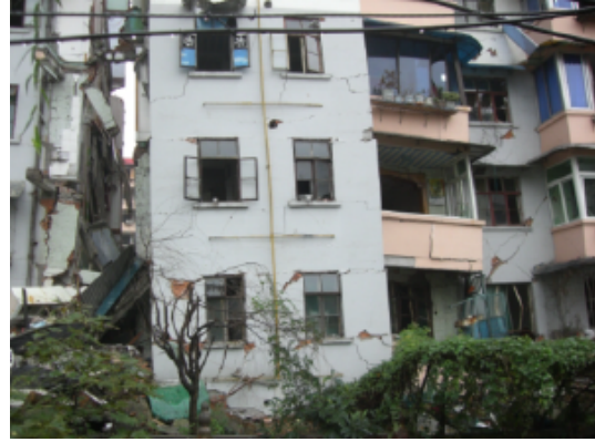
写真 4.2.3.25 立入禁止区域内住宅の被害状況
