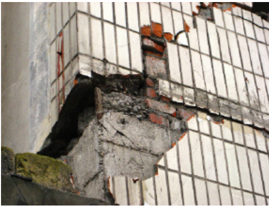
写真 4.2.3.11 (店舗兼住宅 4) 破壊状況 (拡大) 2階隅柱の破壊状況
