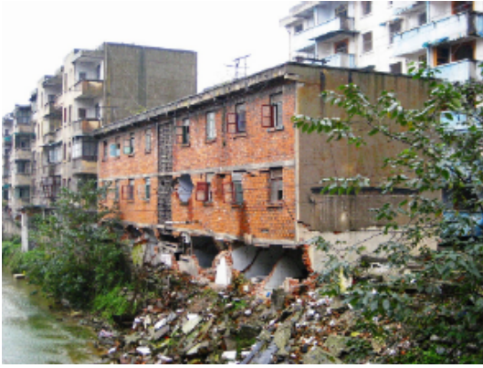
写真 4.2.3.19 (住宅 1) 3階建て組積造の破壊(1階が大きく破壊)
