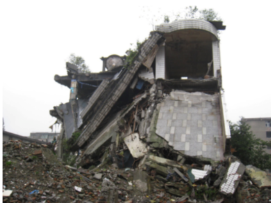
写真 4.2.2.1 入口の部分崩壊
