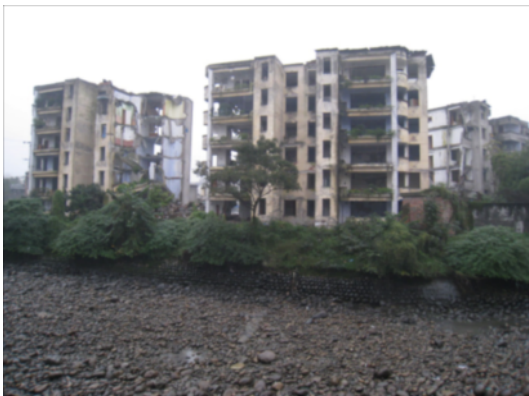
写真 4.2.2.15 共同住宅群（右側は損傷が少ないが、左側は部分崩壊となっている。）
