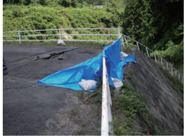
写真-5.54 衣川5号ダム天端の亀裂
