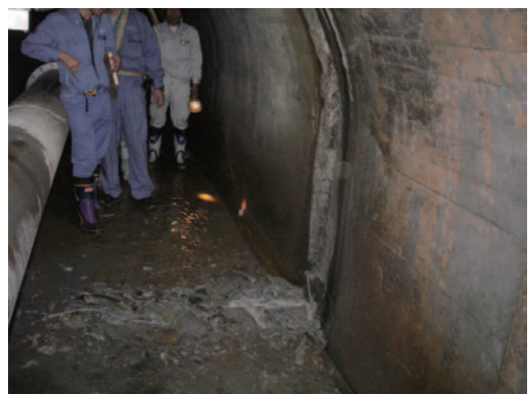
写真-5.31 アクセストンネルのジョイント部の破損
