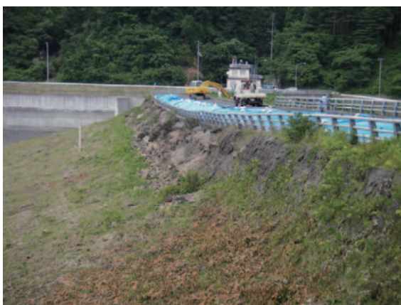
写真-5.42 波返しの石積の損傷状況
