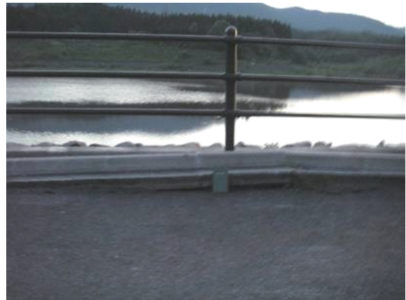
写真-5.30 天端縁石の損傷
