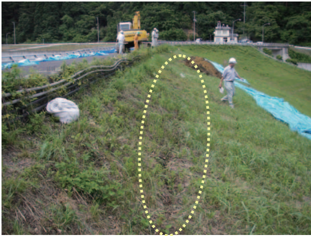
写真-5.44 堤体下流面の縦亀裂
