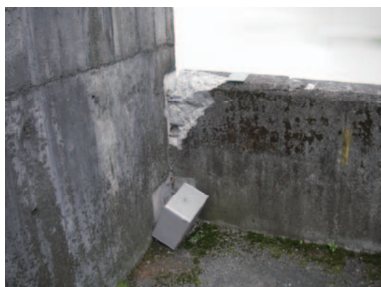
写真-5.39 天端高欄コンクリートの剥落
