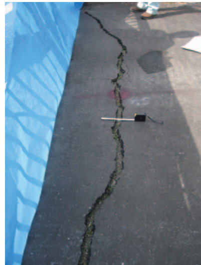
写真-5.52 衣川4号ダム天端舗装の横亀裂（右岸側地山取り付け部）
