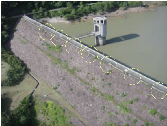
写真-5.2 天端および下流面の状況(天端下流法肩に等間隔でせり出しが確認できる)
