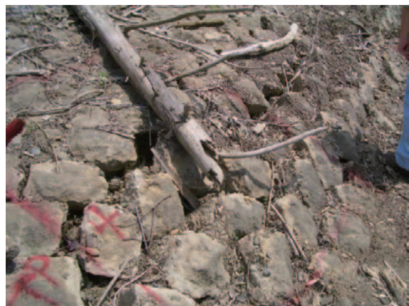
写真-5.43 上流法面の保護張り石ブロックの変状
