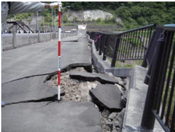
写真-5.4 天端下流法肩付近のせり上がり(段差:約50cm)と高欄の変形
