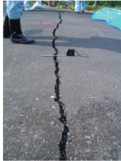
写真-5.51 衣川4号ダム天端舗装の横亀裂（左岸側地山取り付け部）
