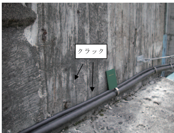
写真-5.38 門柱の亀裂（貯水池側の面）
