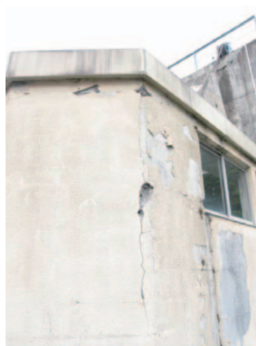
写真-5.40 ゲート巻上機室の壁面の損傷
