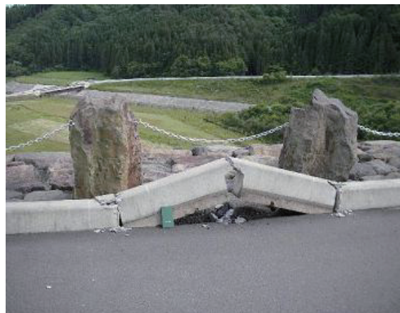
写真-5.32 天端の縁石の破損
