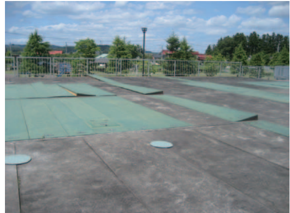
写真-4.10 覆蓋浮き上がり
