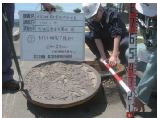
写真-4.1 マンホール隆起【栗原市・鶯沢】
