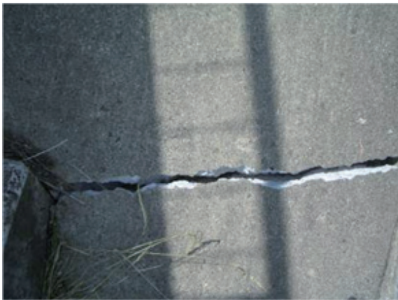
写真-4.11 放流渠法面防護壁の亀裂
