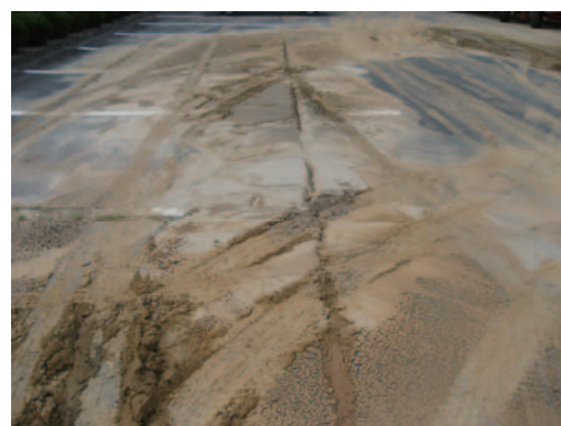
写真-4.2 噴砂【栗原市・鶯沢多目的ホール】
