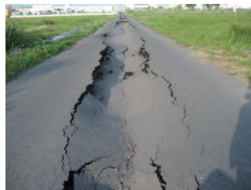
写真-4.6 埋戻し部沈下【栗原市・築館】
