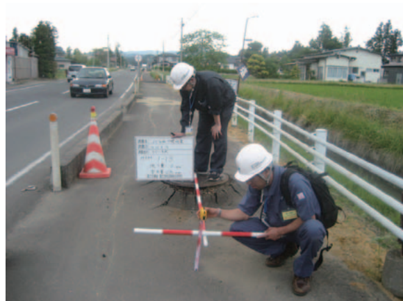
写真-4.7 マンホール浮上がり 29cm 【鷺沢幹線管渠MH.1-13】
