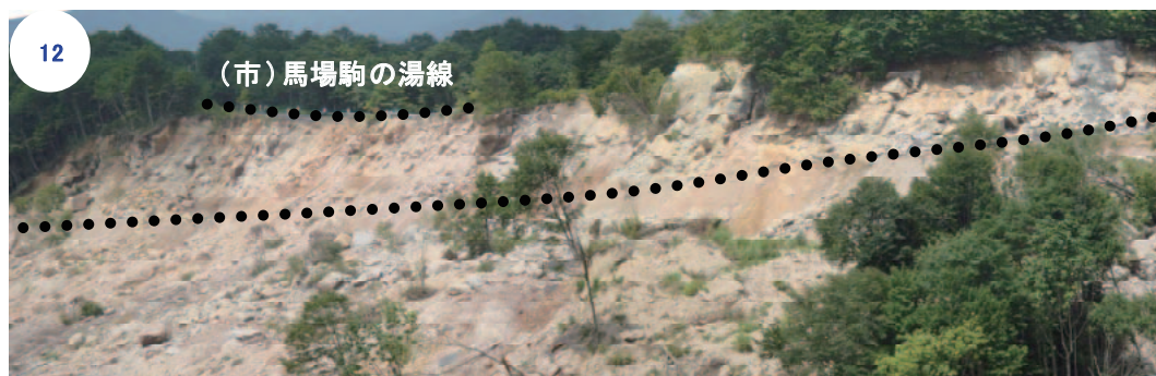
写真-3.4.26 崩壊地内から冷沢の左岸を撮影（8月9日撮影）
