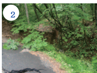
写真-3.4.14 引張り部に生じた陥没帯。斜面下方（荒砥沢側）に連続してみられる。 (6月21日撮影)
