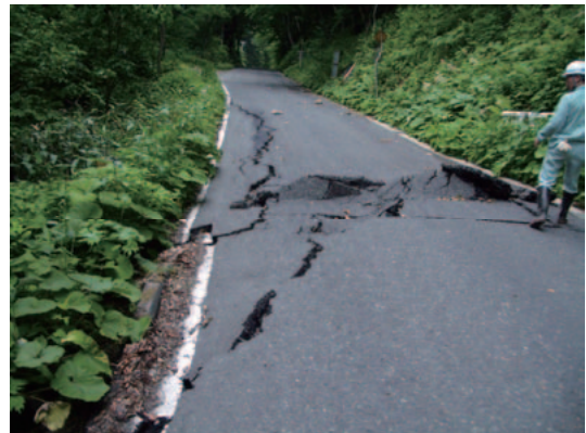
写真-3.4.50 路面に生じたせん断亀裂路面にせん断亀裂が複数見られ、背後は地すべり地形をなしている。(6月22日撮影)
