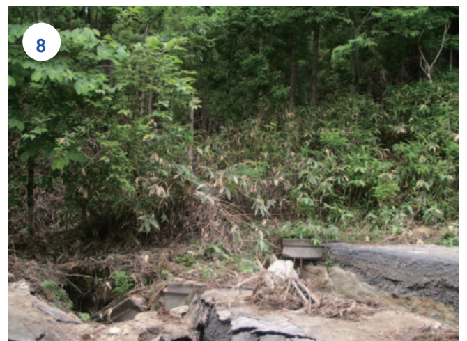
写真-3.4.11 左写真の沢部を正面から望む。この位置で道路が大きくせん断されている。(6月22日撮影)
