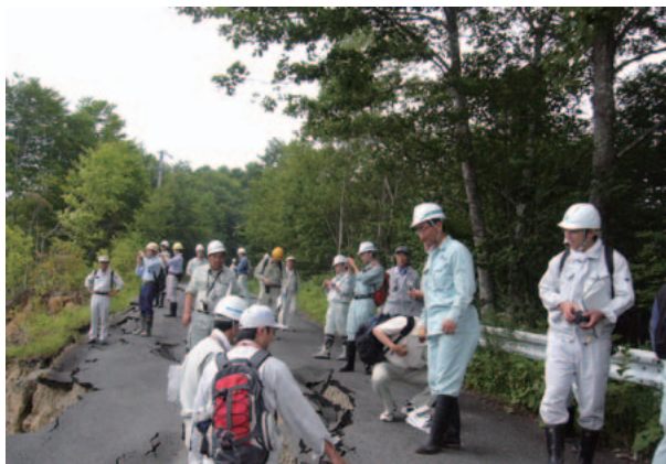
写真-3.4.32 御沢支川の崩壊による市道に生じた亀裂（8月9日撮影）
