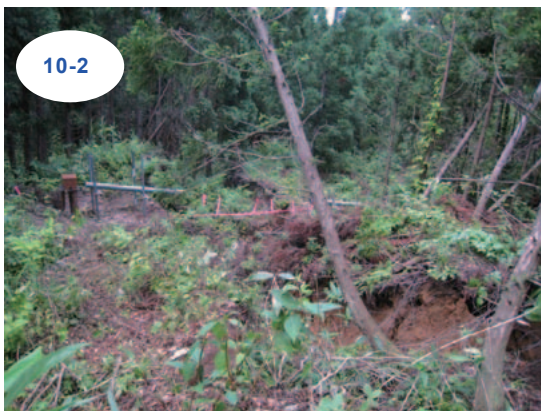
写真-3.4.23 滑落崖上部斜面の亀裂、幅 50cm（7月14日撮影）
