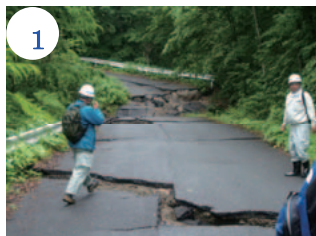
写真-3.4.13 道路を横断する開口亀裂 (6月21日撮影)
