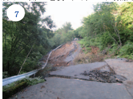
写真-3.4.19 現道の崩壊箇所 (7月14日撮影)
