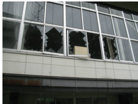
図-4.10 ガラスの破損、障子の脱落（南西側）
