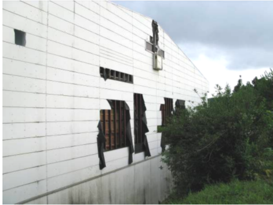
図-4.11 妻面（舞台裏）の外装材の損傷
