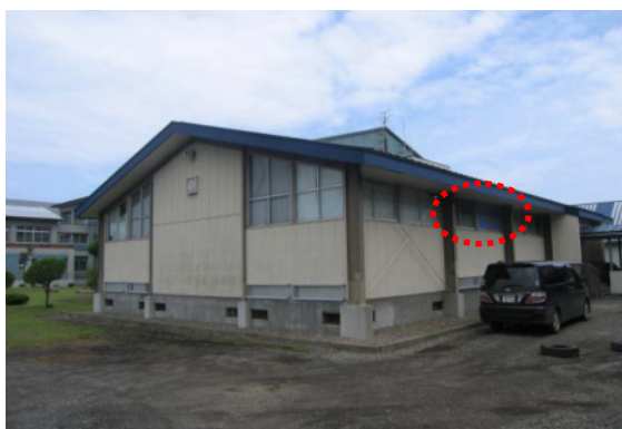
図-4.2 A建築物外観（赤楕円箇所が損傷箇所）
