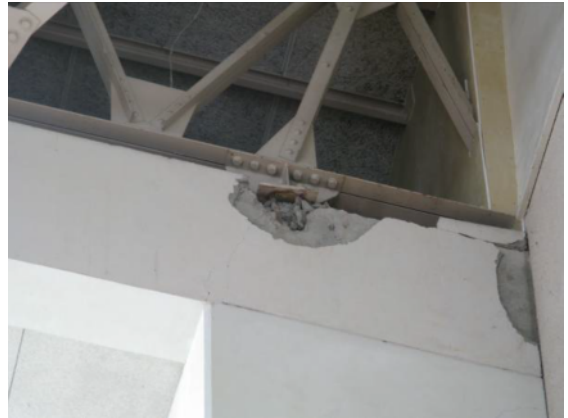
図-4.18 屋根支承部の損傷
