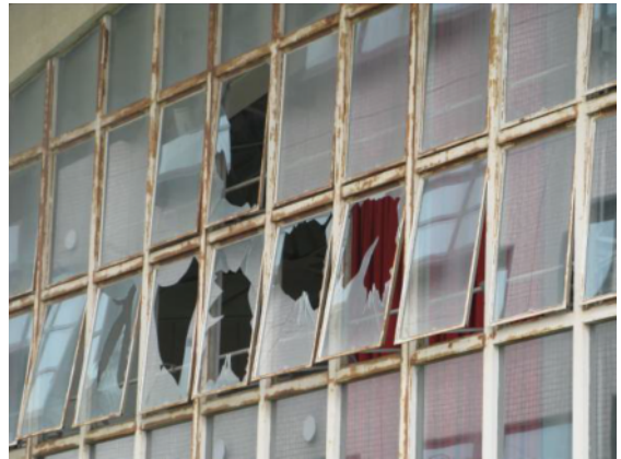
図-4.20 北側妻面の窓ガラスの損傷
