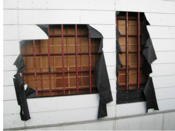
図-4.12 外装材損傷箇所
