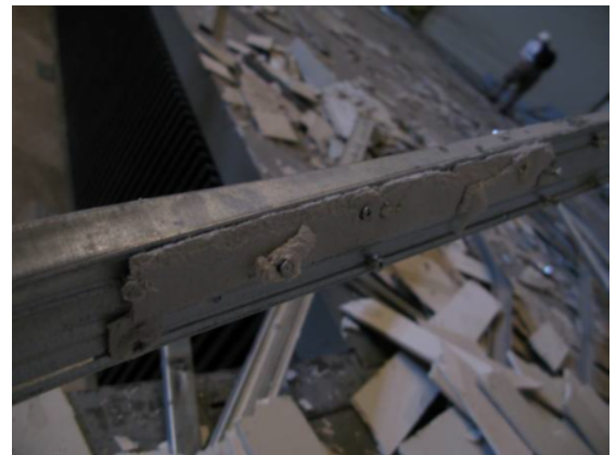
図-4.45 脱落したダブル野縁
