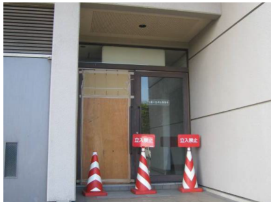
図-4.25 非常口の網入りガラスの破損
