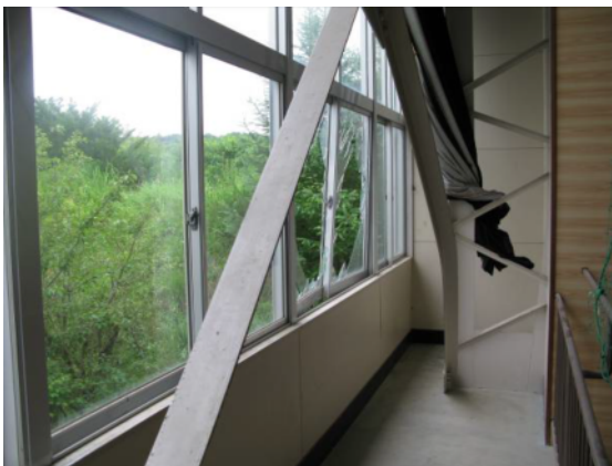
図-4.9 ブレースの座屈とガラスの破損
