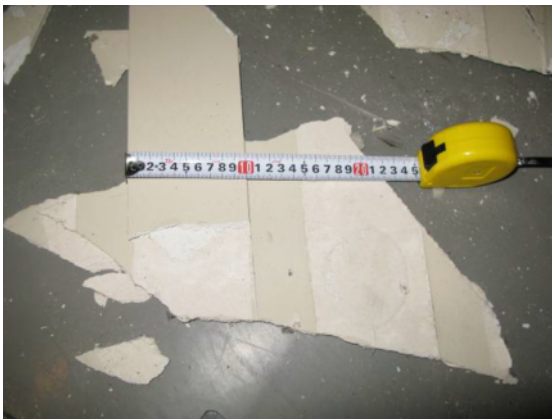
図-4.44 脱落した天井板
