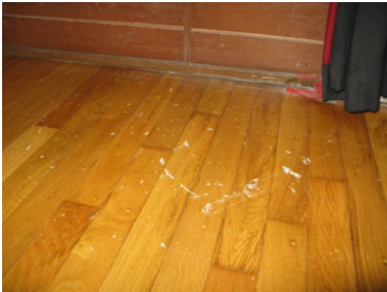
図-4.19 支承部コンクリート破片落下による床の傷痕
