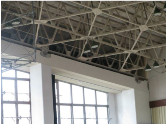
図-4.17 屋根支承部の損傷
