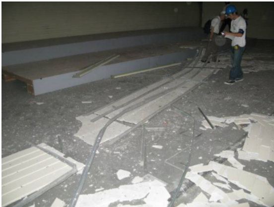
図-4.42 一体で脱落した天井板とダブル野縁
