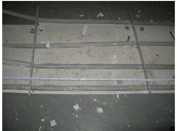
図-4.43 脱落した天井板とダブル野縁
