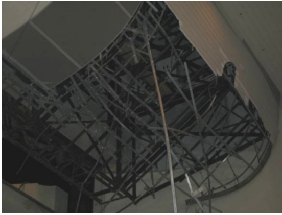
図-4.38 同部の舞台右側の損傷箇所
