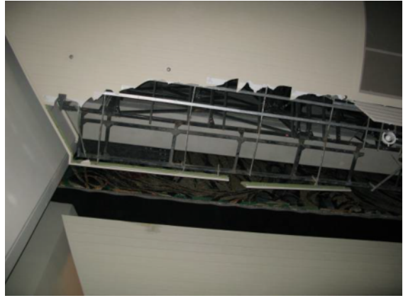
図-4.39 同部の舞台左側の損傷箇所
