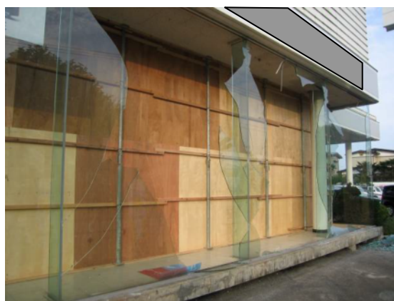
図-4.48 被害のあったガラス箇所
