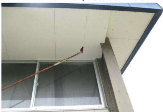
図-4.4 破損した軒天井
