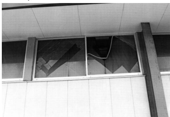
図-4.3 破損した窓ガラス（学校提供）
