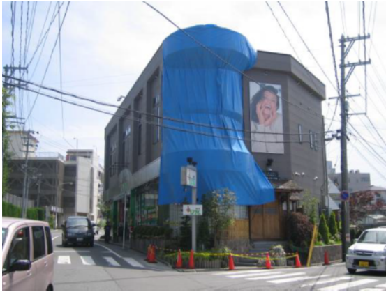
図-4.49 ガラスブロックが脱落した箇所
