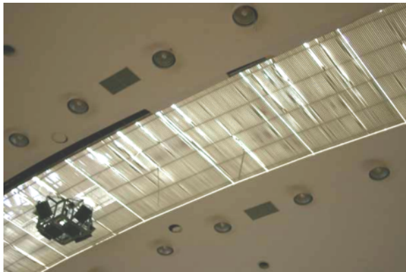
図-4.24 トップライト近傍での天井損傷状況
