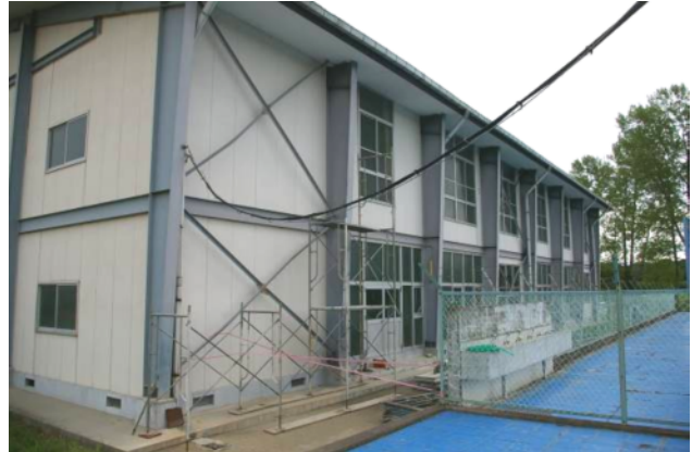
図-4.7 ブレースが座屈した東側桁行構面
