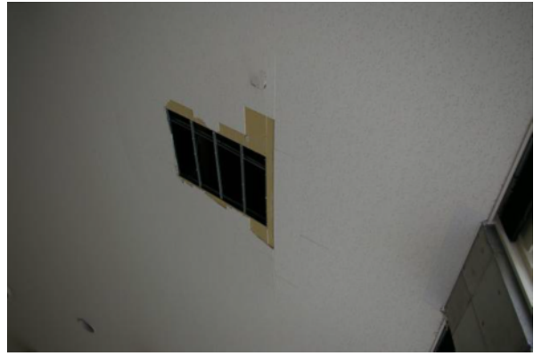
図-4.29 天井板脱落箇所
