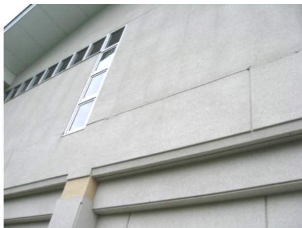
図-4.15 脱落部と反対側妻面の ALC パネル
