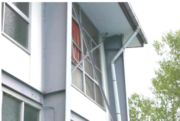
図-4.8 座屈したブレースと破損した窓ガラス
