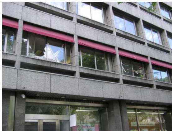
図-4.3 2階窓ガラスの被害状況（仙台市提供）
