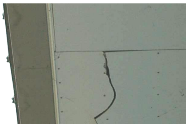
図-4.21 軒天の破損状況ととめ付け状況
