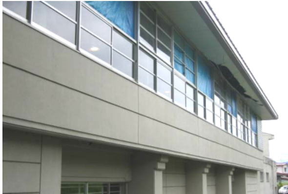
図-4.20 桁行方向の中程で損傷した軒天井
