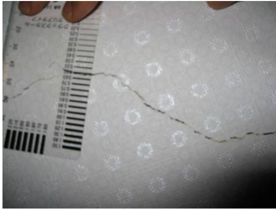
図-4.4 4階の内壁RC壁に見られた亀裂
