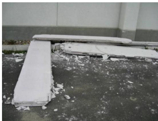
図-4.11 脱落した ALC パネル
