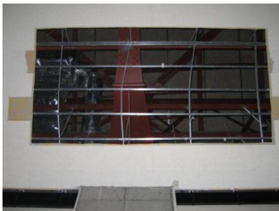
図-4.26 天井板脱落箇所と下地材損傷状況
