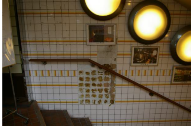
図-4.5 地下1階への階段で剥落したタイル
