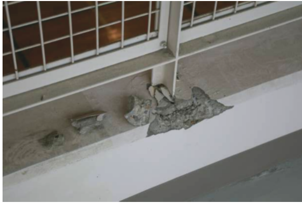
図-4.18 ギャラリー手すりの脚部の損傷
