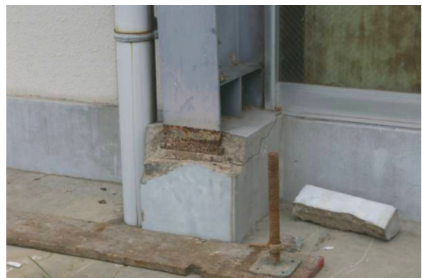
図-4.9 かぶりコンクリートが剥落した鉄骨柱脚
