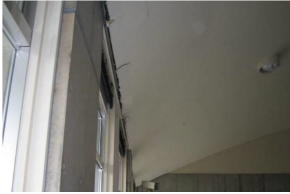
図-4.28 桁行方向の取り合いでの天井損傷状況
