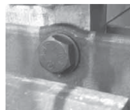
A5s : ボルト孔の 支圧によるのび
