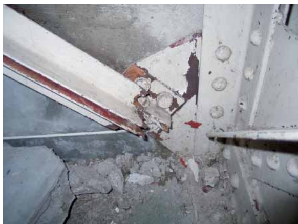
写真 6.3 既存ブレース接合部破断
