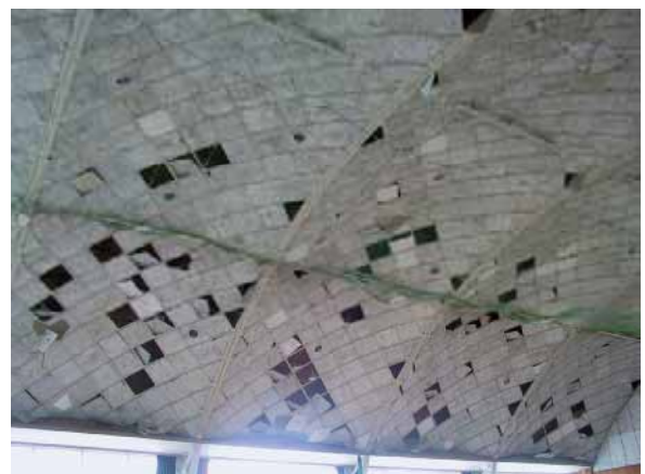
写真 6.4 天井木毛セメント板の落下
