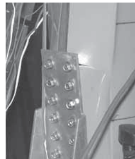
C3s : ホールダウン金物 接合部の破壊
