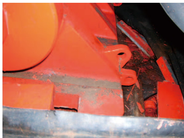
写真-7.5 可動支承のローラーの抜け出し
