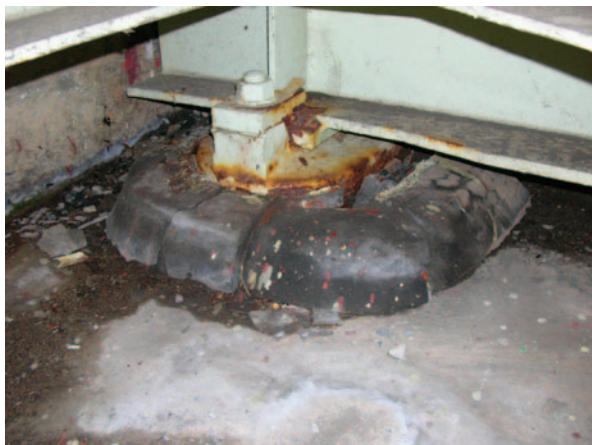
写真-7.33 沓座モルタルの破損
