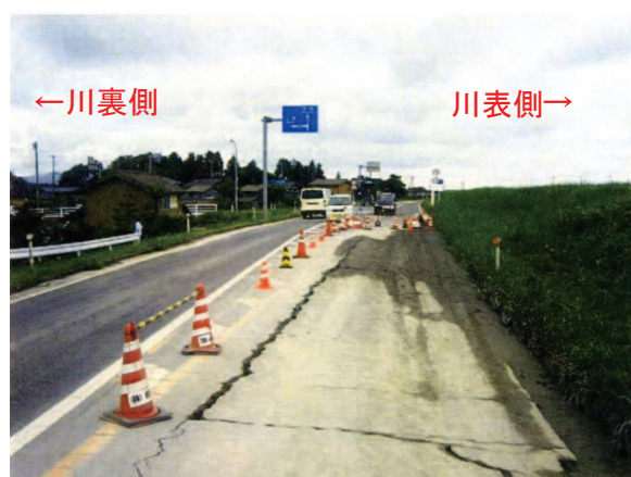
写真-5.1 信濃川本川 0kp 付近左岸堤防の裏小段に生じた縦断亀裂 (北陸地方整備局撮影)
