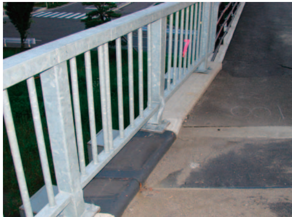
写真-7.21 高欄の座屈変形
