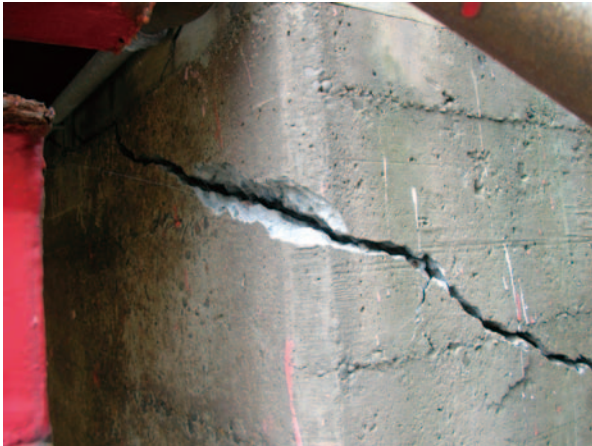
(a) パラペットのひびわれ
