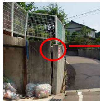
コンクリート擁壁のはらみ
