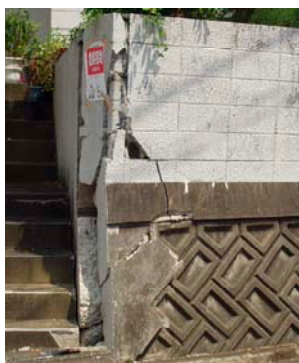
擁壁隅部の破壊
