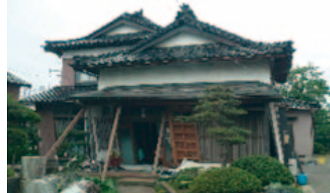
写真-9.4.13 大破した比較的古い構法による住宅
