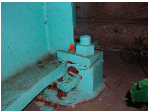
写真-7.36 支承部の振動の痕跡
