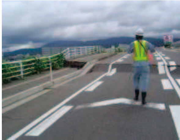
写真-7.35 ボックスカルバート背面土の沈下（北陸地方整備局ホームページより引用）
