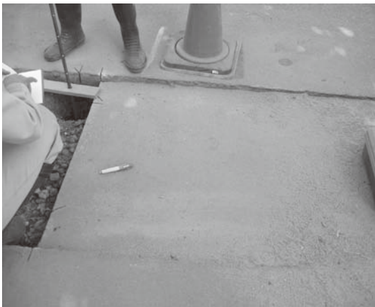
写真-4.15 A都市の管渠被災状況
