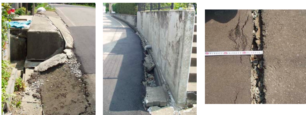
写真-9.7.3 南半田地区で認められた外周道路等での地盤変動・滑動等
