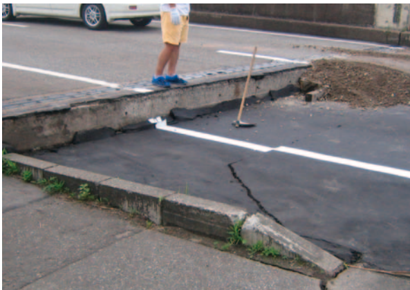
写真-7.38 和田橋の橋台背面土の沈下 (北陸地方整備局のホームページより引用)
