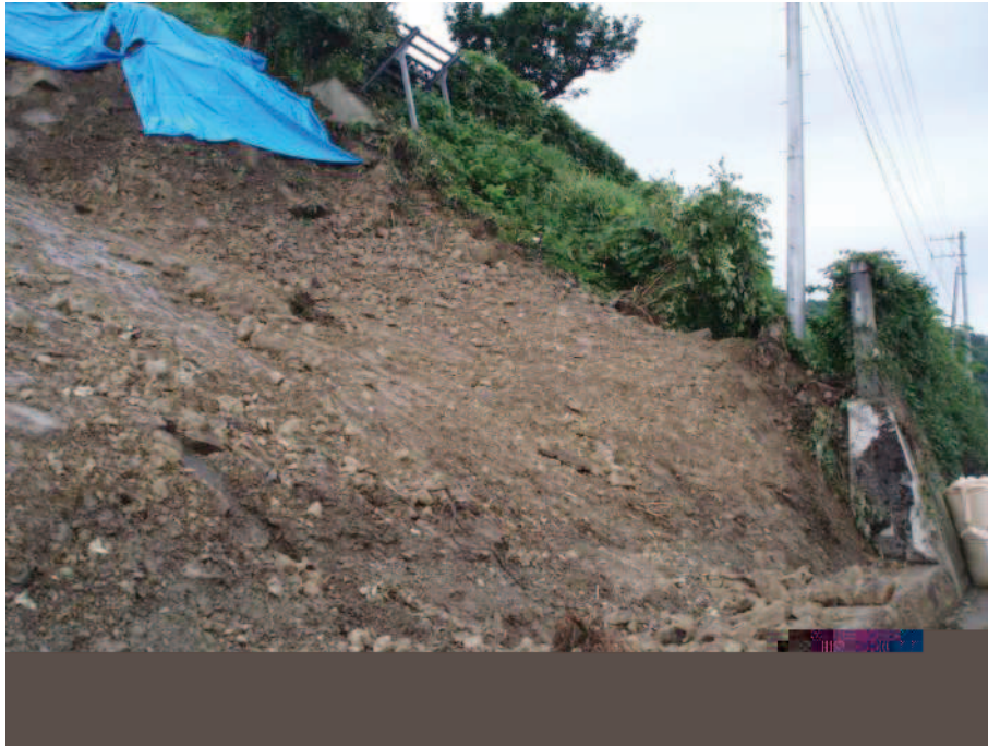
写真-8.3.26 岩盤崩壊箇所（斜面 B）末端部の状況
