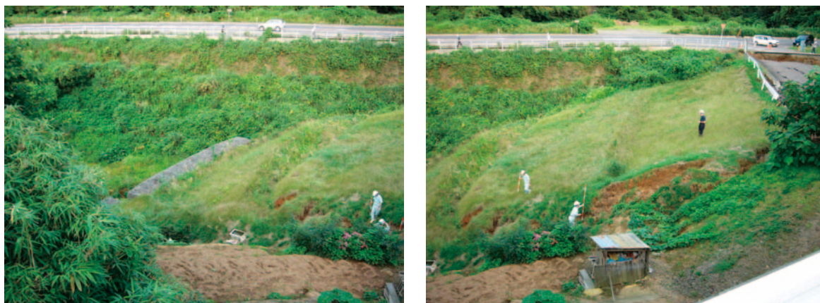
(b) 盛土のり面変状状況
