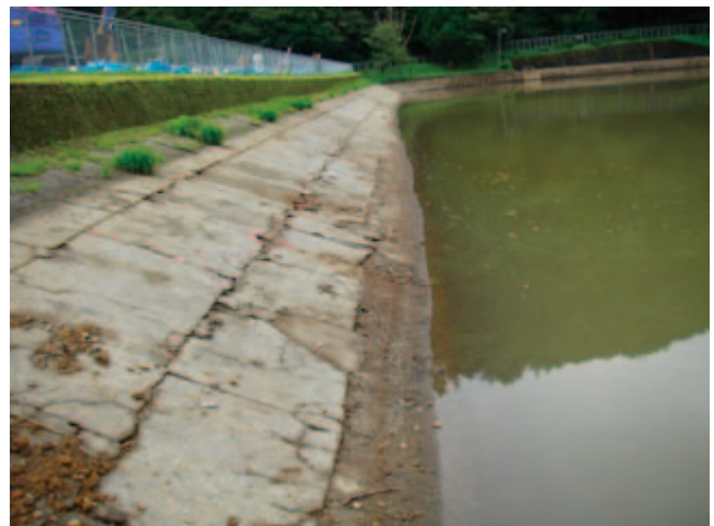
写真-6.10 堤体上流面の張コンクリートブロッ ク（上流張ブロックの隙間から堤体 材料の吸出しが見られる）
