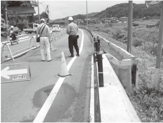
写真-4.6 道路盛土の変状による地盤変形 (出雲崎町川西)
