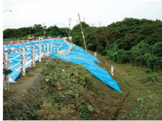
(b) 盛土のり面の被災状況
