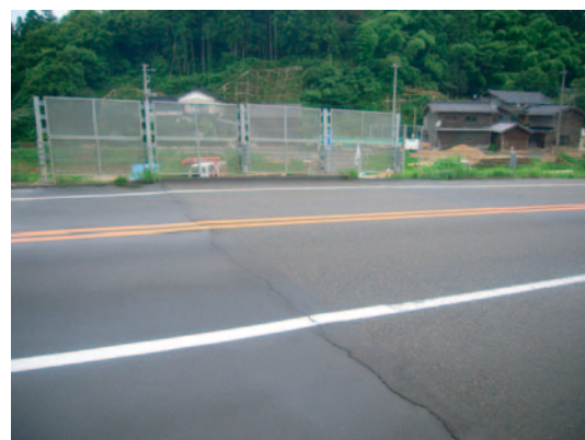
(b) カルバート箇所の上の横断クラック
