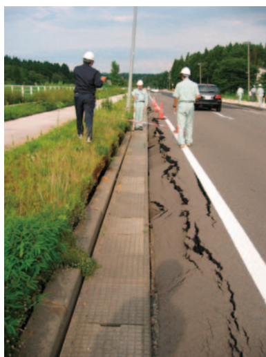
(a) 側溝の沈下
