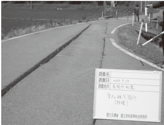
写真-4.3 埋戻し部沈下 (長岡市和島)
