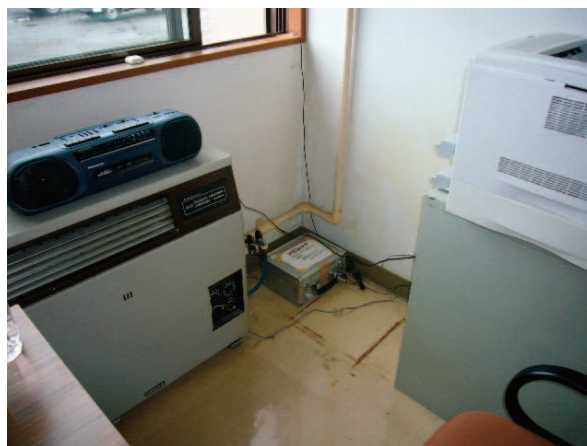
写真-9.3.8 西山町事務所 1F 設置状況
