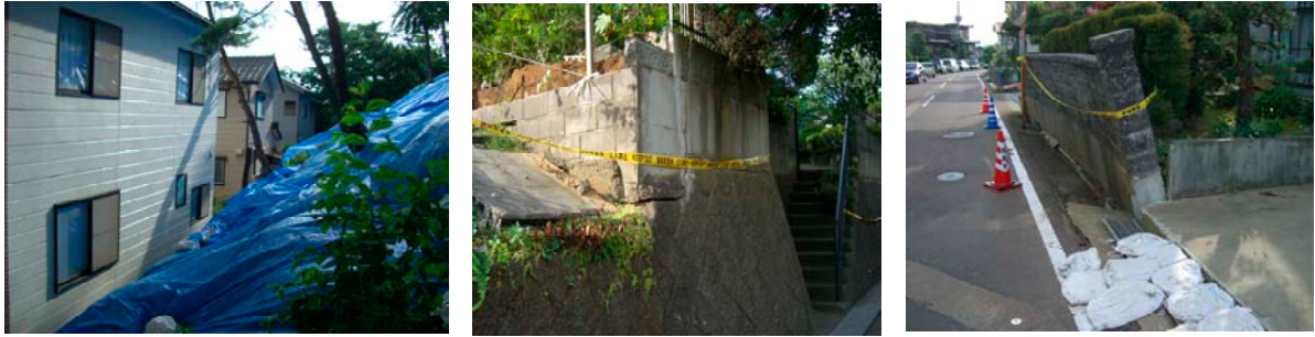
写真-9.7.17 山本団地における擁壁の被害例
