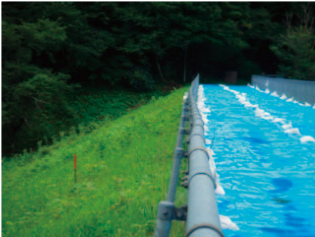
写真-6.7 地震後の天端欄干手すりの状況 （下流側への変形）（2007.7.17 撮影）
