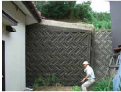
(地震直後にほぼ鉛直に起き上がり、数日後に転倒状態に達し、背面住宅にもたれかかった例)
