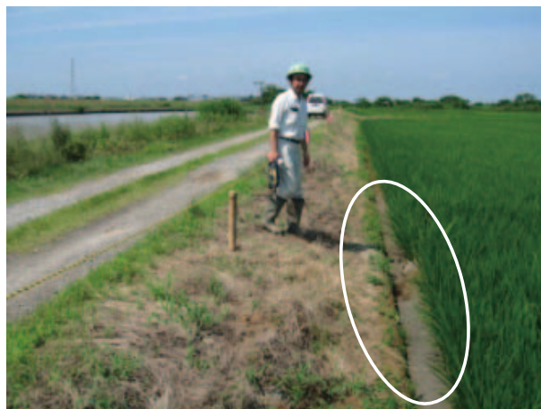
写真-5.8 管理用通路脇の耕作地に生じた噴砂（下流側から上流側を望む）
