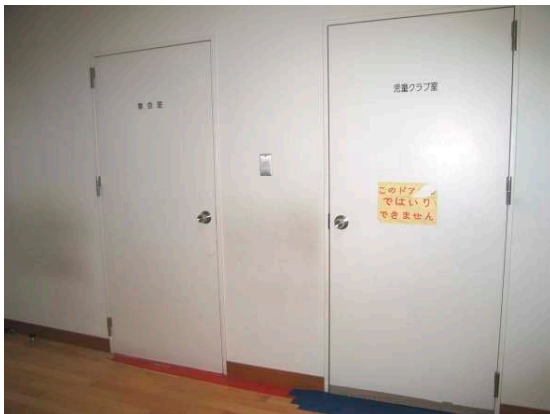
写真-9.6.7 開扉に支障を来した防火扉
