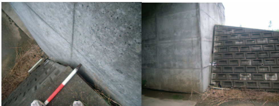
(c) カルバートと擁壁の隙間 (常時での変状跡)
