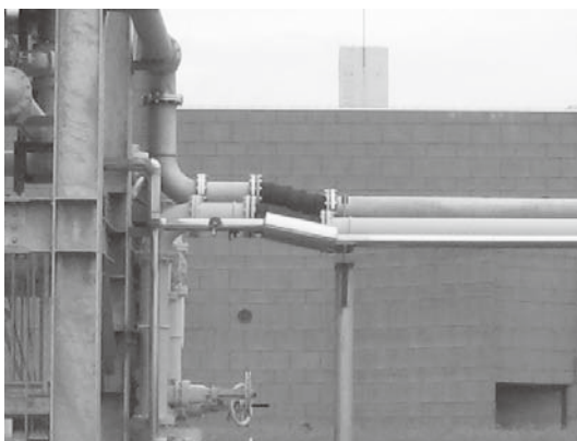
写真-4.13 柏崎市浄化センター 伸縮継手部
