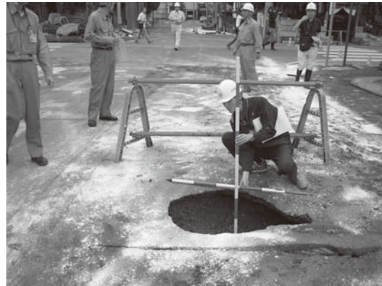
写真-4.9 柳橋ポンプ場圧送管破断
