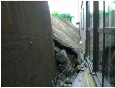
写真-9.7.12 モルタル吹き 付け壁面の崩壊
