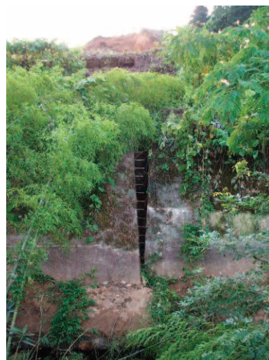
写真-8.3.7 路肩擁壁の変状
