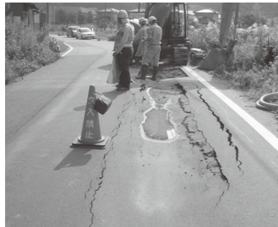
写真-4.16 B都市の管渠被災状況
