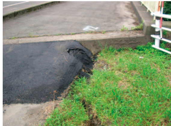
写真-7.39 田沢川橋台背面土の沈下
