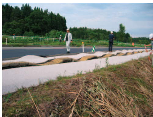
(b) 歩道の変状状況
