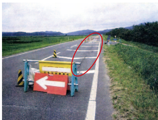
写真-5.4 大河津分水路 2kp 付近右岸における堤防天端の縦断亀裂（上流側から下流側を望む）（北陸地方整備局撮影）
