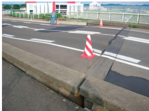
写真-7.34 跨線橋橋台背面土の沈下
