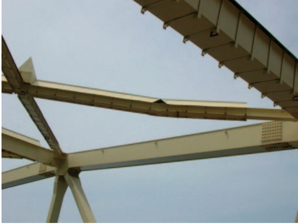
写真-7.2 上横構の座屈変形
