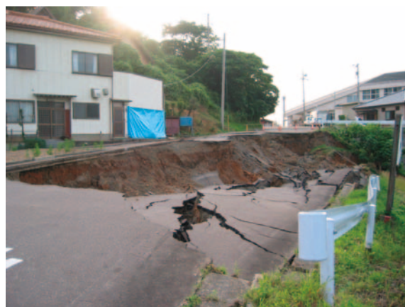
(a) 路面崩落状況
