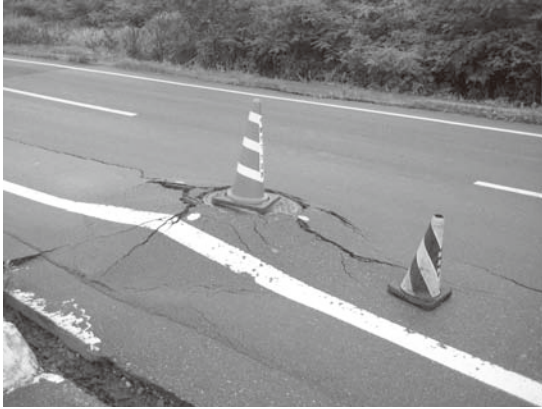
写真-4.1 マンホール隆起 (柏崎市栄町)
