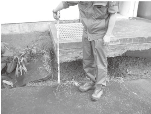
写真-4.8 八坂ポンプ場地盤沈下
