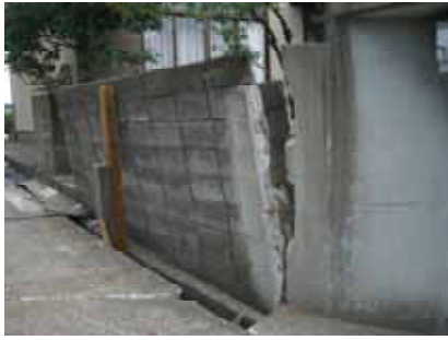
写真-9.7.4 ブロック塀による土留め擁壁の崩壊
