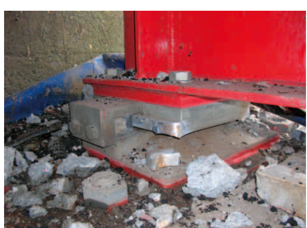
写真-7.12 2径間部の固定支承における固定突起の損傷
