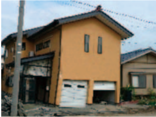
写真-9.4.19 地盤変状により大きな被害を受けた比較的新しい木造住宅
