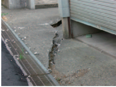
写真-9.7.19 日吉小学校周辺の道路沿いで生じた段差による住宅の沈下障害による被害例
