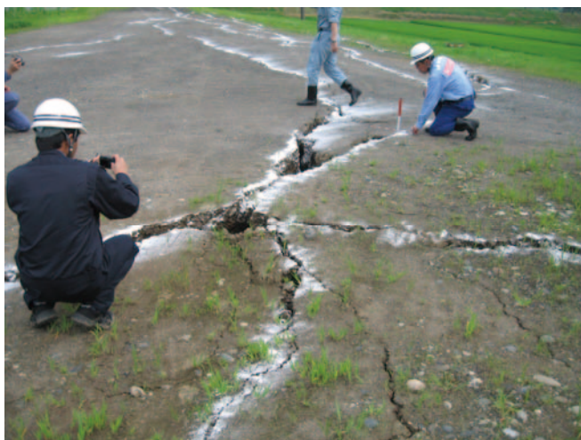
写真-5.13 鯖石川藤井堰上流 9.4kp 付近左岸の堤防天端に生じた縦断亀裂（下流側から上流側を望む）
