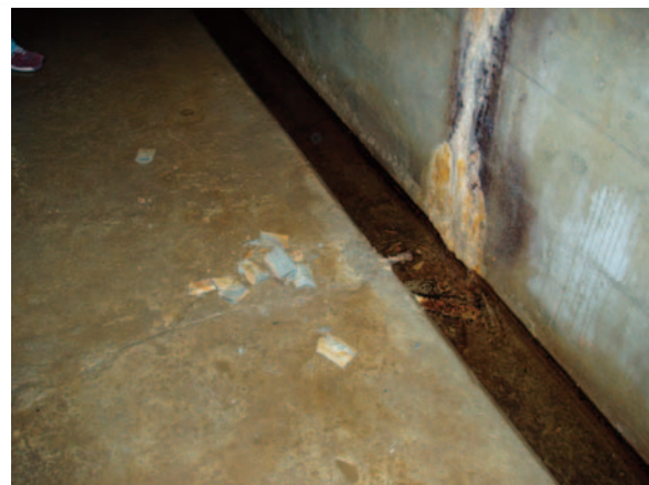
写真-6.3 鯖石川ダム監査廊内継目 J7 遊離石灰剥落状況
