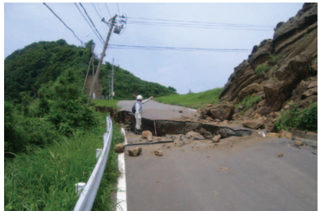
写真-3.14 市道に生じた段差(7月19日撮影)
