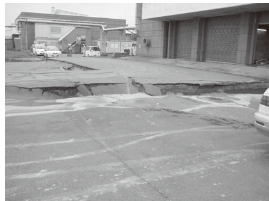
写真-4.12 柏崎市浄化センター 汚泥棟周辺の地盤沈下
