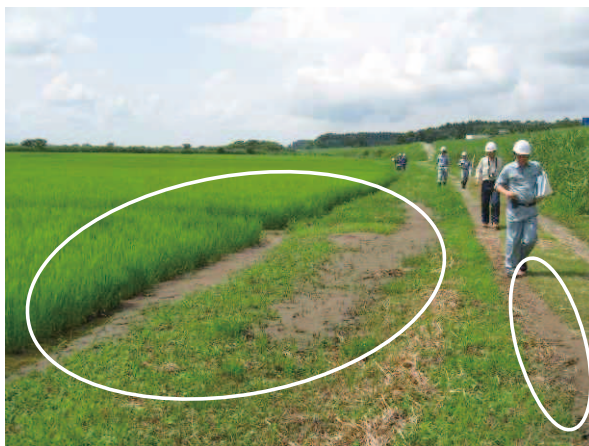
写真-5.2 信濃川本川 0kp 付近左岸堤防の川表側のり尻付近に生じた噴砂（下流側から上流側を望む）
