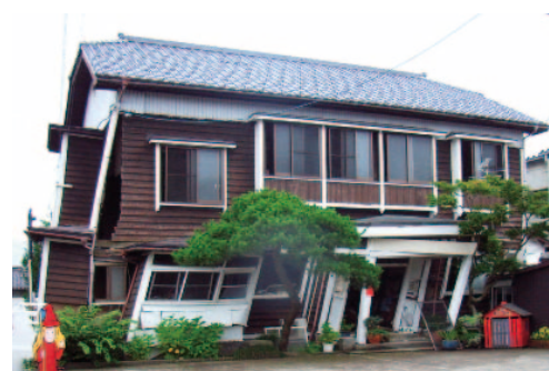
写真-9.4.4 残留変形が大きい総 2 階の比較的立派な造りの木造
