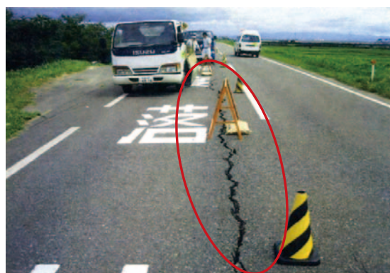
写真-5.5 大河津分水路 2kp 付近右岸における堤防天端の縦断亀裂（下流側から上流側を望む）（北陸地方整備局撮影）
