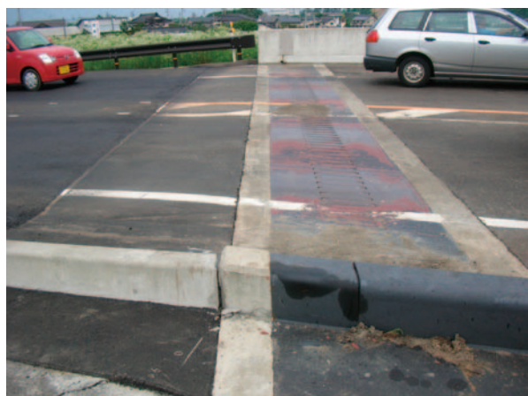
写真-7.19 伸縮装置の遊間のつまりと 背面土の沈下による段差補修
