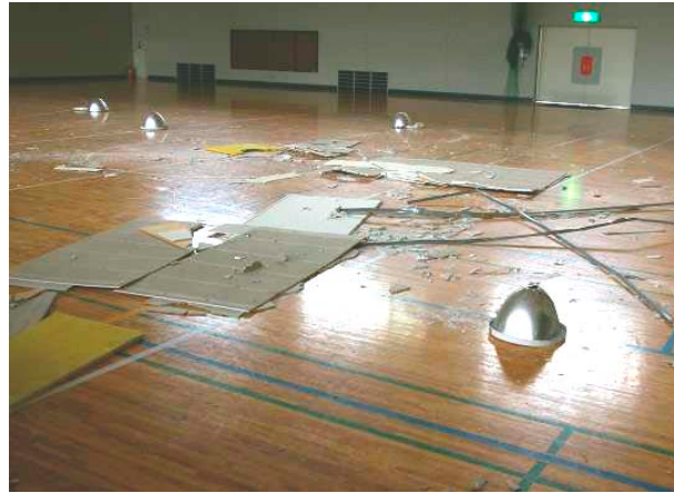
写真-9.6.6 脱落した様々な部材
