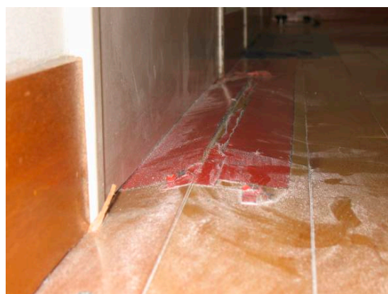
写真-9.6.8 床仕上材のせり上がり
