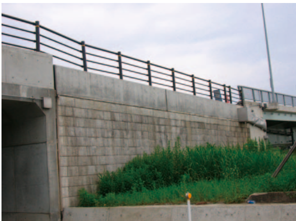
写真-7.20 橋とボックスカルバート間の盛土の沈下
