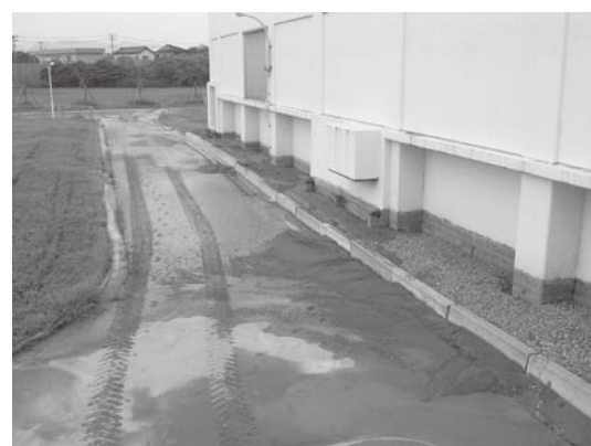
写真-4.14 柏崎市浄化センター 噴砂の状況
