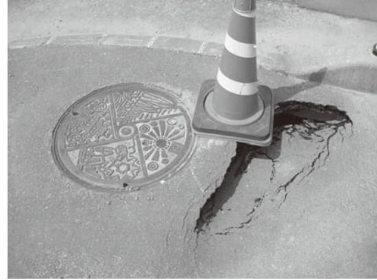
写真-4.2 マンホール周辺沈下・陥没 (長岡市大積)
