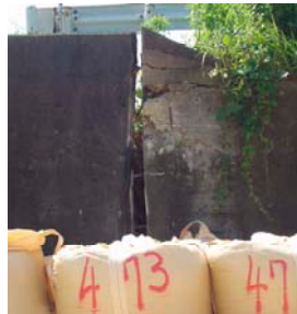
接合部右側擁壁のはらみ
