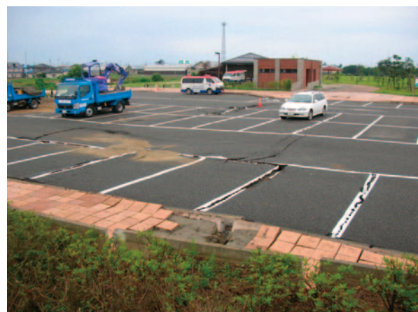
写真-7.28 隣接する公園駐車場の液状化による路面のうねり
