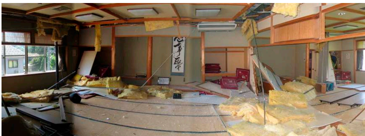
写真-9.6.9 二階和室内部被害状況（パノラマ合成）
