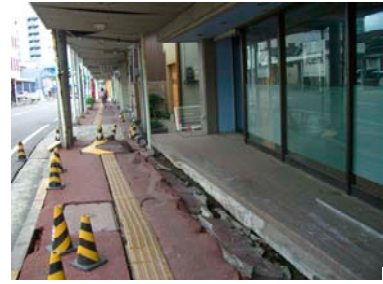
写真-9.7.21 杭基礎建物の被害
