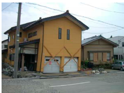
写真-9.7.1 柏崎市松波地区の液状化被害
