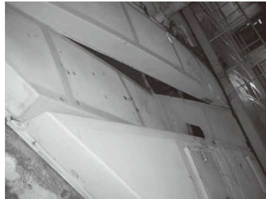
写真-4.10 柏崎市浄化センター 最初沈殿池覆蓋脱落
