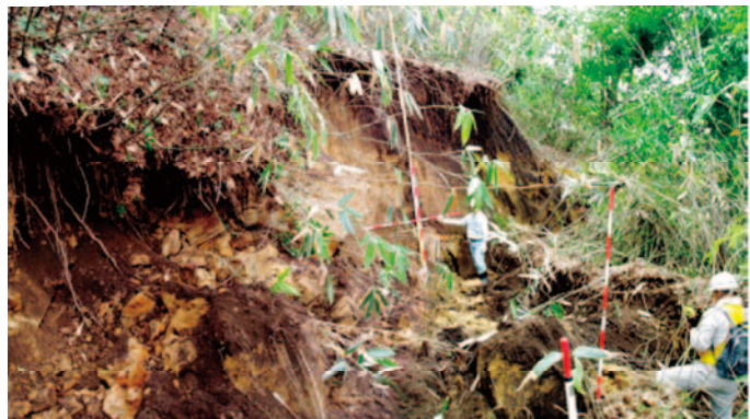
写真-8.3.14 地すべりブロック中部の陥没帯（長岡国道事務所（2007）による）
