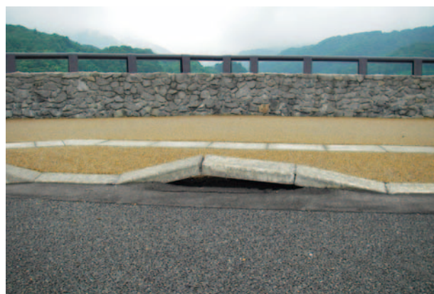
写真-6.2 天端中央の歩道縁石の浮き上がり
