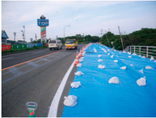
(a) 路面の被災状況
