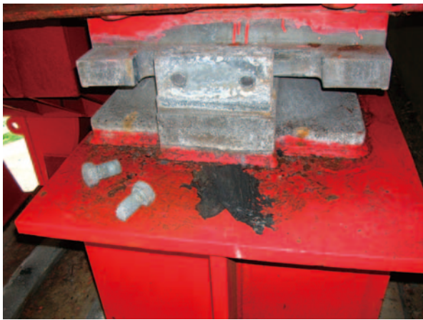
(a) アップリフト止めの損傷
