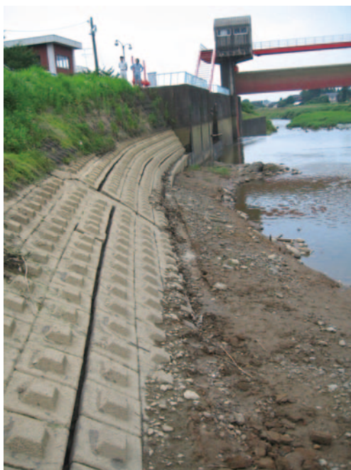
写真-5.14 鯖石川藤井堰上流 9.4kp 付近左岸における表のり護岸のはらみ出しおよび開き（上流側から下流側を望む）
