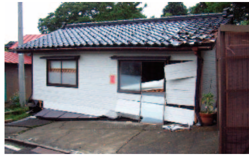
写真-9.4.26 比較的新しい構法で倒壊した1階を車庫、又は倉庫等にした家屋
