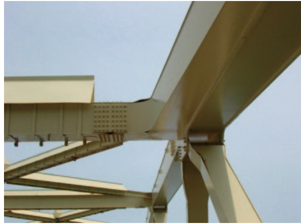
写真-7.3 橋門構隅角部の溶接部の座屈変形、割れ
