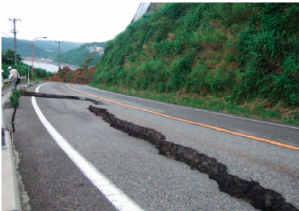
写真-8.3.21 国道路面の段差亀裂
