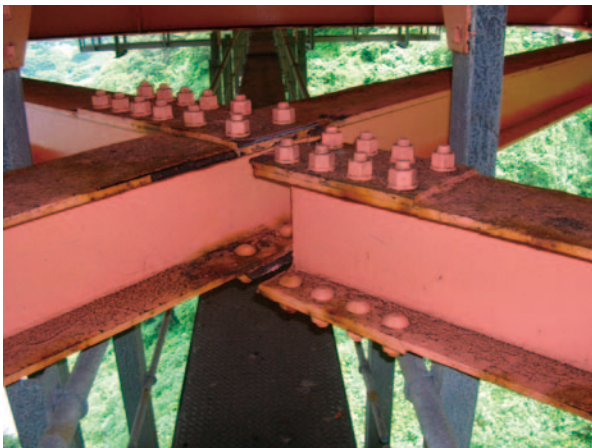
写真-7.4 下横構連結板の破断
