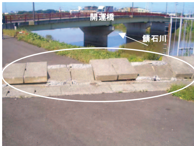
写真-5.10 鯖石川 2kp 付近左岸の水道管路上部コンクリート版の浮き上がり（上流側から下流側を望む）
