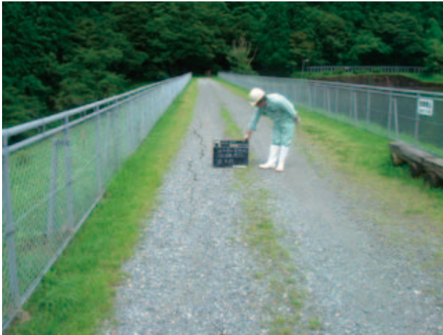
写真-6.5 天端のクラック（左岸側より） 地震直後（2007.7.16 撮影）（柏崎市提供）
