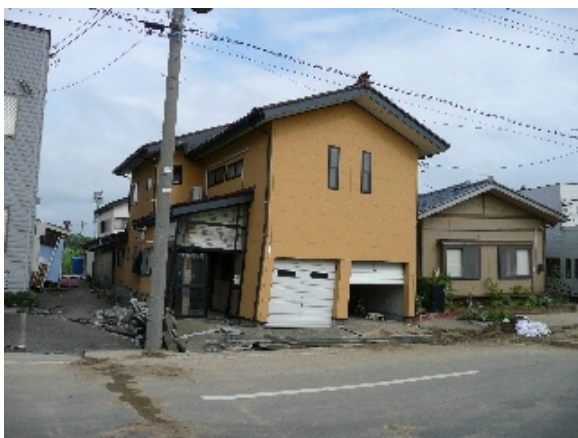
写真-4.2.53 地盤変状により大きな被害を受けた木造住宅
