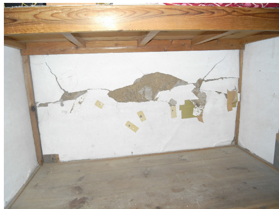
写真-4.3.17 内壁のひび割れ
