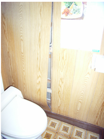
写真-4.3.4 内壁面材の座屈
