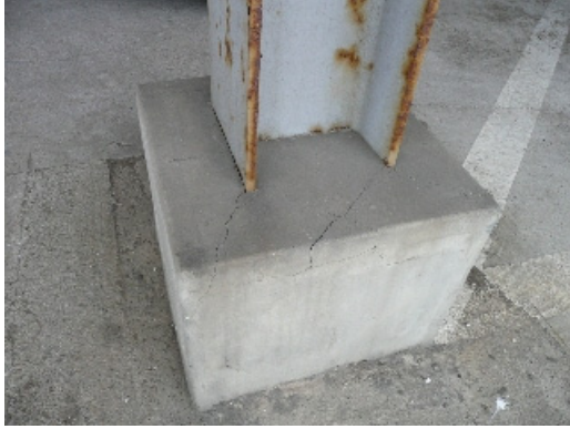
写真-4.2.40 柱脚コンクリートのひび割れ
