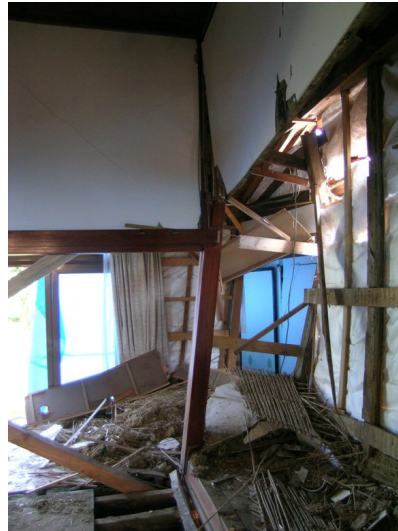
写真-4.3.58 柱折損の詳細
