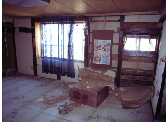
写真-4.3.54 土壁の崩落
