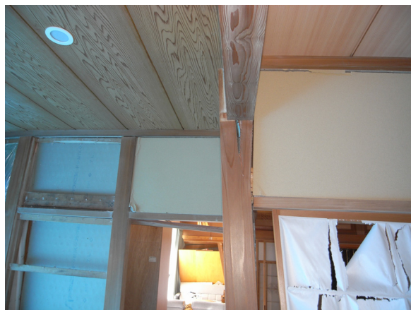
写真-4.3.71 縦に裂けた柱
