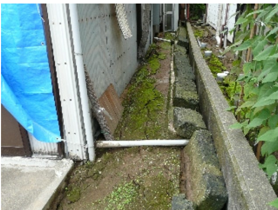
写真-4.3.10 低い擁壁の被害
