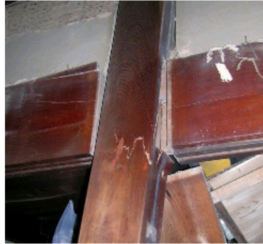
写真-4.3.42 柱の折損（写真-4.3.41 の拡大）
