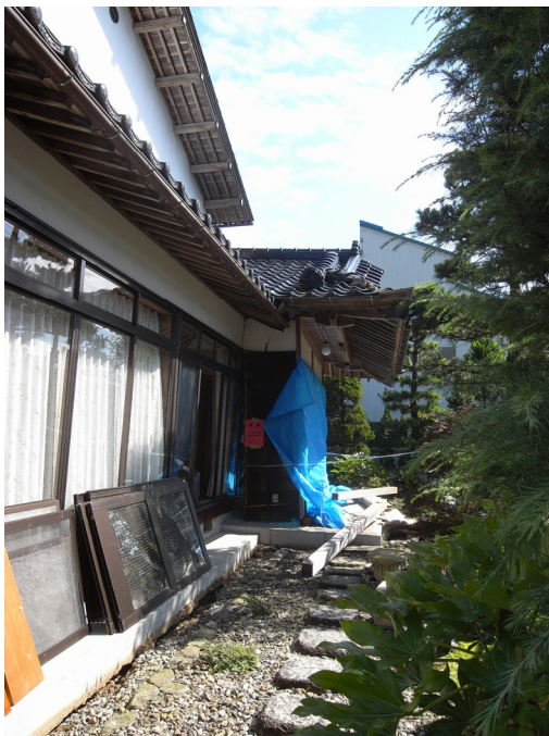
写真-4.3.66 脱落した独立柱と傾斜した玄関
