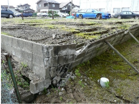
写真-4.2.43 駐車場地面のひび割れと擁壁の崩壊
