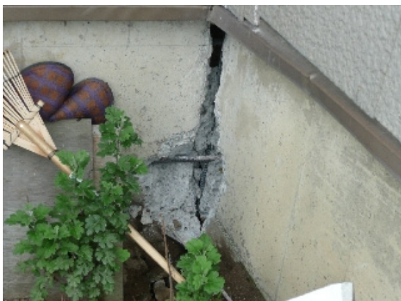
写真-4.2.59 写真-4.2.57 の建物の破壊された基礎
