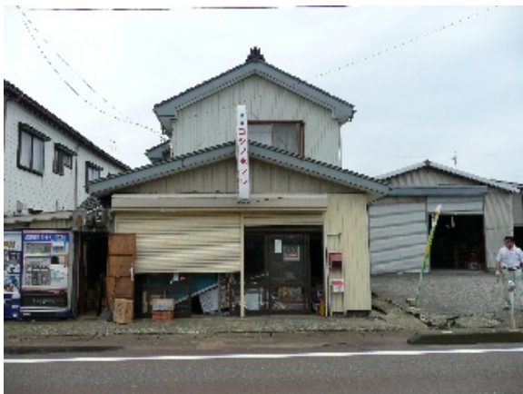
写真-4.2.23 地盤変状により被害を受けた 店舗併用住宅建て
