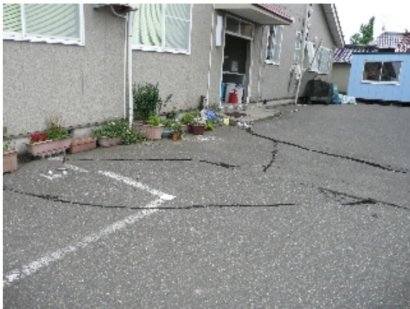
写真-4.2.45 写真-4.2.38の北北東へ続くひび割れ
