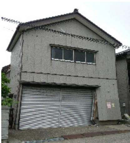
写真-4.2.41 1階が大きく傾いた車庫
