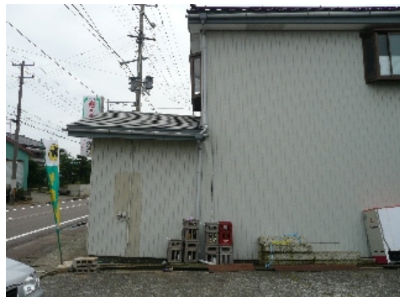
写真-4.2.24 写真-4.2.23 の側面（平屋と2階 部分の境界付近が不同沈下）
