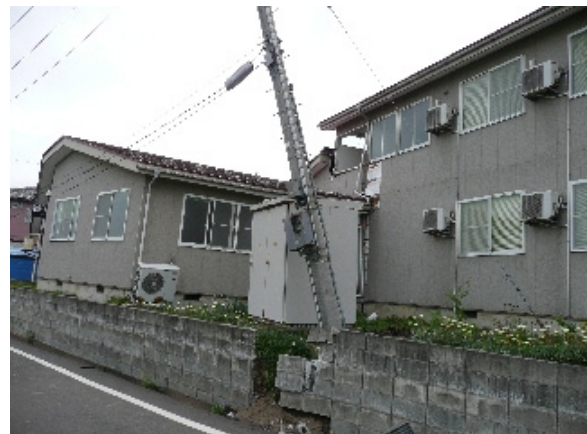
写真-4.2.60 写真-4.2.57 の建物の敷地の擁壁の崩壊
