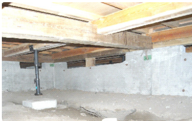
写真-4.3.69 床下（束が浮き上がっている）
