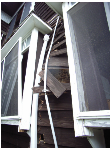
写真-4.3.26 筋かいの座屈
