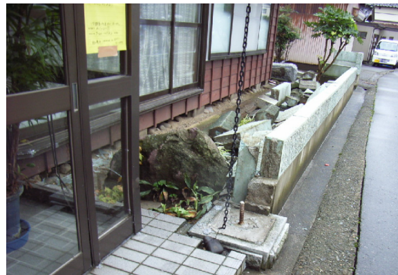
写真-4.3.15 門柱の鉄筋と石塀の倒壊
