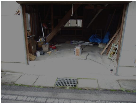
写真-4.2.7 写真-4.2.6の土間コンのひび割れ
