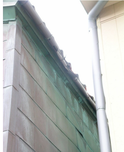
写真-4.3.38 隣家との衝突痕
