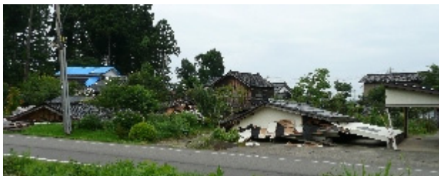
写真-4.2.17 多くの車庫、倉庫が倒壊
