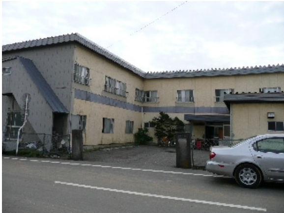
写真-4.2.55 一部損壊（裏手部分）した軽量鉄骨造
