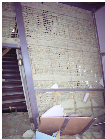
写真-4.3.27 壁土の剥落
