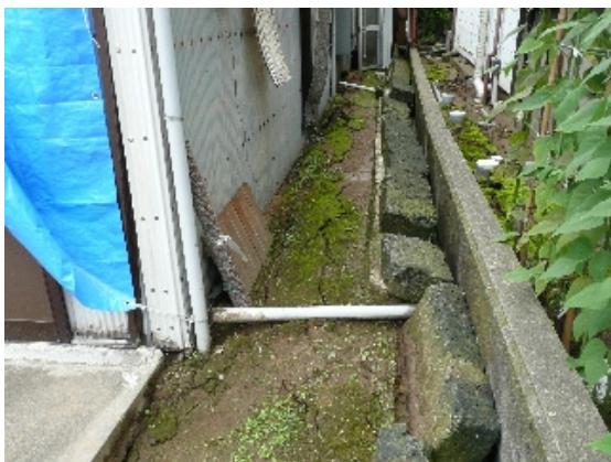
写真-4.2.26 写真-4.2.23 の敷地の変状
