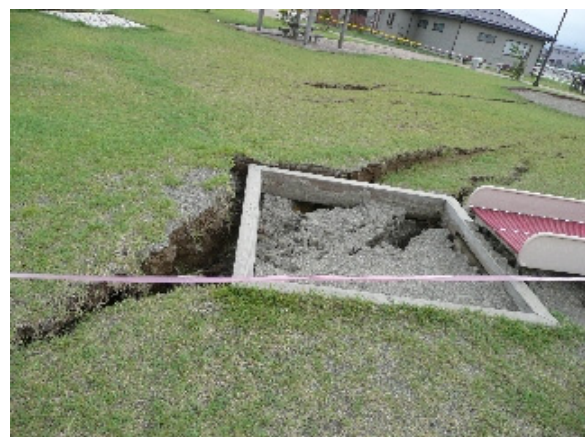
写真-4.2.48 鯖石川記念公園の遊具施設を 貫く地面のひび割れ
