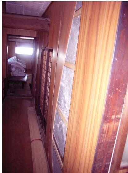
写真-4. 3. 52 内装合板の座屈
