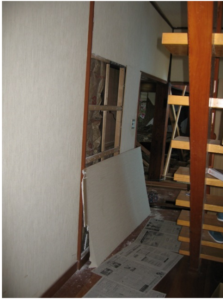
写真-4.3.61 増築部分の廊下の せっこうボード剥落
