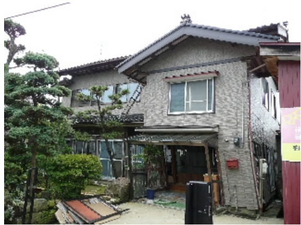
写真-4.2.20 残留変形が大きい住宅
