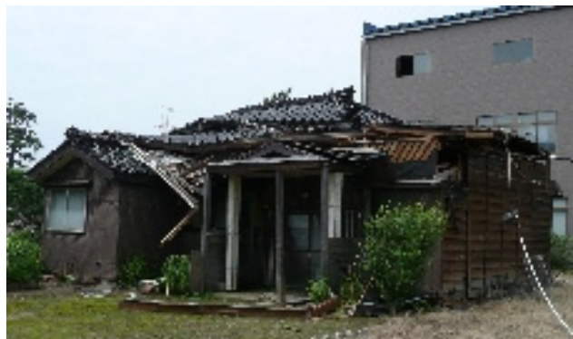
写真-4. 2. 30 2階が崩壊した例
