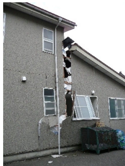
写真-4.2.58 写真-4.2.57 の下屋部分の継ぎ目部の破壊
