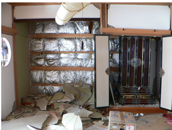
写真-4.3.70 脱落した石こうボード
