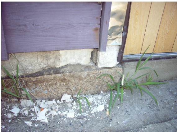
写真-4. 3. 51 道路側の切石基礎の割れ
