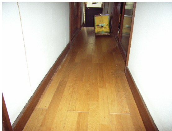
写真-4.3.5 床の傾斜と内壁のひび割れ
