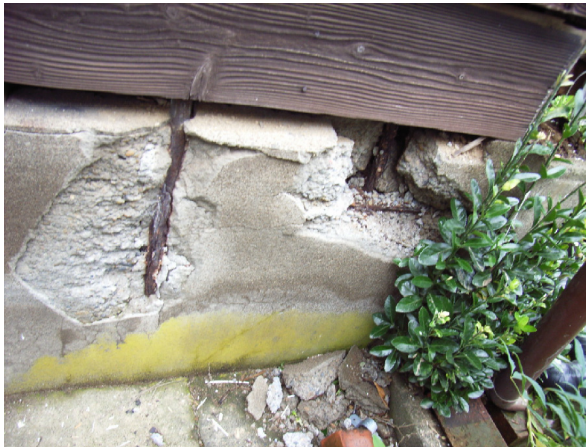
写真-4.3.24 基礎のひび割れ
