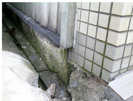
写真-4.3.36 切石基礎の転倒・移動
