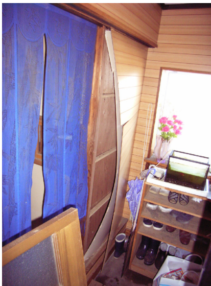
写真-4.3.48 内装合板の座屈
