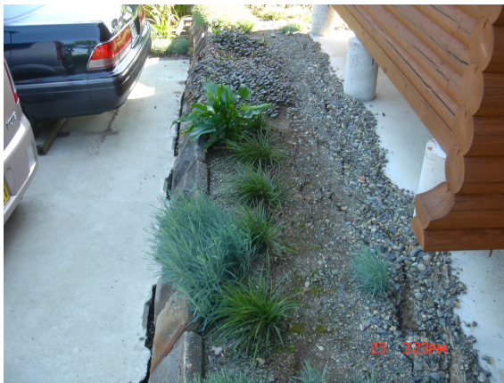
写真-4.3.71 スラブと周辺地盤のずれ
