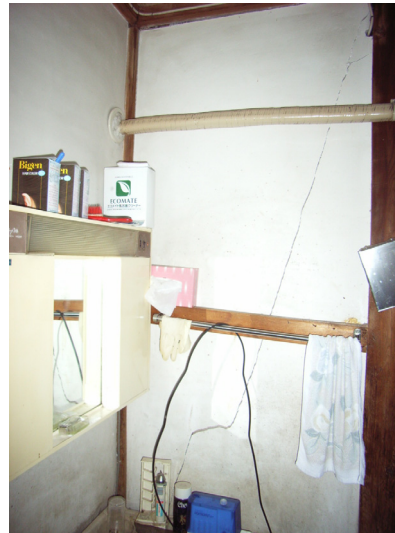
写真-4.3.13 内壁のひび割れ
