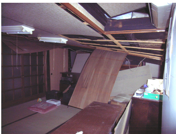
写真-4.3.45 落ちた天井
