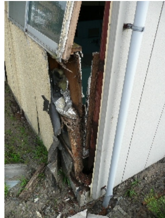
写真-4.2.56 写真-4.2.55 の裏側の被害
