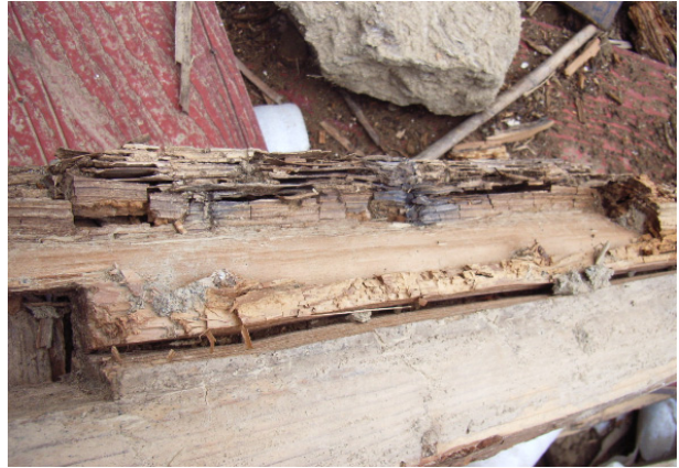
写真-4.2.16 写真-4.2.15の建物の部材の腐朽・蟻害
