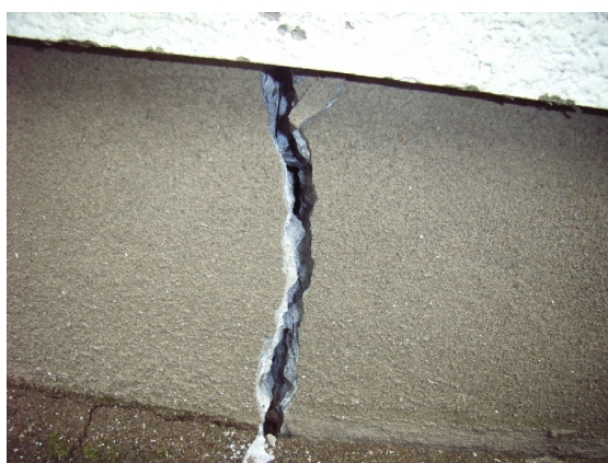
写真-4.3.7 基礎のひび割れ
