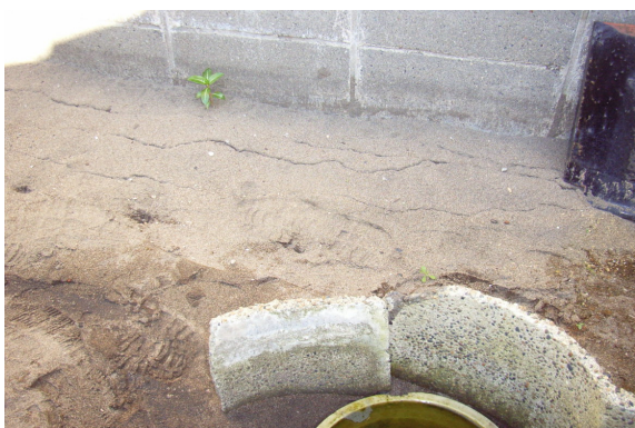
写真-4.3.47 庭の砂のひび割れ
