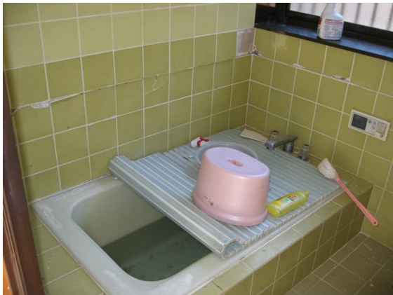
写真-4.3.63 浴室タイル目地亀裂・剥落
