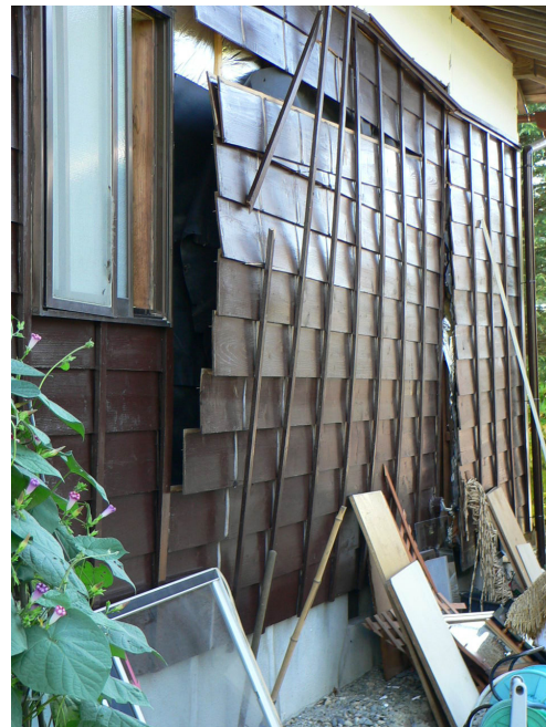
写真-4.3.67 座屈した筋かいにより押し出された外装材
