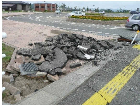
写真-4.2.46 鯖石川記念公園駐車場へ続く 地面のひび割れ
