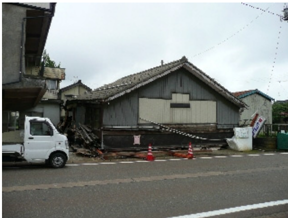
写真-4.2.36 倒壊した店舗併用住宅
