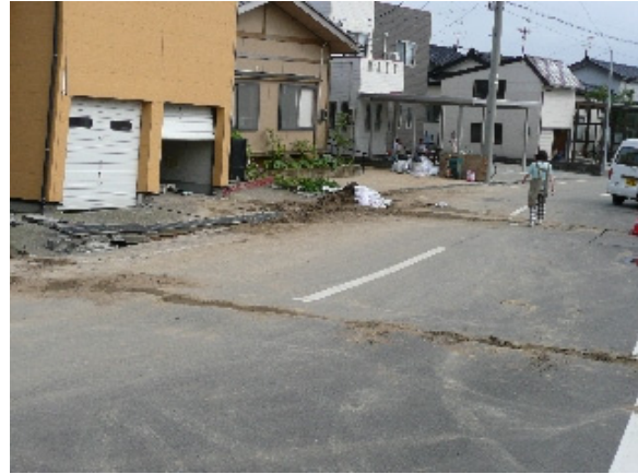
写真-4.2.44 アスファルトを貫くひび割れ (写真-4.2.37の北東方向)
