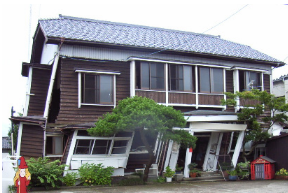
写真-4.2.13 残留変形が大きい総2階の木造
