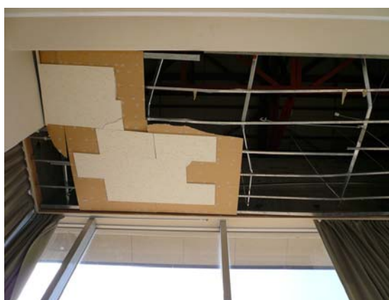
写真-7.3 捨て張り工法による天井の被害 (加賀市役所提供)
