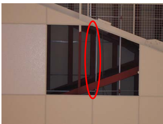
写真-7.2 クロスTバーがない箇所 (床面から見上げた様子)
