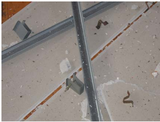
写真-7.15 落下した様々な部材
