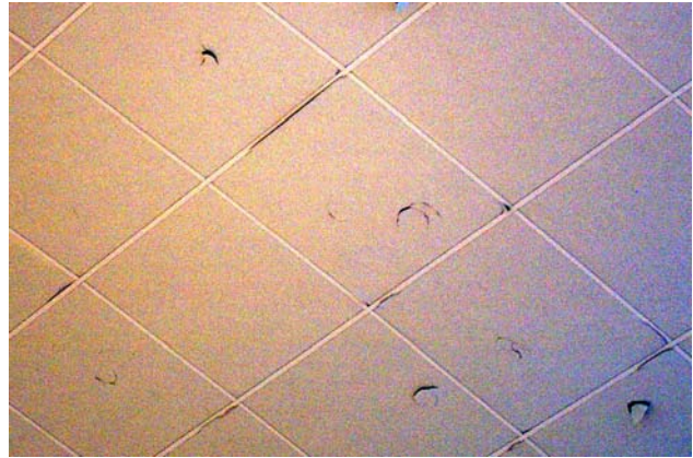
写真-7.31 天井のグラスウールボードの様子
