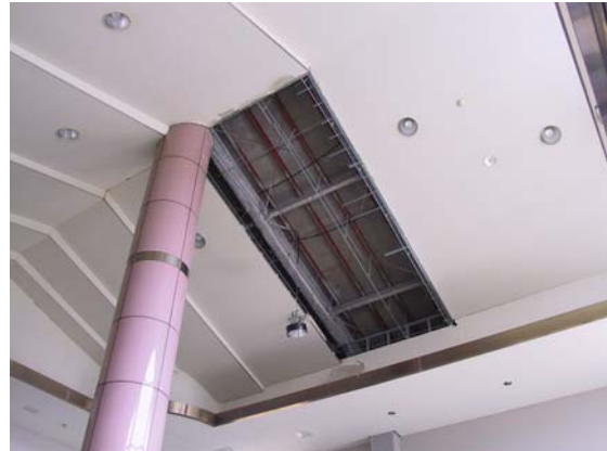
写真-7.40 エントランスホールの天井の被害
