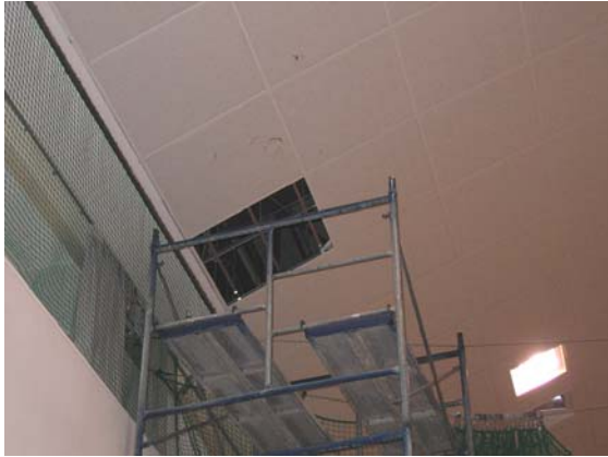
写真-7.30 グラスウールボードが脱落した箇所
