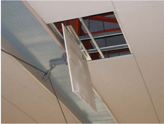
写真-7.24 脱落しかけた天井材
