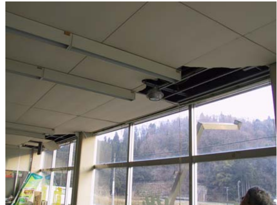
写真-7.36 端部でのせっこうボードの破損
