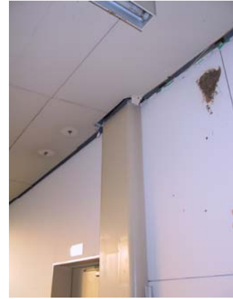
写真-7.38 天井と壁面のすきま
