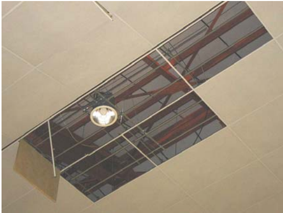
写真-7.8 照明機器周辺における天井の被害
