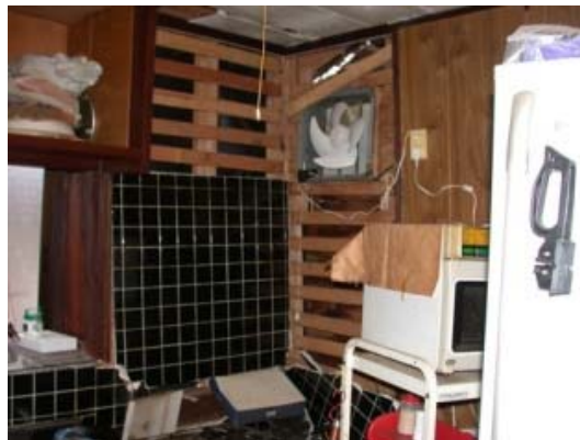
写真-4.125 台所の壁の被害
