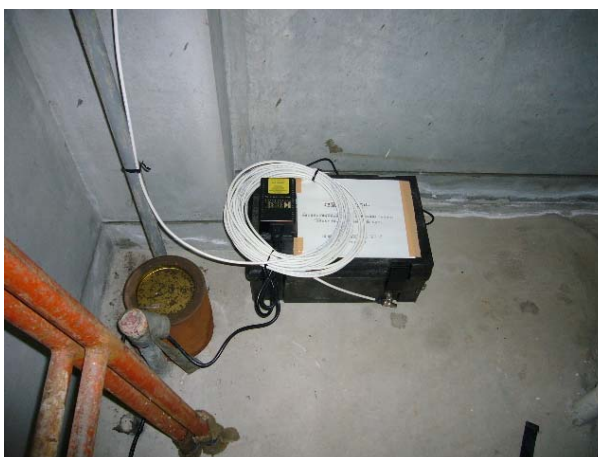
写真-3.3 輪島市役所 1階強震計設置状況
