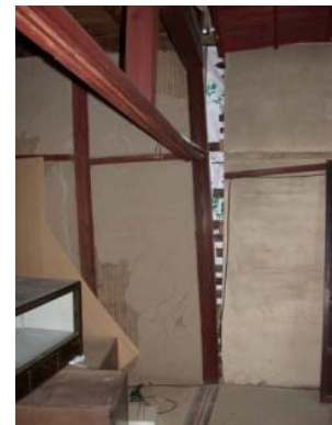
写真-4.128 梁の抜け出し
