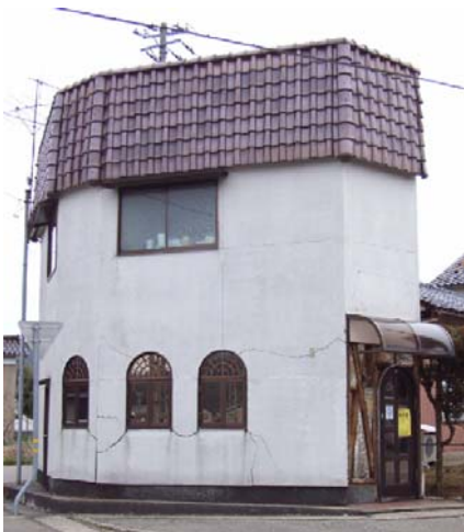
写真-4.47 躯体の腐朽が確認された店舗
