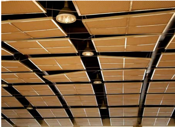
写真-7.18 被害を受けた天井の様子
