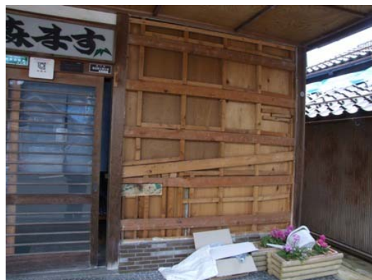
写真-4.95 外壁仕上げ材の剥落
