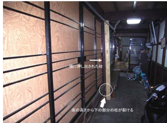
写真-4.67 床から下が折れた柱
