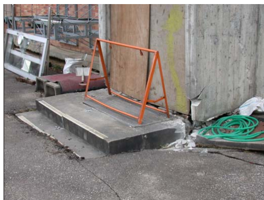
写真-6.15 建物周辺部の液状化被害
