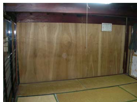
写真-4.69 梁 (差鴨居) の抜け出し
