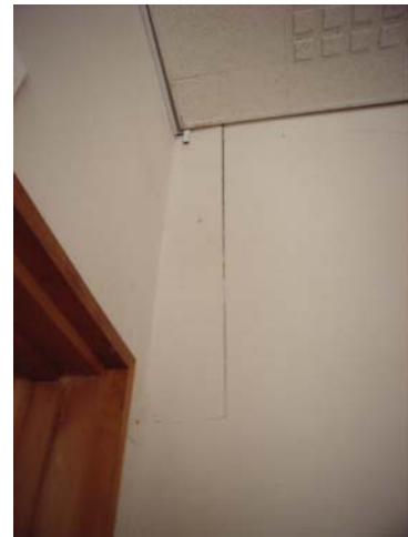
写真-4.166 ビニル壁紙の亀裂
