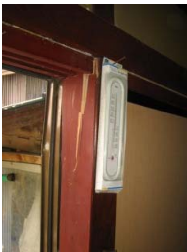
写真-4.88 柱の割裂
