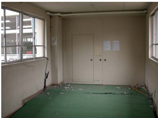
写真-6.11 校舎と講堂の渡り廊の被害
