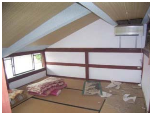
写真-4.121 2階の被害（壁の落下）
