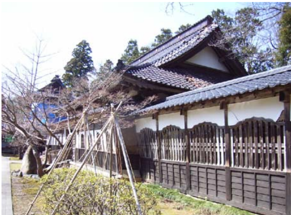
写真-4.19 被害が大きい山門左奥の建物
