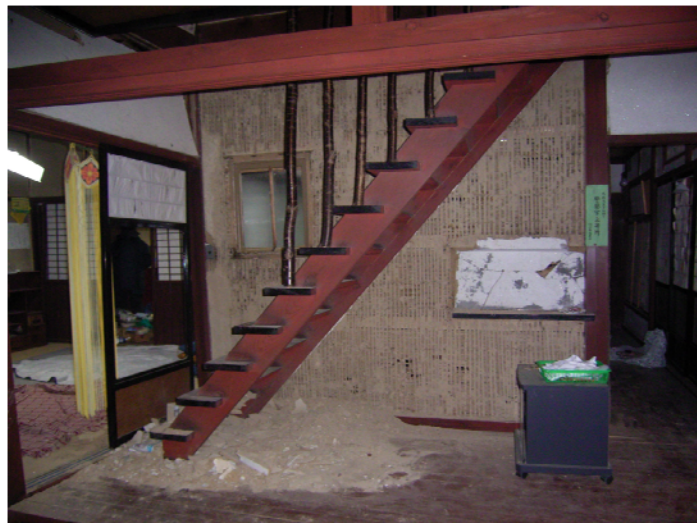
写真-4.130 土塗壁の剥落
