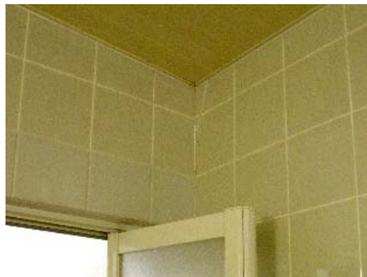
写真-4.65 浴室タイルのひび割れ
