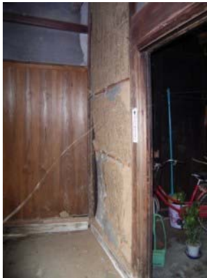
写真-4.124 土壁の剥落
