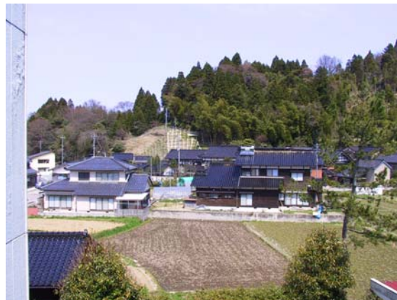
写真-5.22 周辺の民家 (棟瓦のずれ)
