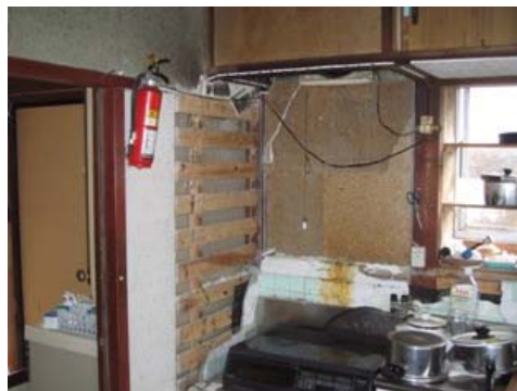
写真-4.87 仕上げ材の剥落
