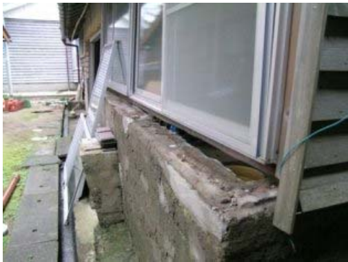
写真-4.147 背面側(コンクリート上で滑る)
