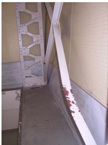
写真-5.4 ブレースの座屈
