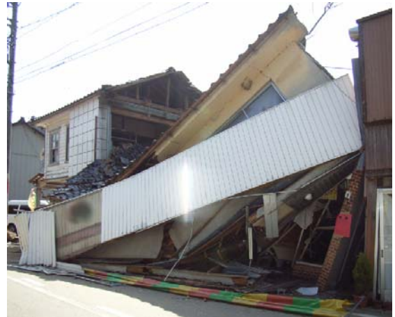
写真-4.22 倒壊した店舗併用住宅
