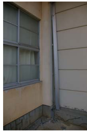
写真-7.16 エキスパンション ジョイント部分の破損
