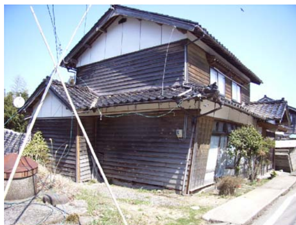
写真-4.14 道路側に大きく傾いた家屋
