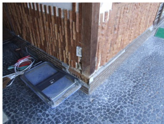
写真-4.97 地震時にずれていた柱（下端部）
