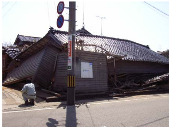
写真-4.26 比較的古い構法の倒壊家屋
