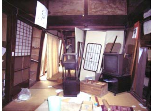
写真-4.71 内部の被害状況
