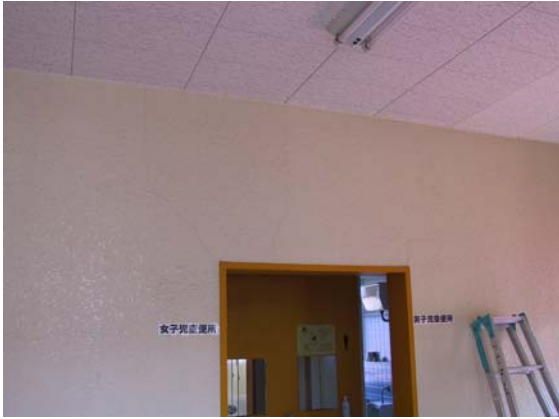
写真-5.16 トイレ入口の壁の亀裂
