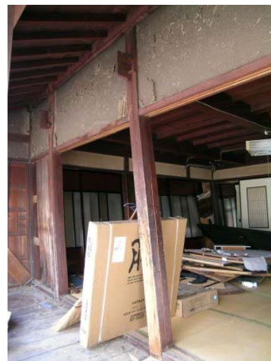
写真-4.117 2階床高さで通し柱折損
