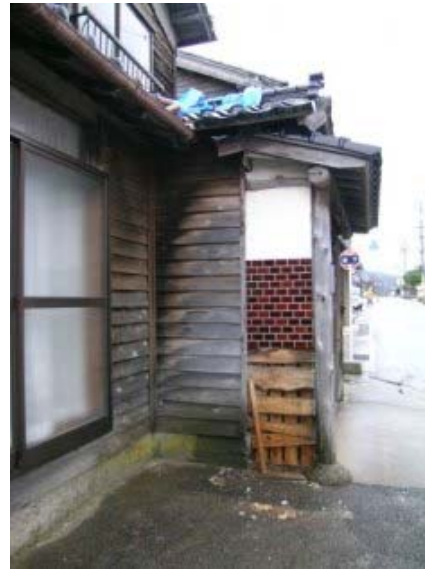
写真-4.150 玄関脇の外壁の剥落
