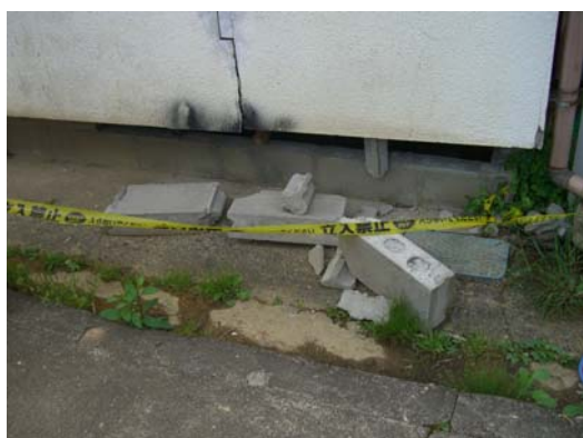
写真-8.7 ブロック基礎による増築部の被害 (土台基礎の外周に設けたブロック基礎の増築部 ブロック基礎が破壊して外壁等が沈下し、上部構 造の変形を増大させたと考えられる例)
