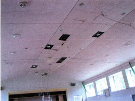
写真-7.10 天井パネル脱落被害（学校提供資料より）
