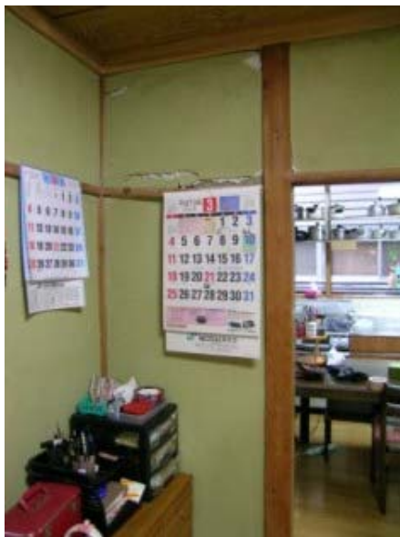
写真-4.151 内壁の損傷
