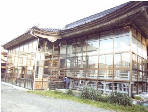
写真-4.9 カーテンウォールの被害
