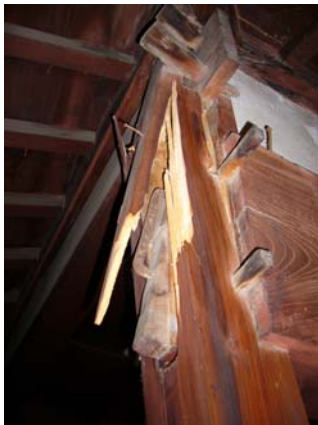
写真-4.74 通し柱を折った桁
