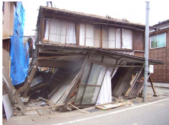
写真-4.44 倒壊寸前の建物
