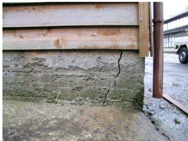
写真-4.152 コンクリート基礎のひび割れ
