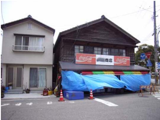
写真-4.41 倒壊した店舗
