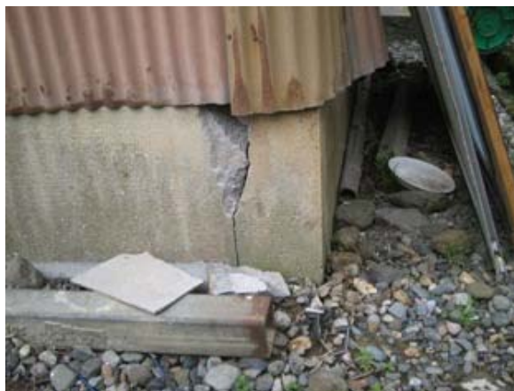
写真-4.89 基礎の割れ
