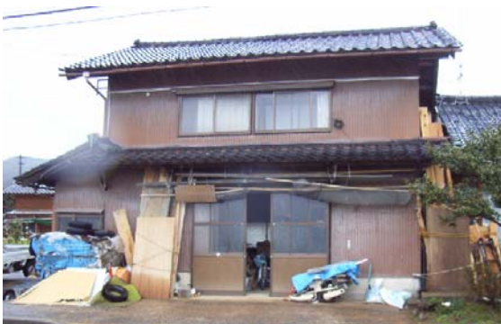
写真-4.55 多少の残留変形が残る家屋
