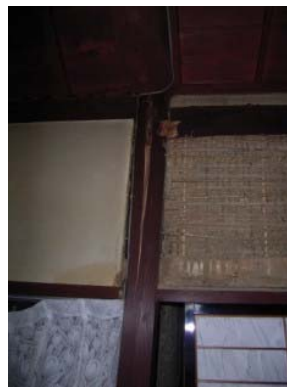
写真-4.127 裂けた柱
