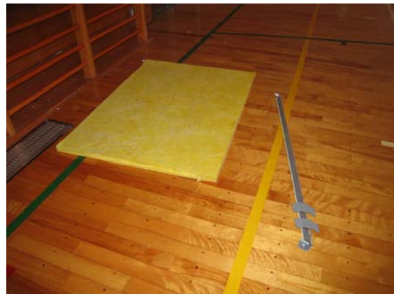
写真-7.6 脱落したグラスウールボードとバー材
