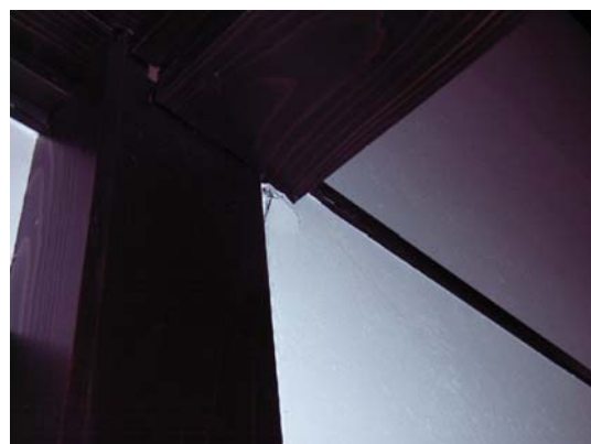
写真-4.162 内装ボードの隅部の破壊
