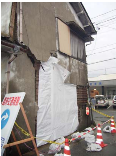
写真-4.129 モルタル壁の脱落
