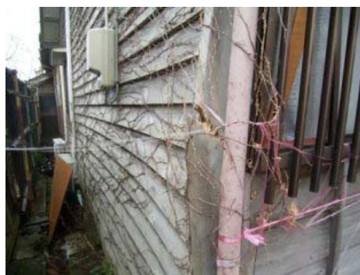
写真-4.119 南東隅の柱の折損
