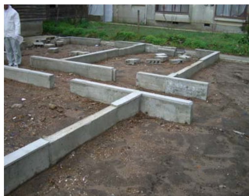
写真-8.8 アンカーボルトが乏しい基礎 無筋コンクリートの基礎
