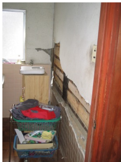
写真-4.140 内壁モルタルの剥落
