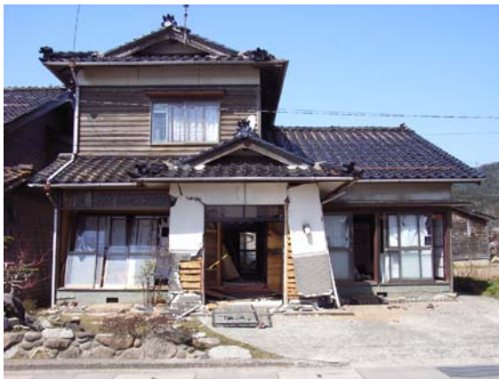
写真-4.25 外装、建具が大破した建物
