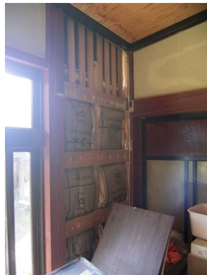
写真-4.93 壁の被害（ラスボード落下）
