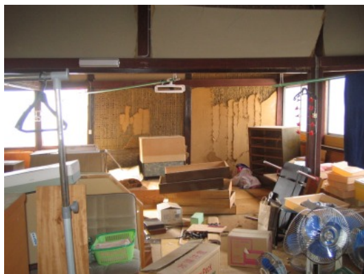
写真-4.96 土塗り壁の剥がれ
