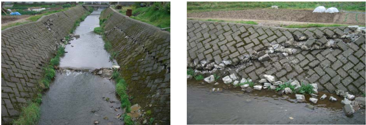
写真-8.12 ブロック積み擁壁の被害（門前道下地区）
