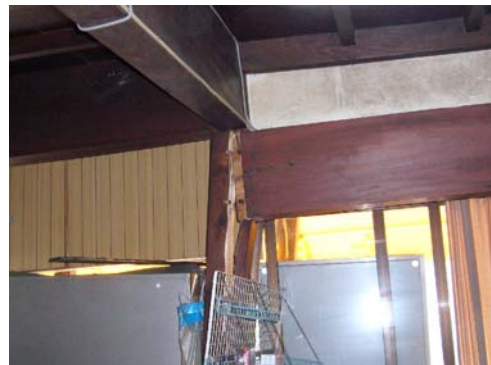
写真-4.75 いまにも外れて落ちそうな桁
