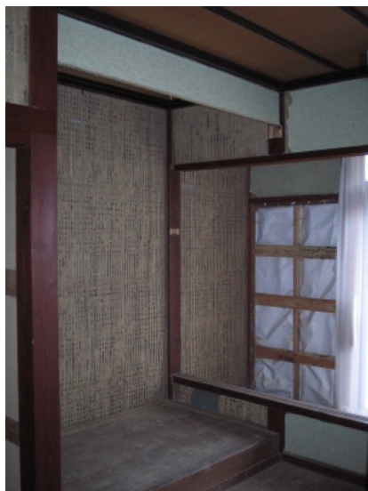
写真-4.139 土塗り壁の剥がれ
