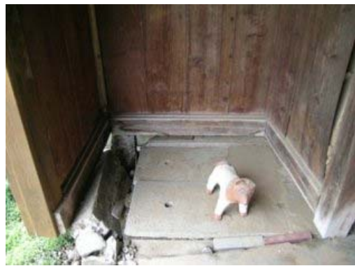
写真-4.146 外壁が道路側(左)に滑る
