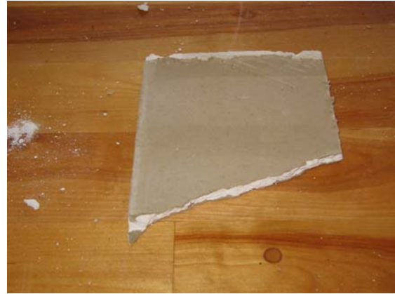
写真-7.25 落下した天井材
