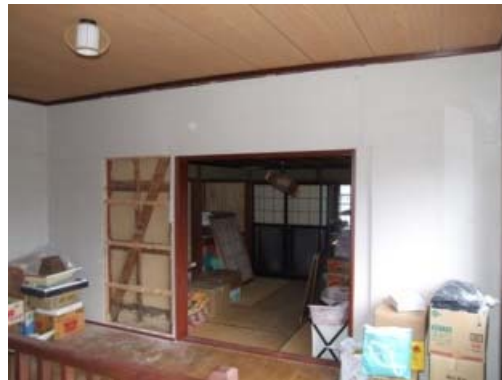
写真-4.138 せっこうボードの剥落
