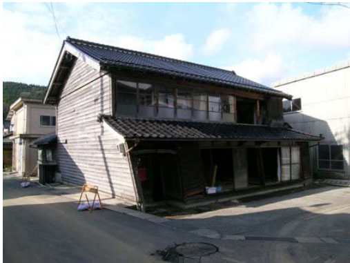
写真-4.114 全景。左（西）に残留変形大
