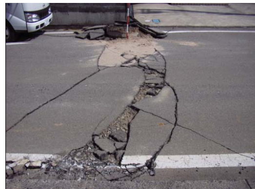
写真-6.6 総合福祉会館周辺の地盤変状
