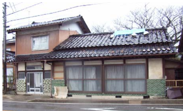
写真-4.56 西岸地区の屋根の被害例
