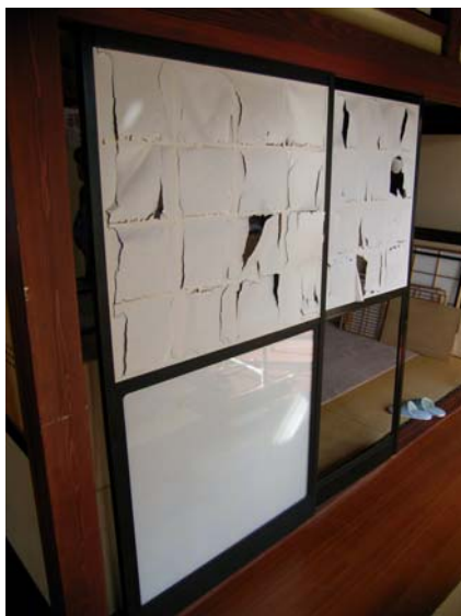
写真-4.92 障子のやぶれ（増築部）
