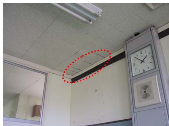
写真-5.8 間仕切り壁がずれた跡 (廊下側)
