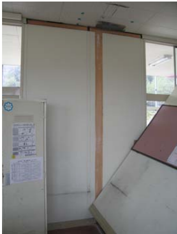
写真-5.9 転倒した間仕切り壁と 廊下側内壁の取り合い
