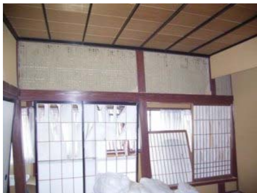
写真-4.120 室内の被害（土壁の剥落）
