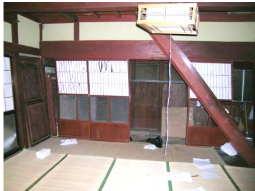
写真-4.148 通り庭内側の傾斜と柱折損
