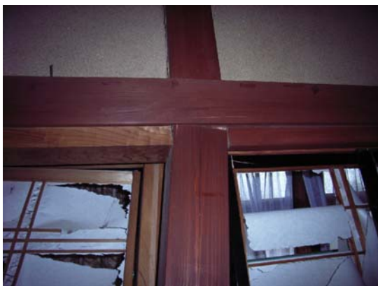
写真-4.135 柱の折損
