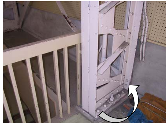
写真-5.5 柱脚部の回転
