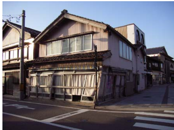
写真-4.6 大きく傾いた店舗併用住宅
