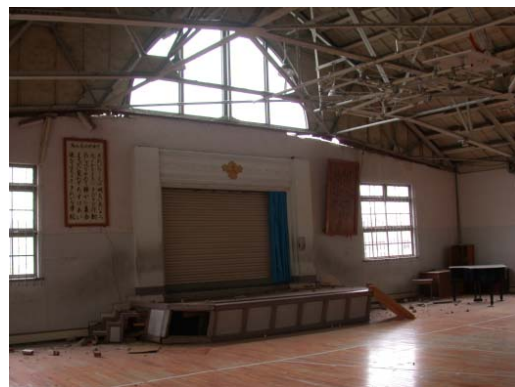
写真-6.12 講堂の妻壁部の被害
