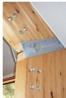
写真-4.168 接合部の被覆材の脱落
