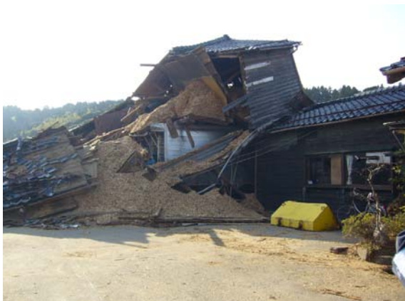
写真-4.1 倒壊したチップ工場
