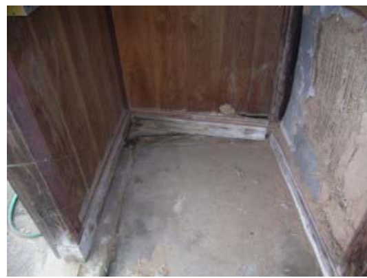
写真-4.123 南西隅の土台の滑り
