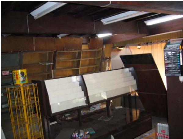
写真-4.72 店舗部分の被害
