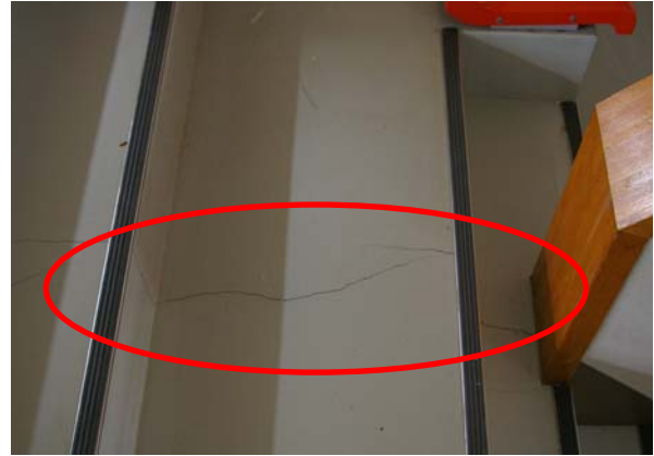
写真-7.34 観覧席横の階段に見られたひび割れ
