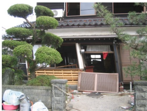
写真-4. 84 外壁モルタルの剥落
