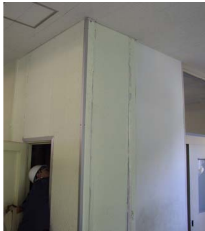
写真-5.11 ALCパネルの目地割れ
