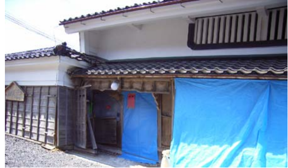
写真-4.32 残留変形が大きい住宅
