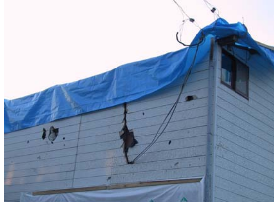
外装材の損傷（飛来物の衝突痕）
