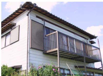
庇が突風で吹き飛ばされた住宅
