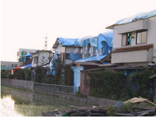
屋根等の被害
