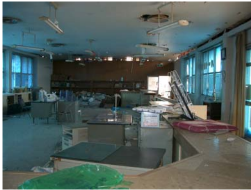
同内部（天井が持ち上げられている）
