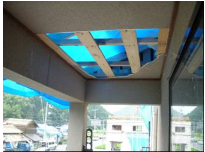
図 19 軒天井の脱落
