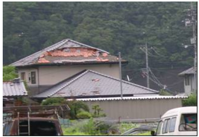
図 21 2階屋根瓦の移動（美作市撮影）
