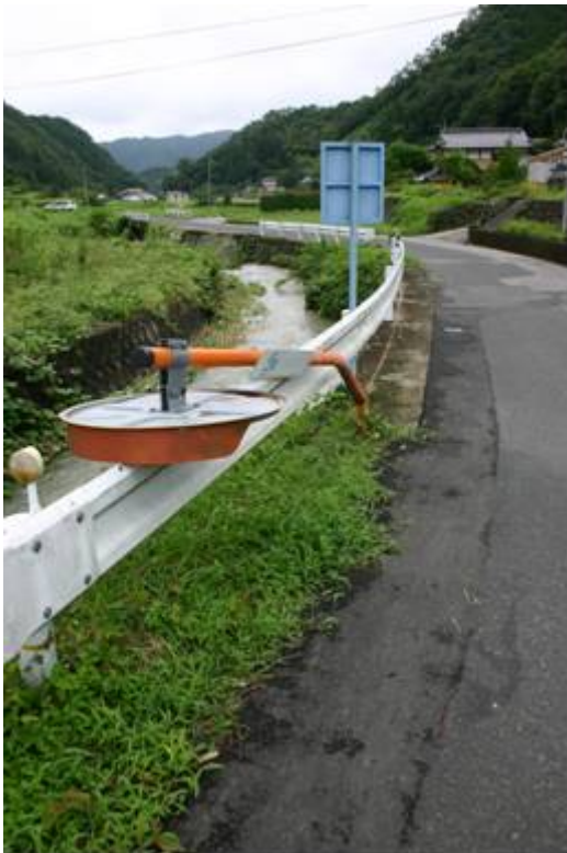
図 26 道路ミラーの曲がり (美作市撮影)
