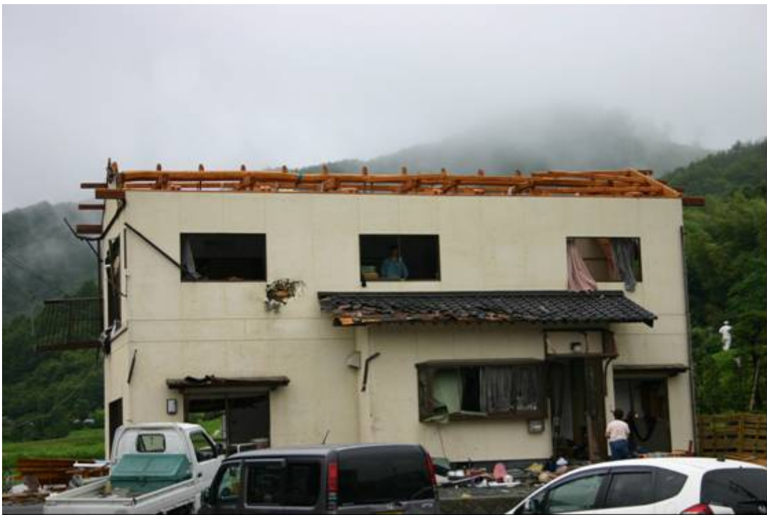
図6 屋根が飛ばされた新聞販売店の東面（美作市撮影）
