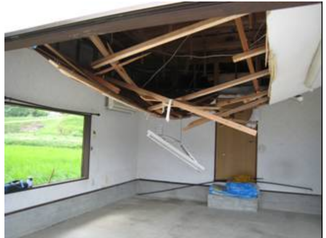
図12 1階南側部屋の天井仕上げ材の垂下り
