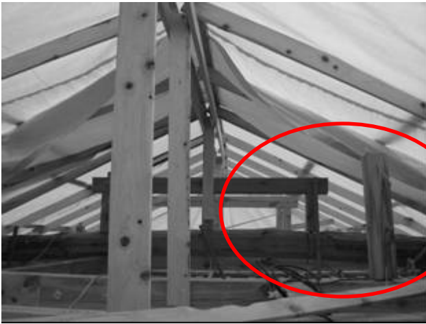
図 16 屋根が飛ばされた住家の小屋組の状況
