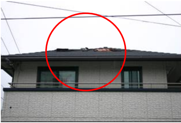
図 20 プレハブ住宅の屋根の損傷（美作市撮影）
