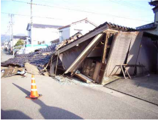
写真-4.7 1階車庫か倉庫の建物の倒壊
