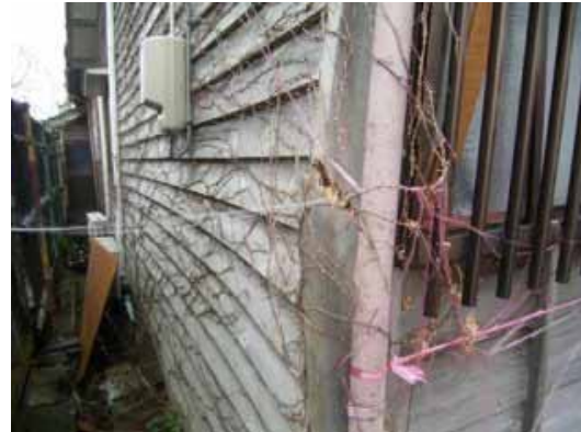
写真-4.119 南東隅の柱の折損
