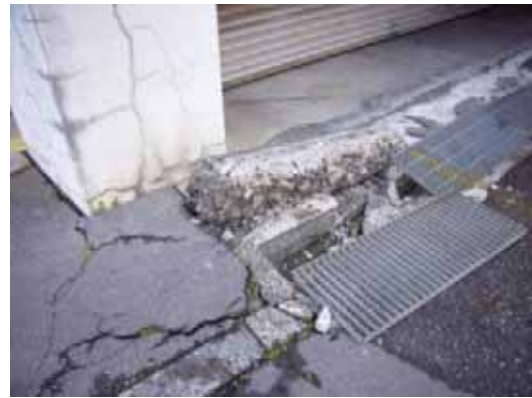
写真-6.2 輪島市役所周辺地盤の隆起・ひび割れ
