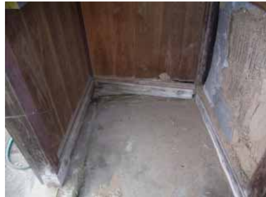
写真-4.123 南西隅の土台の滑り
