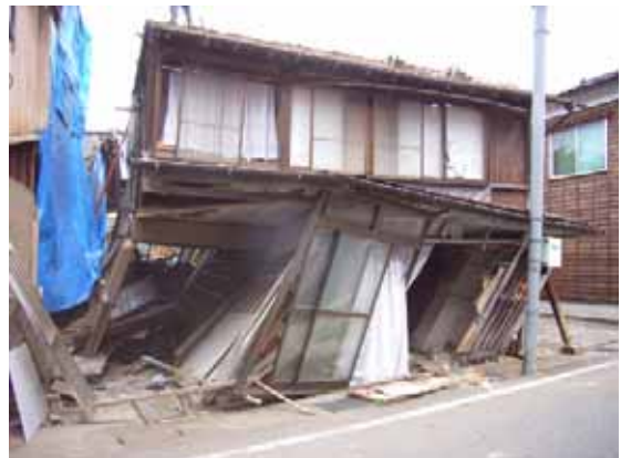
写真-4.44 倒壊寸前の建物
