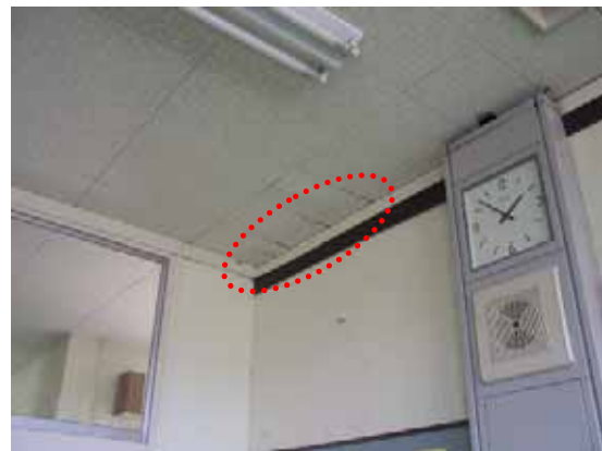
写真-5.8 間仕切り壁がずれた跡 (廊下側)
