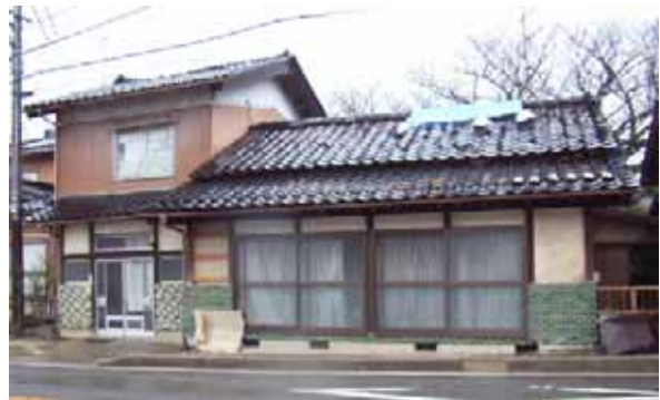
写真-4.56 西岸地区の屋根の被害例
