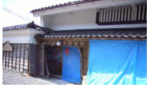
写真-4.32 残留変形が大きい住宅
