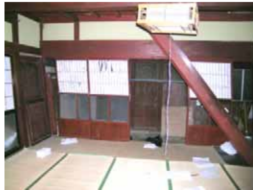
写真-4.148 通り庭内側の傾斜と柱折損
