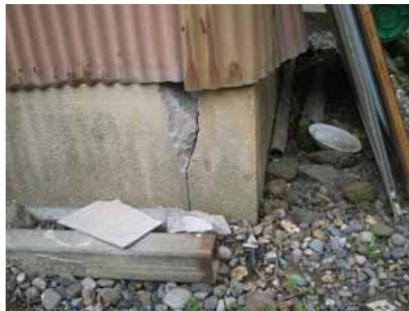
写真-4.89 基礎の割れ
