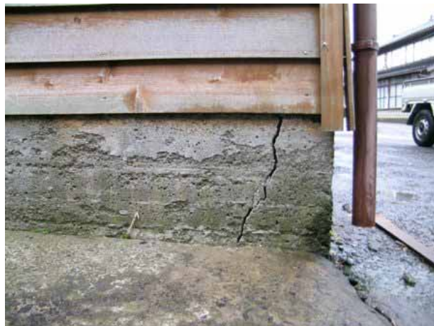
写真-4.152 コンクリート基礎のひび割れ
