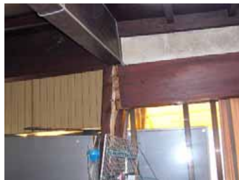
写真-4.75 いまにも外れて落ちそうな桁
