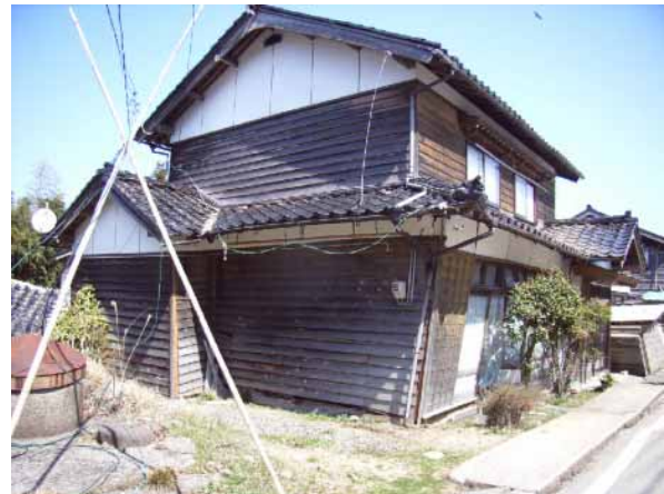
写真-4.14 道路側に大きく傾いた家屋
