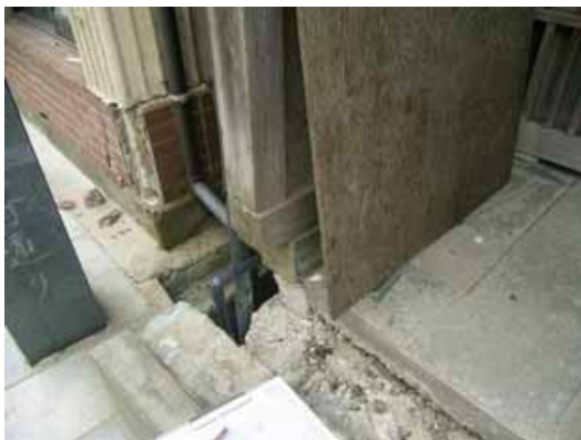
写真-4.60 土台のずれ
