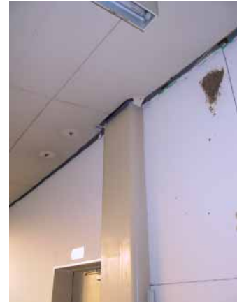
写真-7.38 天井と壁面のすきま
