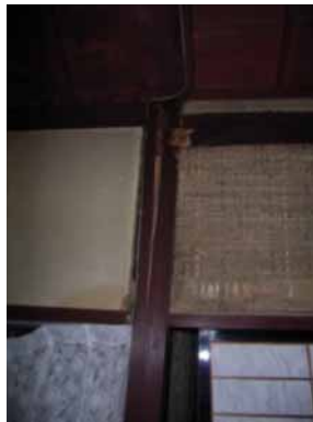
写真-4.127 裂けた柱
