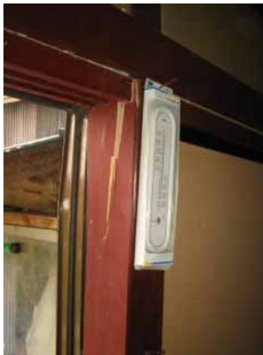
写真-4.88 柱の割裂
