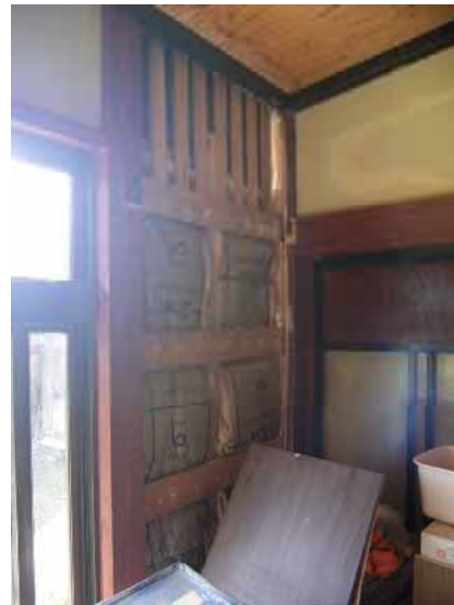
写真-4.93 壁の被害（ラスボード落下）
