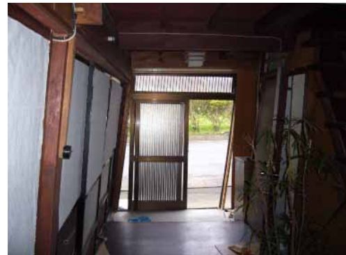
写真-4.134 極めて大きい残留変形角
