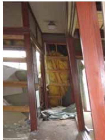
写真-4.85 内壁仕上げ材の剥がれ
