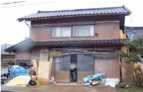
写真-4.55 多少の残留変形が残る家屋
