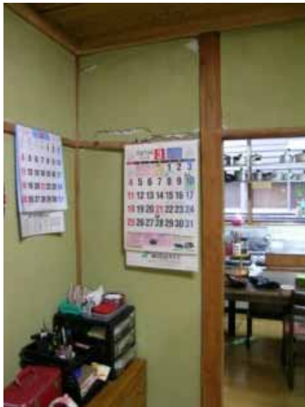
写真-4.151 内壁の損傷
