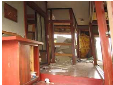
写真-4.83 室内の被害状況
