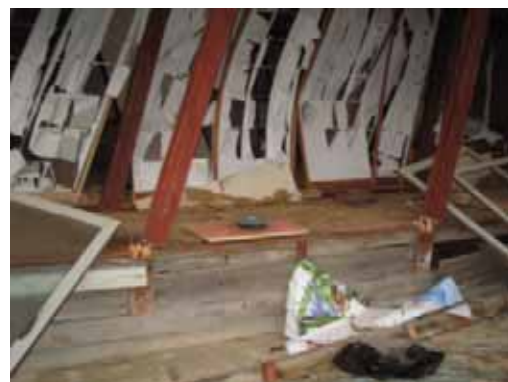
写真-4.144 下端部付近での柱の折損
