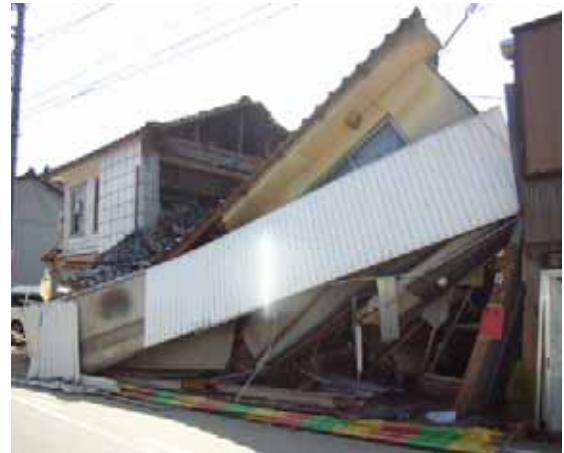
写真-4.22 倒壊した店舗併用住宅
