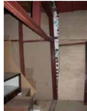
写真-4.128 梁の抜け出し
