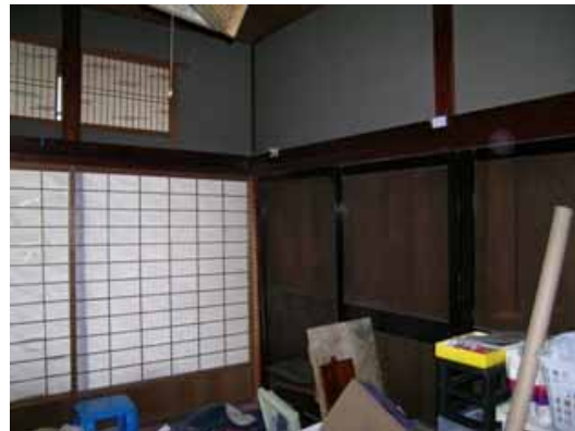
写真-4.59 内部の被害（柱の傾斜）
