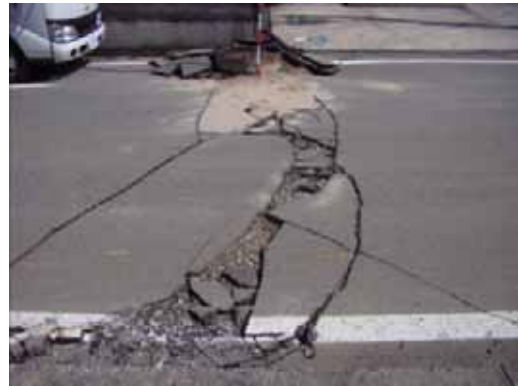
写真-6.6 総合福祉会館周辺の地盤変状
