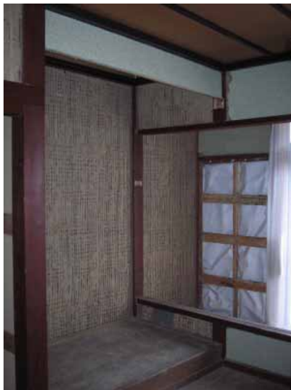
写真-4.139 土塗り壁の剥がれ
