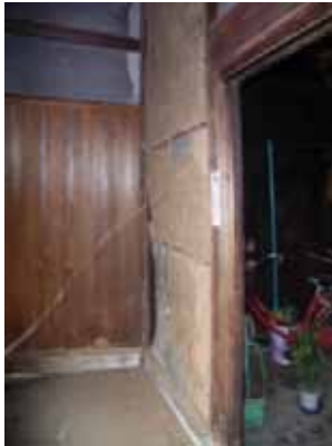
写真-4.124 土壁の剥落
