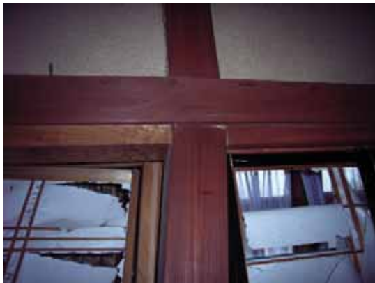
写真-4.135 柱の折損
