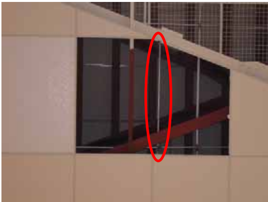
写真-7.2 クロス T バーがない箇所 (床面から見上げた様子)
