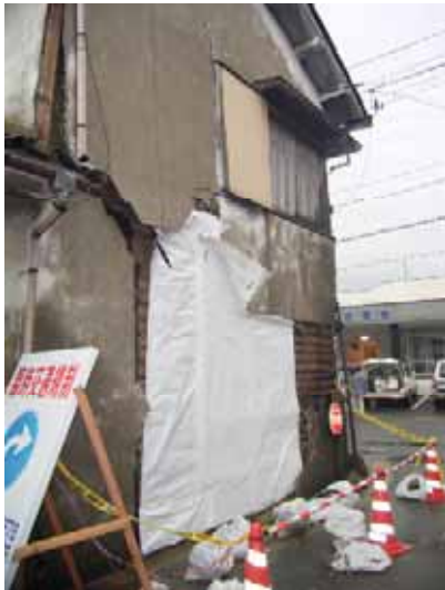
写真-4.129 モルタル壁の脱落
