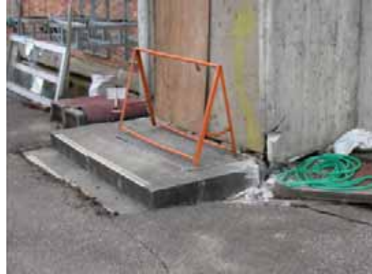
写真-6.15 建物周辺部の液状化被害
