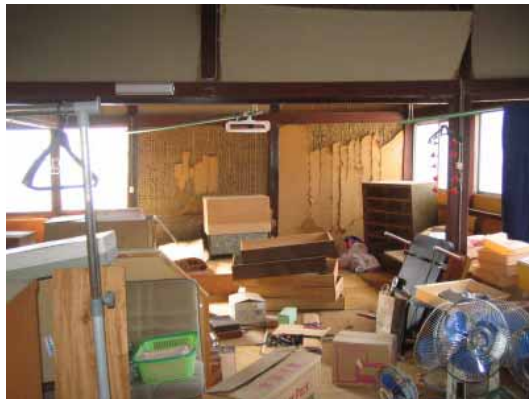
写真-4.96 土塗り壁の剥がれ
