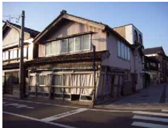
写真-4.6 大きく傾いた店舗併用住宅
