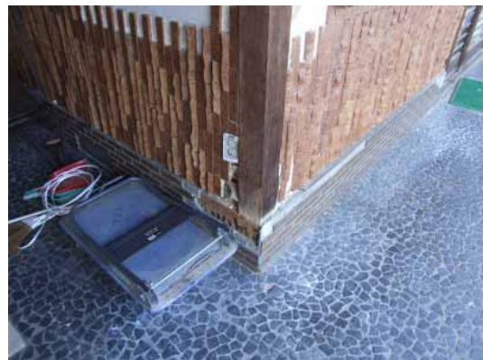
写真-4.97 地震時にずれていた柱（下端部）
