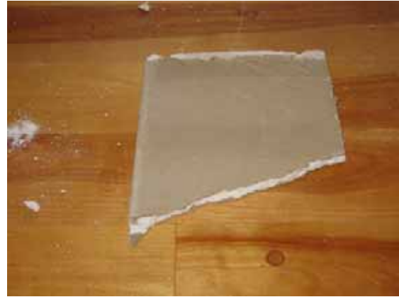
写真-7.25 落下した天井材
