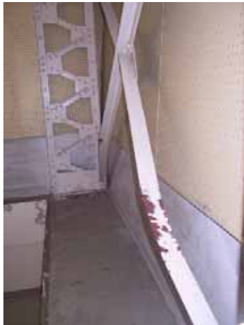
写真-5.4 ブレースの座屈
