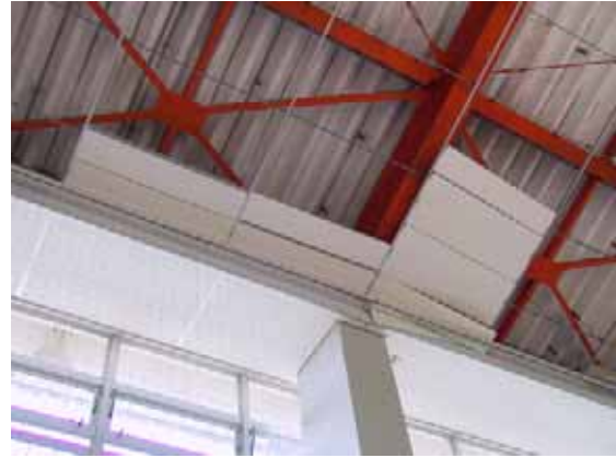
写真-7.14 ずれたり脱落しかけたりしている 天井パネル
