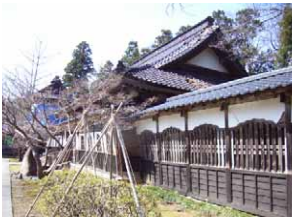
写真-4.19 被害が大きい山門左奥の建物
