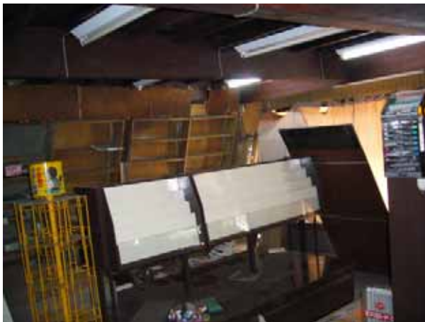
写真-4.72 店舗部分の被害
