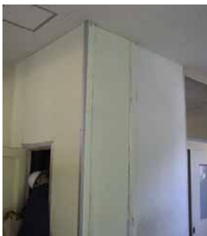
写真-5.11 ALCパネルの目地割れ
