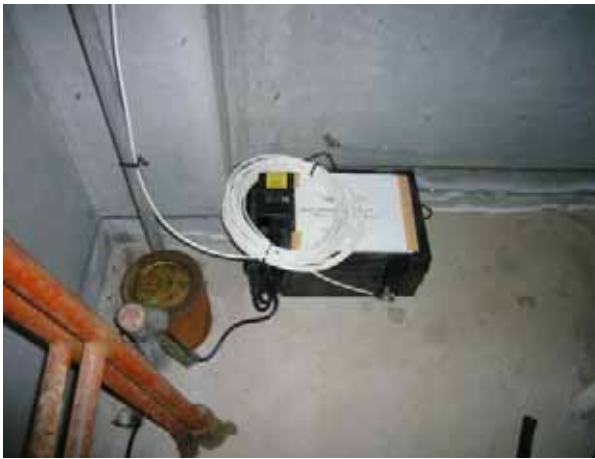
写真-3.3 輪島市役所 1階強震計設置状況
