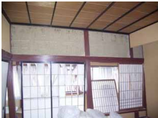
写真-4.120 室内の被害（土壁の剥落）
