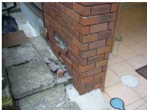
写真-4.80 店頭西側脚部の外装の破損
