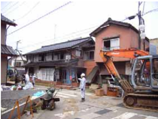
写真-4.43 残留変形が大きい店舗併用住宅
