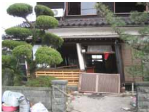
写真-4.84 外壁モルタルの剥落
