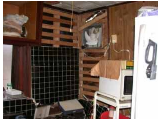
写真-4.125 台所の壁の被害
