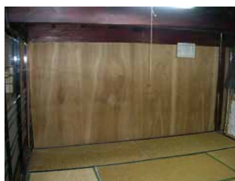
写真-4.69 梁(差鴨居)の抜け出し
