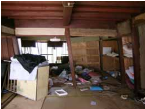
写真-4.116 内部。柱の折損、壁の脱落。
