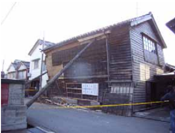
写真-4.5 倒壊寸前の土塗り壁を有する家屋
