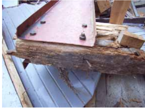
写真-4.4 左の家屋の鉄骨梁と木材柱の腐朽
