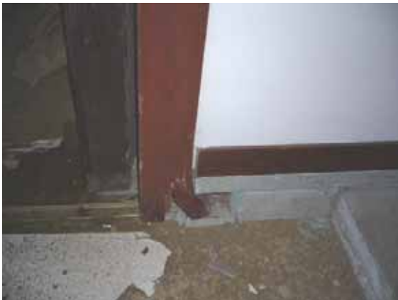
写真-4.106 基礎と土台のずれ
