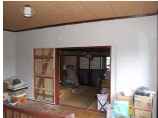
写真-4.138 せっこうボードの剥落
