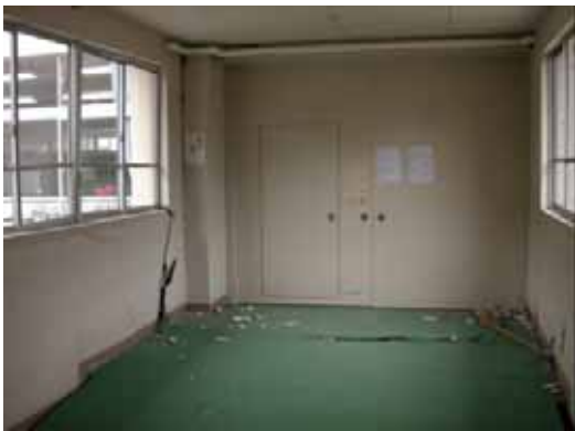
写真-6.11 校舎と講堂の渡り廊下の被害
