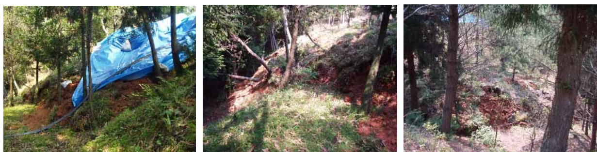
写真-8.15 崩壊した斜面の先端付近の状況
