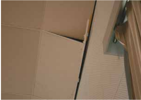
写真-7.33 妻壁際で脱落しかけた天井部材
