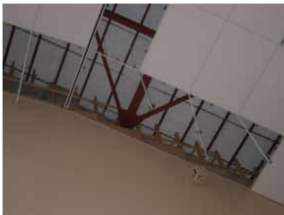
写真-7.5 舞台と反対側の妻面での被害状況
