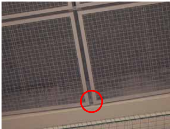
写真-7.21 梁際で下がった天井面
