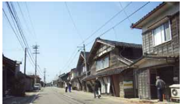
写真-4.30 道路側に大きく傾斜した家屋群
