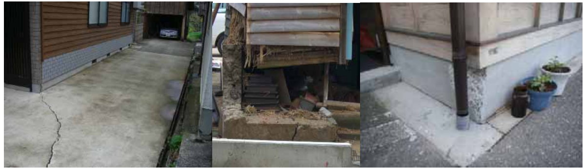
写真-8.6 コンクリート基礎の被害
