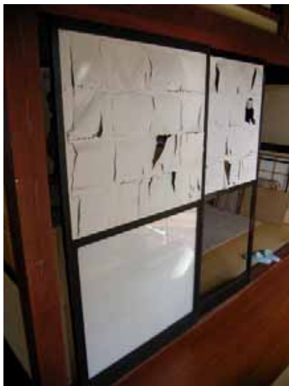
写真-4.92 障子のやぶれ（増築部）
