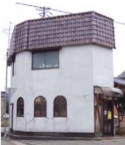
写真-4.47 躯体の腐朽が確認された店舗
