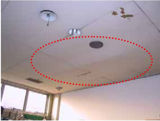
写真-7.37 天井面のゆがみ
