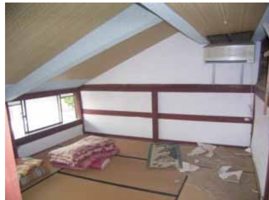
写真-4.121 2階の被害（壁の落下）
