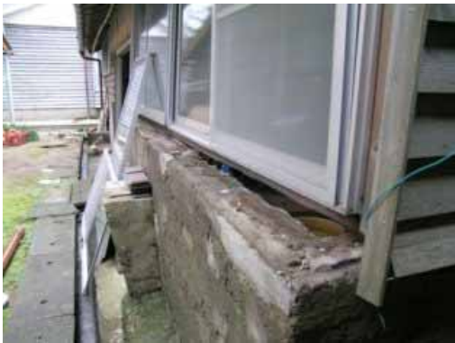
写真-4.147 背面側。コンクリート上で滑る
