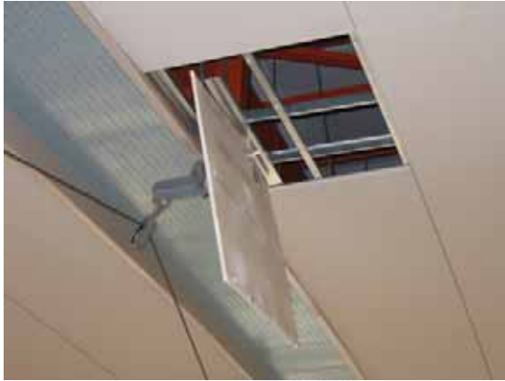
写真-7.24 脱落しかけた天井材
