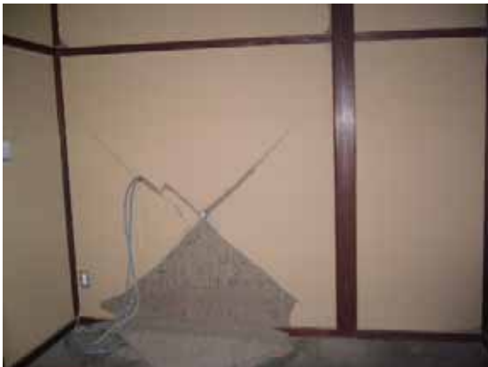
写真-4.104 せん断破壊した土塗り壁
