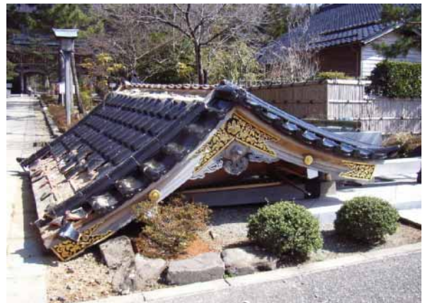
写真-4.18 倒壊した手洗い場の東屋
