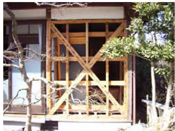
写真-4.24 左の民家の筋かい
