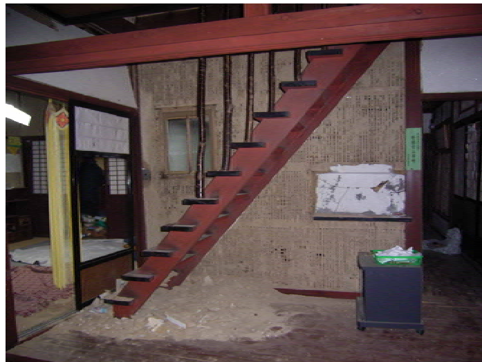
写真-4.130 土塗壁の剥落
