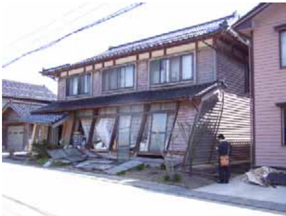
写真-4.29 通りの方向の残留変形が大きい住宅
