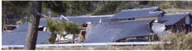
写真-4.36 鹿磯地区で倒壊した製材工場
