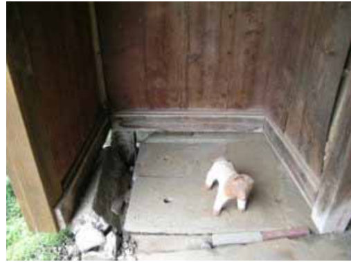
写真-4.146 外壁が道路側（左）に滑る
