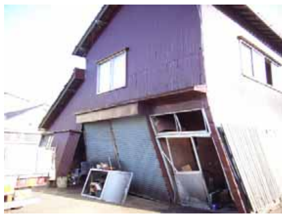
写真-4.2 倒壊寸前のチップ工場の倉庫
