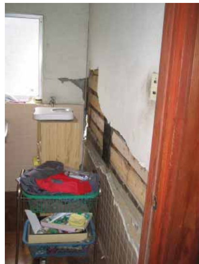
写真-4.140 内壁モルタルの剥落
