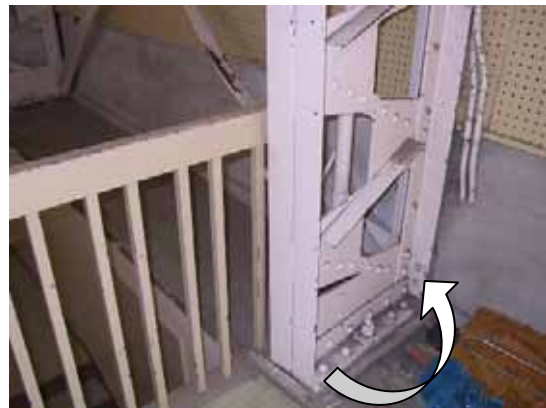
写真-5.5 柱脚部の回転
