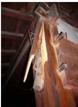
写真-4.74 通し柱を折った桁
