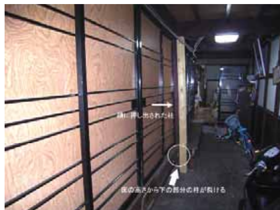
写真-4.67 床から下が折れた柱
