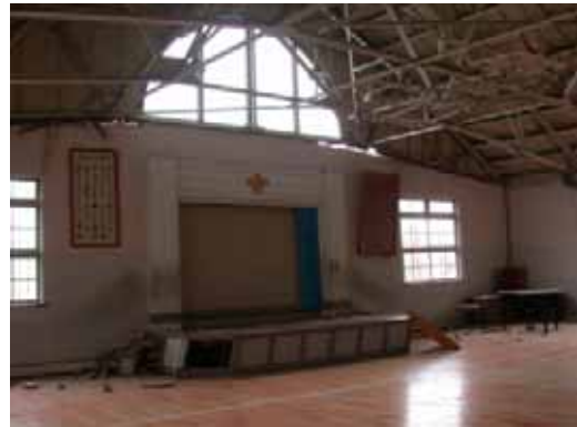
写真-6.12 講堂の妻壁部の被害
