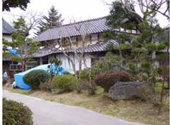
写真-4.54 奥原地区で大破した家屋
