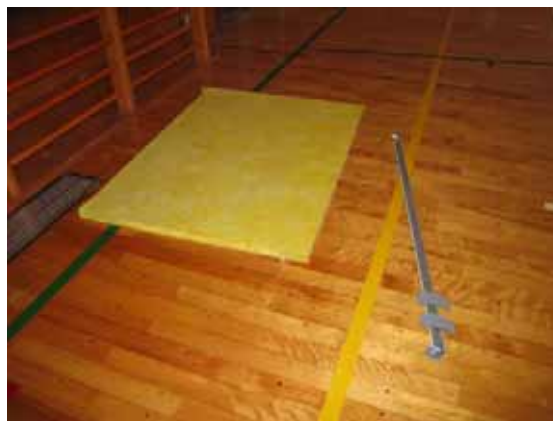
写真-7.6 脱落したグラスウールボードとバー材
