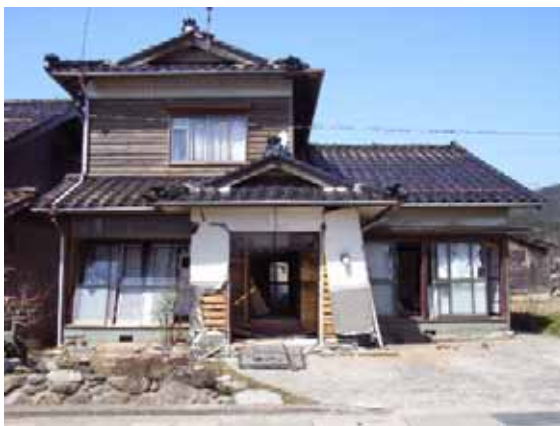
写真-4.25 外装、建具が大破した建物
