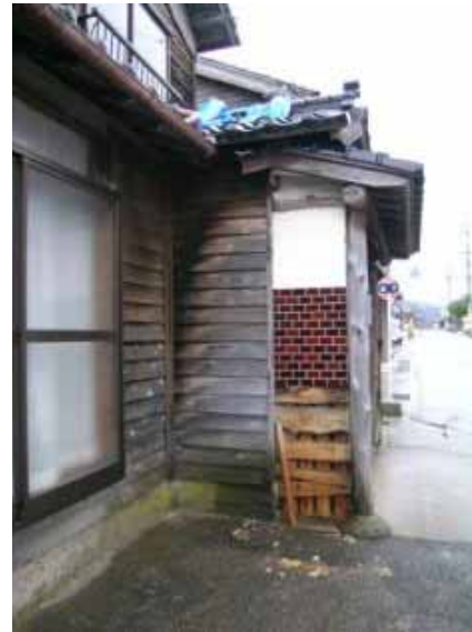
写真-4.150 玄関脇の外壁の剥落
