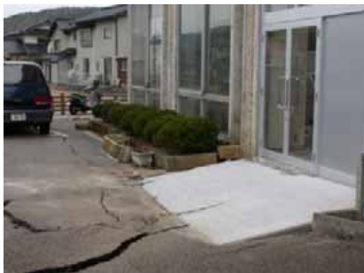
写真-6.16 建物周辺部の液状化被害
