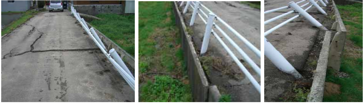
写真-8.11 L型コンクリート擁壁の被害例
