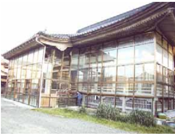
写真-4.9 カーテンウォールの被害
