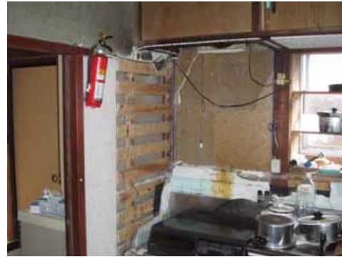
写真-4.87 仕上げ材の剥落
