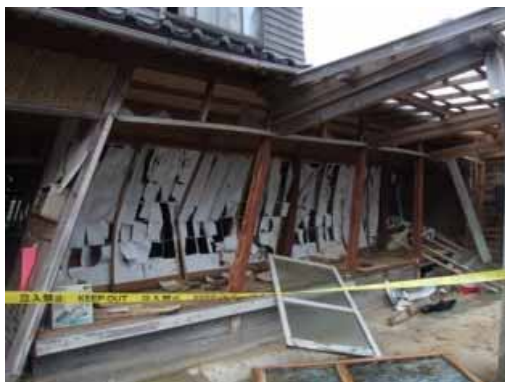
写真-4.143 大きく傾いた柱
