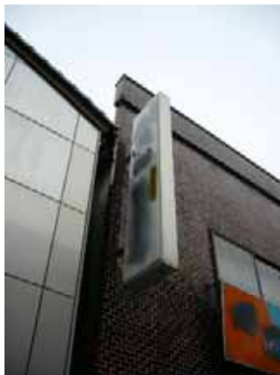
写真-4.78 隣接建物看板の衝突痕
