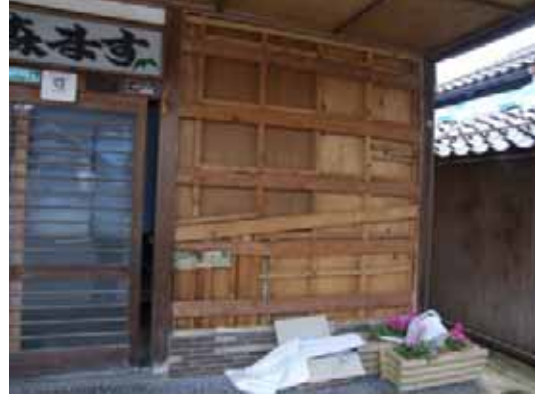
写真-4.95 外壁仕上げ材の剥落
