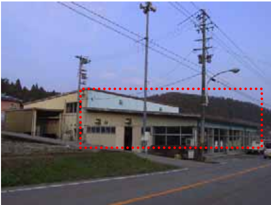
写真-7.35 建物L外観（破線部で天井被害を確認）
