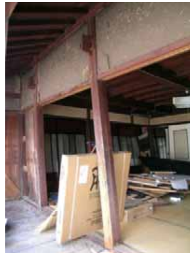
写真-4.117 2階床高さで通し柱折損
