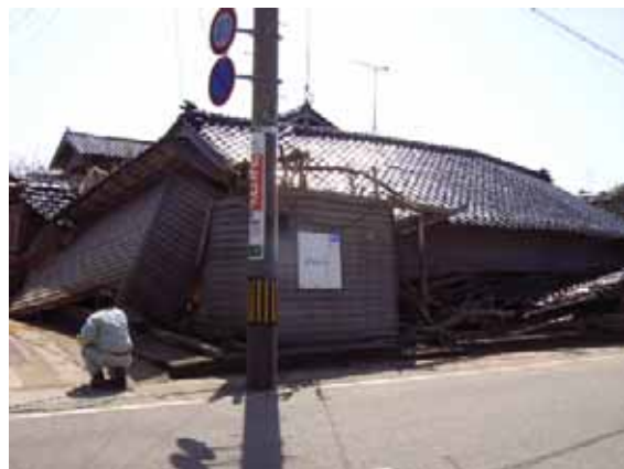
写真-4.26 比較的古い構法の倒壊家屋
