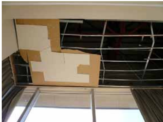
写真-7.3 捨て張り工法による天井の被害 (加賀市役所提供)
