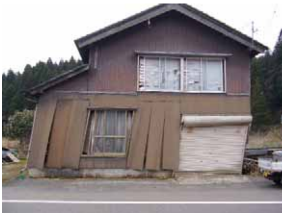
写真-4.49 残留変形が大きい車庫付き家屋
