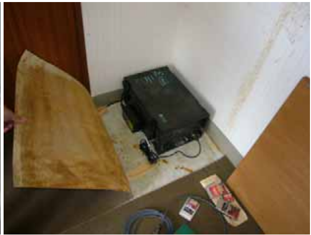
写真-3.4 輪島市役所 4階強震計設置状況
