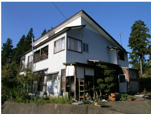
写真 4.63 小屋裏 3 階建ての被害
