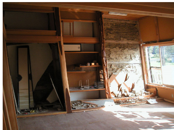
写真 4.50 内壁が剥落し傾斜が大
