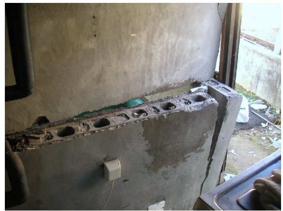
写真 4.79 浴室の立ち上がり基礎から脱落しそうな壁
