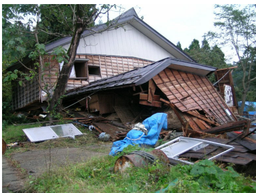
写真 4. 37 住宅の1階層崩壊
