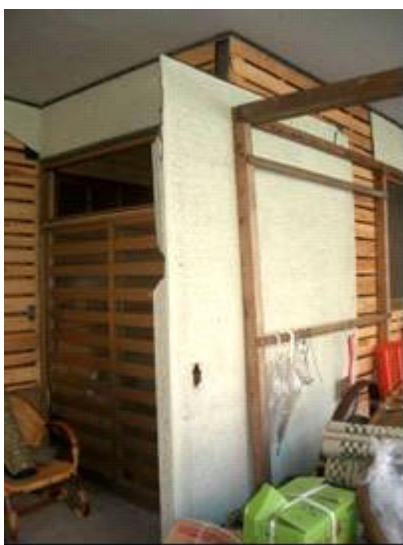
写真 4.33 モルタルの全面的な剥落
