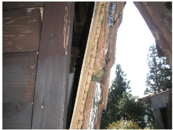
写真 4.77 内外壁一帯となって外れた壁
