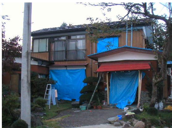
写真 4.67 残留変形の大きな家屋
