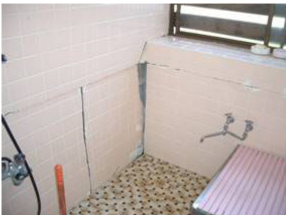
写真 4.105 浴室のタイル等の被害
