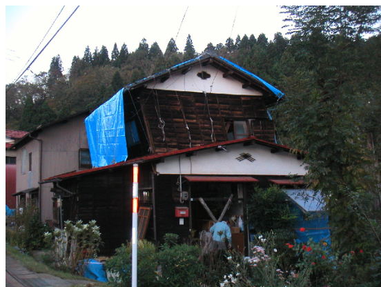
写真 4.68 2階の残留変形が1階の残留変形より大きい被害例
