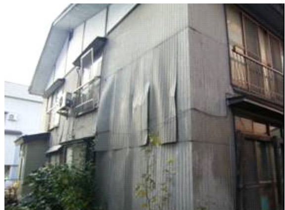
写真 4.34 金属系サイディングの浮き
