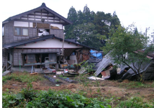
写真 4. 36 住宅一部平屋部分倒壊
