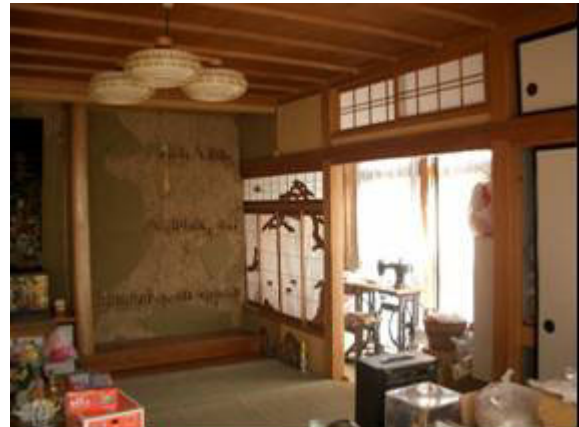
写真 4.104 土壁（内部に筋かい）の被害
