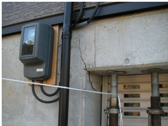
写真 4.101 RC層(外周部分)のひび割れ
