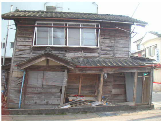
写真 4.21 前面（右側）にも傾斜
