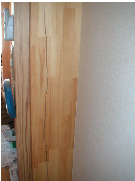
写真 4.47 造作材のひび割れ
