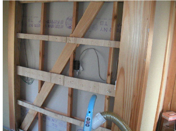
写真 4.46 せっこうボードが剥落（1カ所のみ）して露出した筋かい
