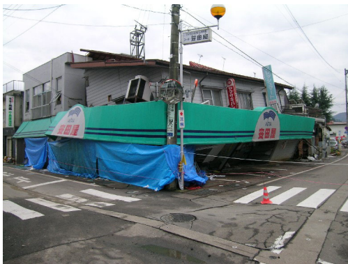
写真 4.11 倒壊したS造店舗
