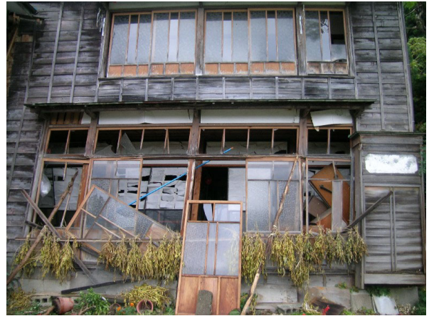
写真 4.58 大破した築 39 年の住宅
