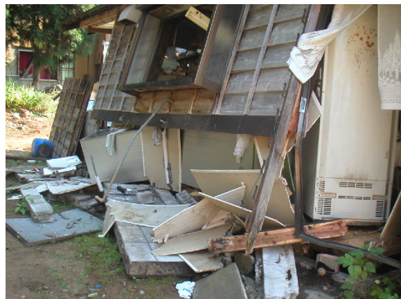
写真 4.44 ブロック基礎の立ち上がり部分の崩壊
