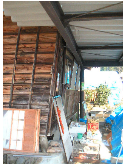
写真 4.42 S 造の車庫屋根に衝突
