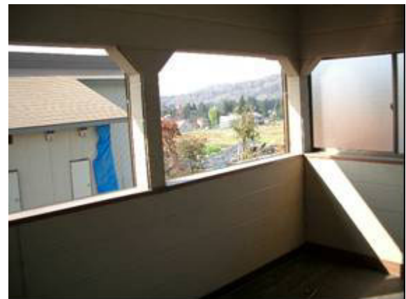
写真 4.52 開口部が多く被害の少ない 木部 2 階
