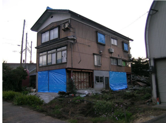
写真 4.70 1階S造2,3階木造の住宅の被害
