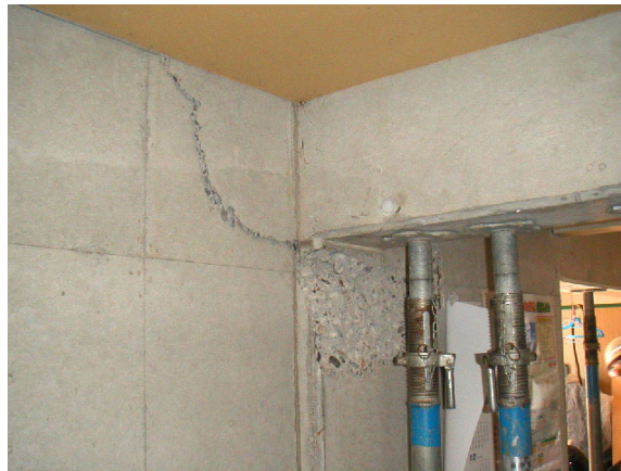
写真 4.102 外周部分のRC層より大きな内周部分のひび割れ(一部剥落)
