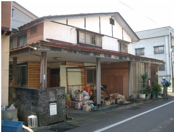
写真 4.31 建物概観（モルタル剥落）
