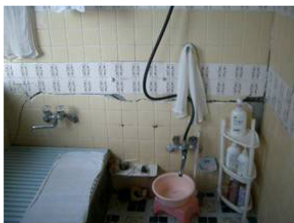
写真 4.86 浴室のブロックのズレによる タイル等の割れと剥落
