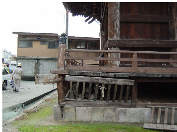
写真 4.3 大きく傾いた本堂
