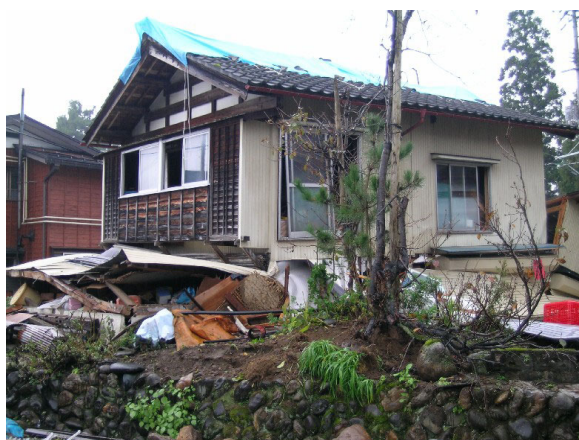
写真 4.75 新道島地区の1層崩壊の住宅
