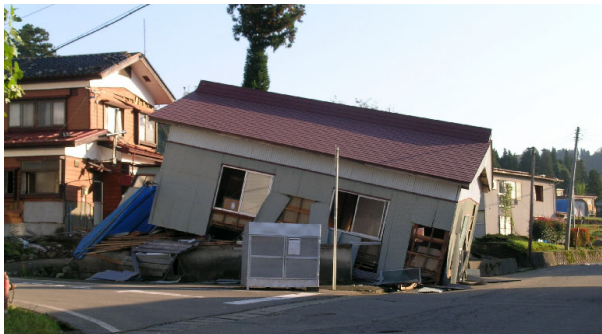
写真 4.61 作業小屋の倒壊
