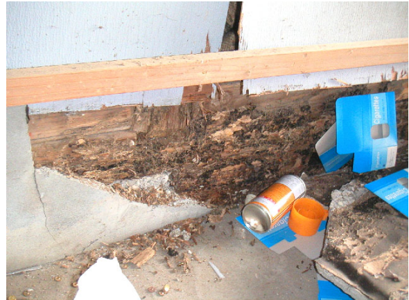
写真 4.20 腐朽し、蟻害を受けた土台
