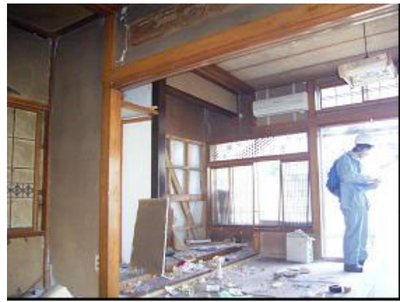
写真 4.108 内壁の被害と筋かい
