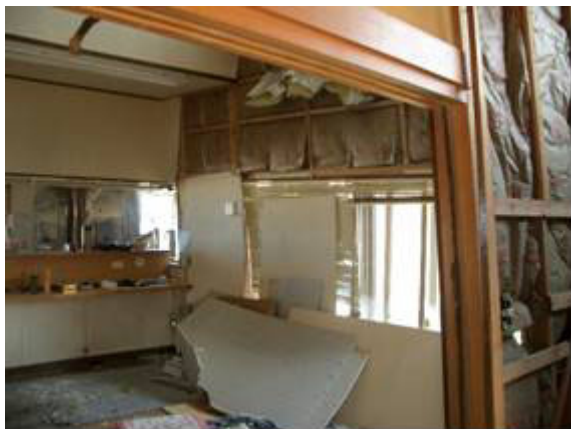
写真 4.51 台所と階段室の内壁の脱落
