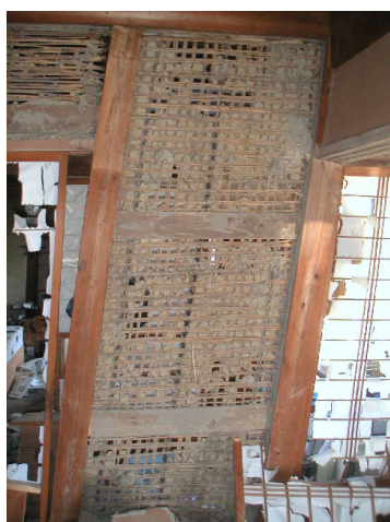
写真 4.17 塗り土が崩落した土壁
