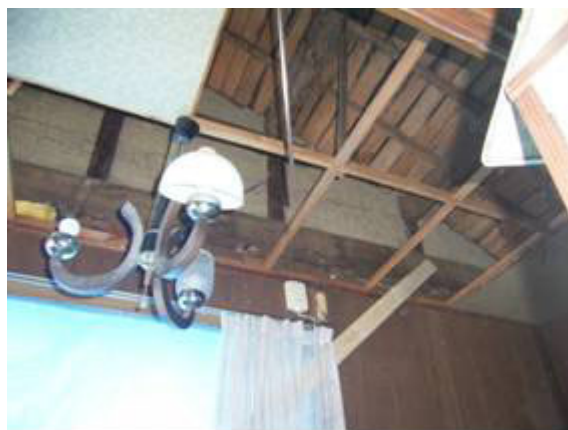
写真 4.30 天井材の脱落
