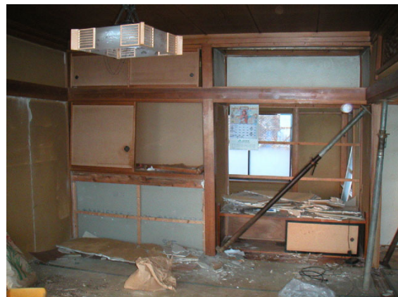
写真 4.83 内装ラスボードの脱落
