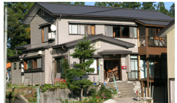
写真 4.62 地盤変状により傾斜大の住戸
