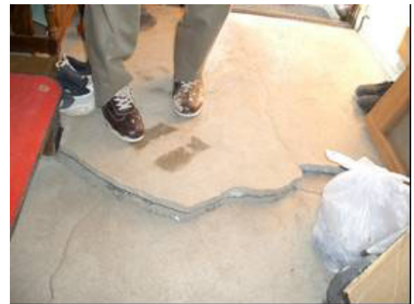
写真 4.56 玄関の床の被害
