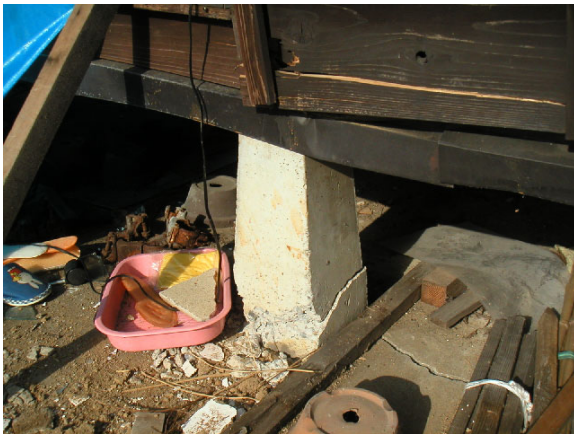
写真 4.78 外周部の束石基礎のひび割れ
