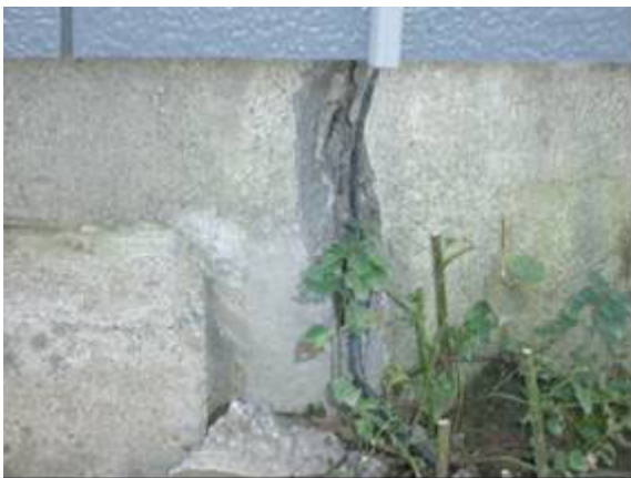
写真 4.55 布基礎の断裂
