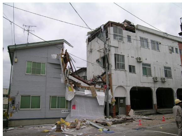
写真 4.4 隣接建物からの落下物により崩壊
