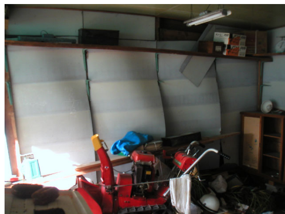
写真 4.22 大きく波打つ内装合板
