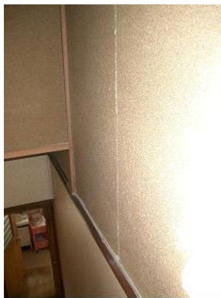
写真 4.85 内壁の仕上げの亀裂
