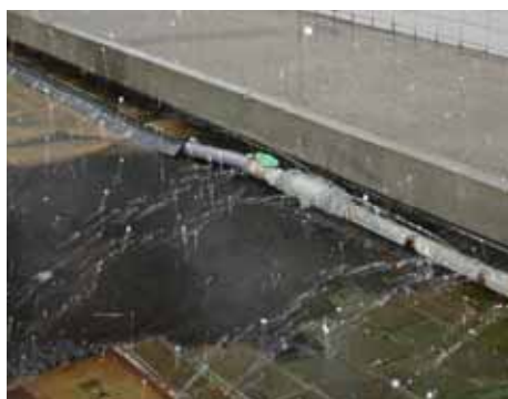
(a) 融雪用の配管（放水中）
