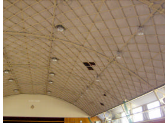
写真 7.56 木毛セメント板の落下(TOK-2)
