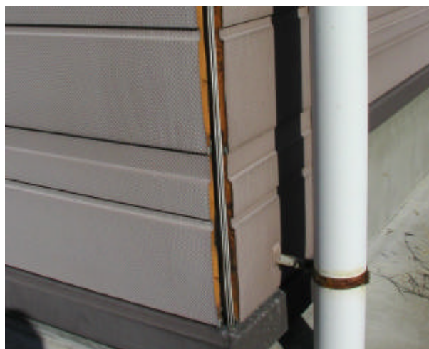
写真 7.44 コーナー部材の脱落(KID-6)
