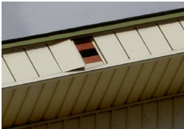
写真 7.43 金属パネルの脱落(KWG-1)
