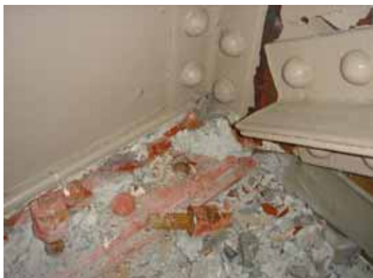
写真 7.9 アンカーボルトの破断(OJY-8)
