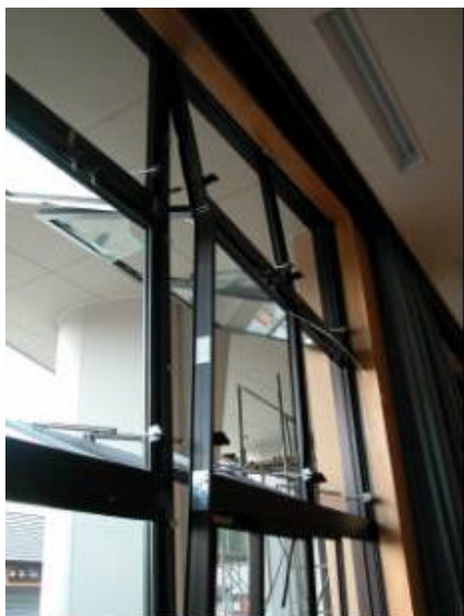
写真 7.42 窓枠の破損 (KSJ-3)
