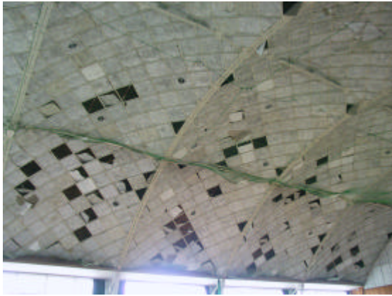
写真 7.53 木毛セメント板の落下(HRN-2)
