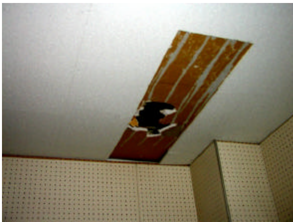
写真 7.61 落下物による破損 (OJY-10)
