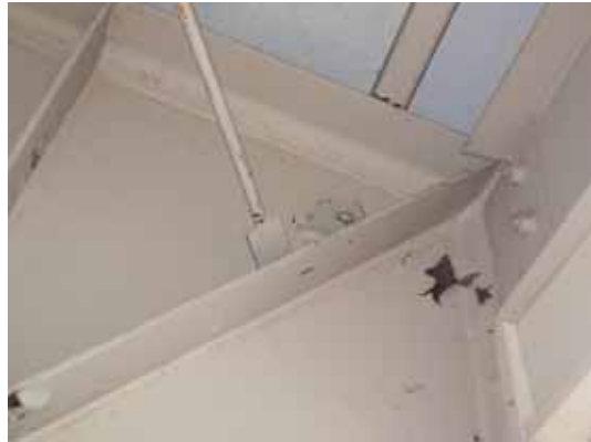
写真 7.27 水平ブレース破断(OJY-20)
