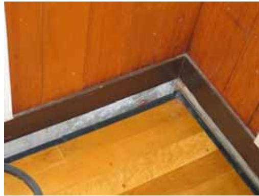
写真 7.33 床の沈下(KWG-4)
