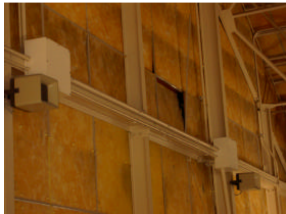
写真 7.52 グラスウール成形板の破損 (KWG-5)
