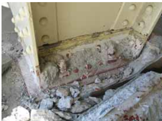
写真 7.13 柱脚コンクリートの破壊(TOK-2)
