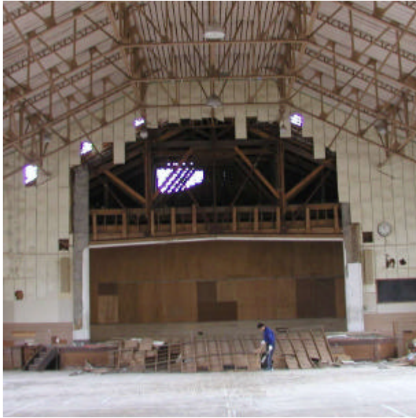
写真 7.49 妻壁の下地からの崩壊 (OJY-9)
