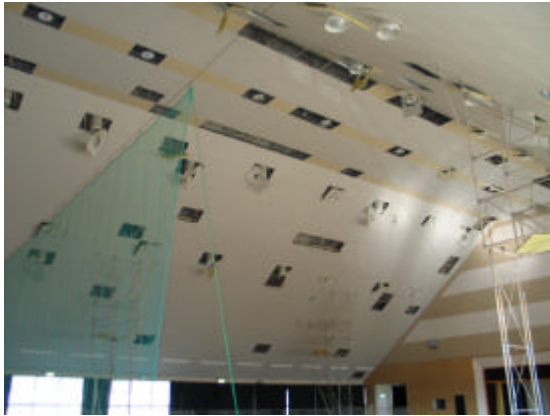
写真 7.59 化粧ガラスウールボードの落下 (KWN-2)
