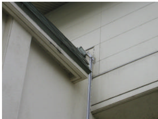
写真 7.48 ALC パネル横壁ボルト止め構法の 取り合い部の破損(0JY-10)
