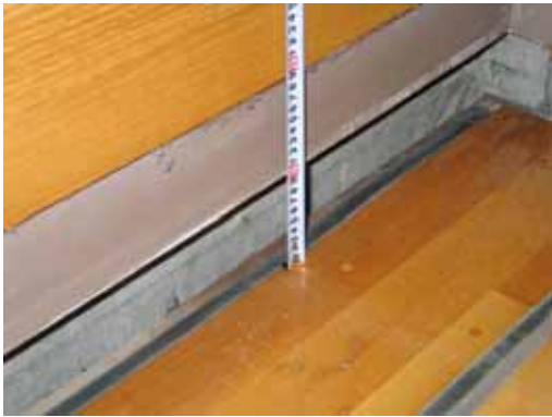
写真 7.32 床の沈下(OJY-15)
