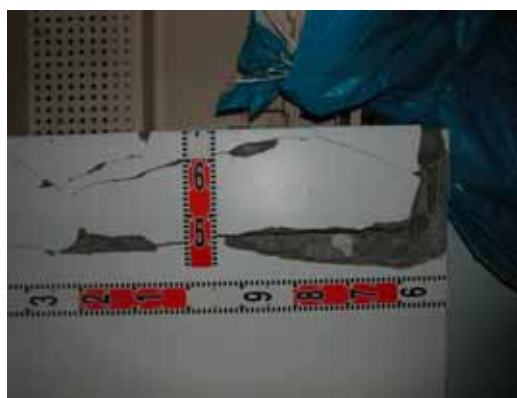
写真 7.10 柱脚部コンクリートの破壊(OJY-24)
