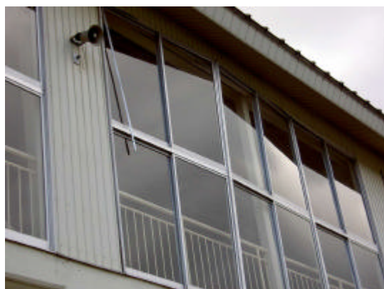
写真 7.40 窓枠上部の破損(KWG-1)
