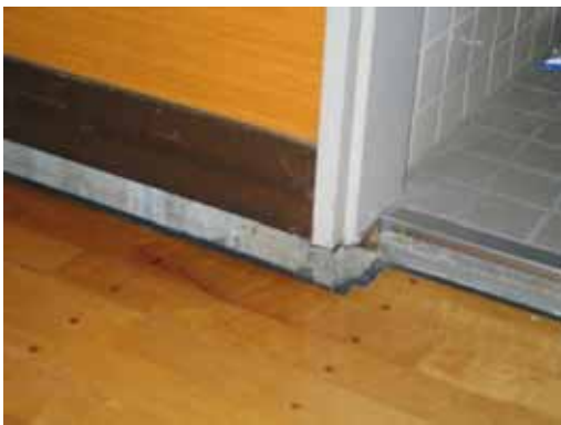
写真 7.34 床の沈下(TOK-1)
