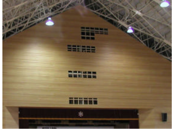
写真 7.50 接着張りボードの脱落 (OJY-10)
