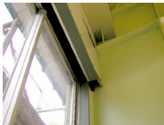
写真 7.41 窓枠周辺内壁の破損(OJY-21)
