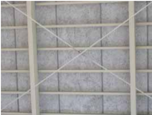
写真 7.26 水平ブレースたわみ(OJY-18)
