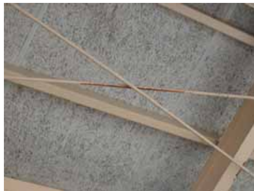
写真 7.23 水平ブレースのたわみ(OJY-11)
