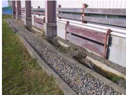
写真 7.72 周辺地盤の沈下(NGO-4)
