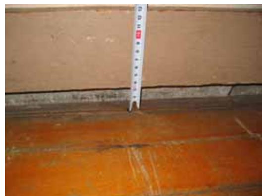
写真 7.31 床の沈下(OJY-14)
