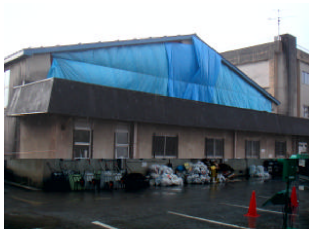
写真 7.46 ラスボードモルタルの全面脱落 (0JY-17)
