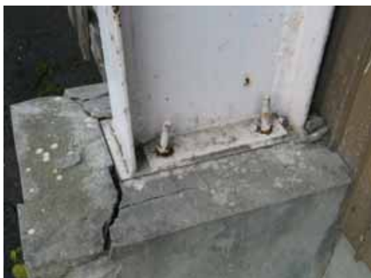
写真 7.11 柱脚コンクリートの破壊（OJY-25）
