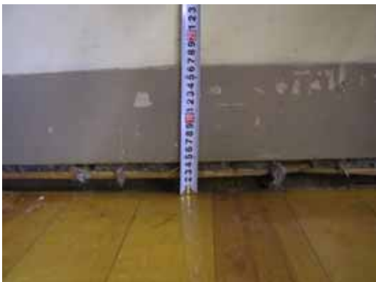
写真 7.30 床の沈下(OJY-5)
