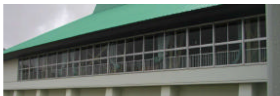
写真 7.38 ガラスの多数破損した窓（修理済み）上段の多くが破損した(OJY-3)
