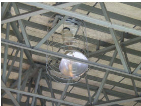
写真 7.63 壊れた照明器具(HRN-5)
