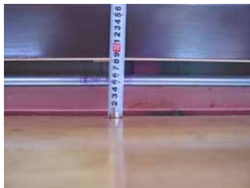
写真 7.35 床の沈下(NGO-4)
