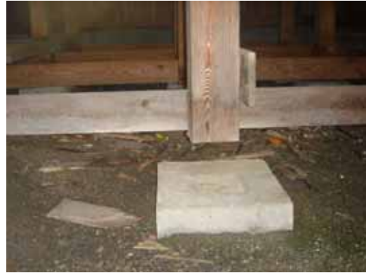
写真 7.70 束台の沈下(KWG-4)
