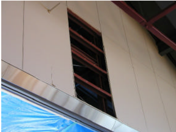
写真 7.51 たれ壁部分のせっこうボード落下 (KID-4)
