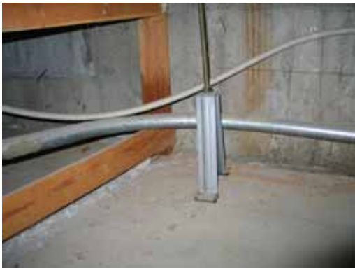
写真 7.71 土間コンクリートの沈下(TOK-1)
