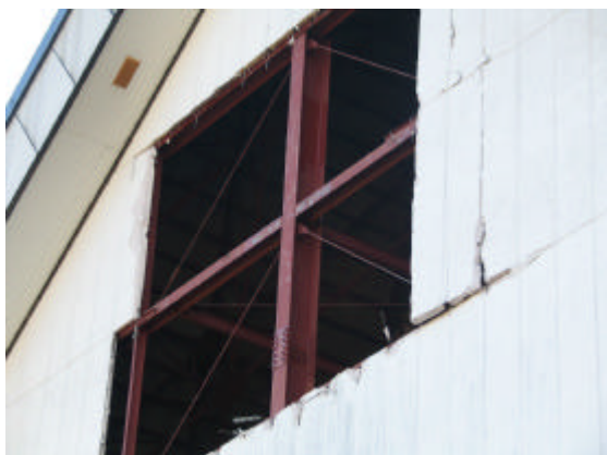
写真 7.47 ALC パネル縦壁挿入筋構法の脱落 (KWN-2)
