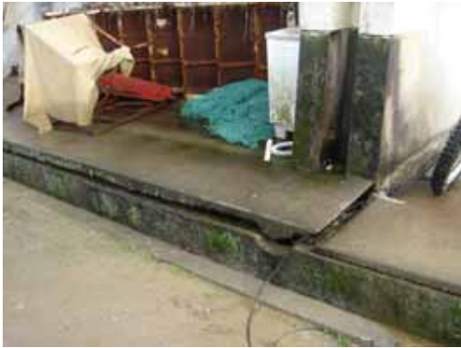
写真 7.69 周辺地盤の沈下(OJY-15)
