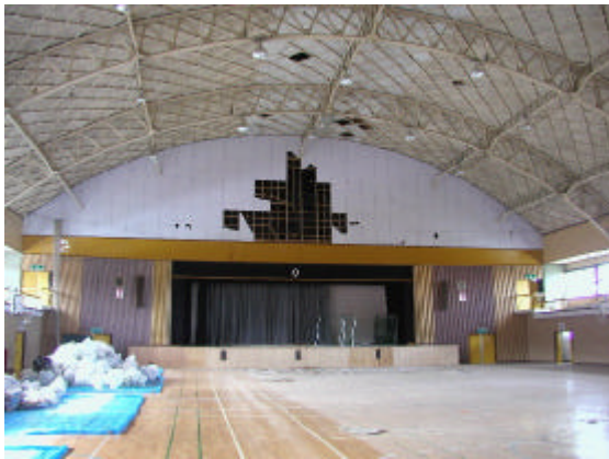
写真 7.57 木毛セメント板の落下(OJY-12)
