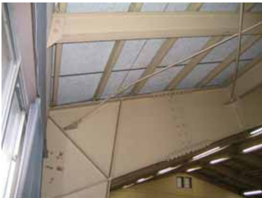
写真 7.22 水平ブレースのたわみ(OJY-5)
