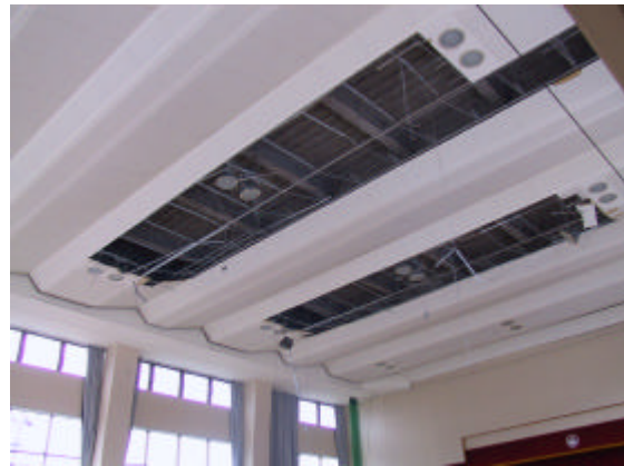
写真 7.58 ロックウール吸音板捨て張り工法天井の落下(KWG-2)
