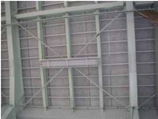
写真 7.28 水平ブレース座屈(OJY-21)
