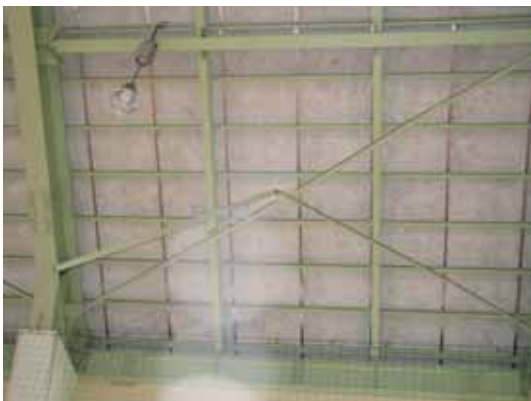
写真 7.24 水平ブレース破断(OJY-16)
