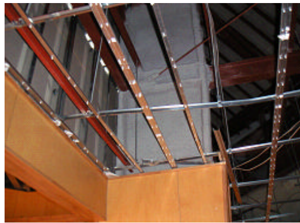
写真 7.62 ギャラリー天井の落下(KSJ-3)
