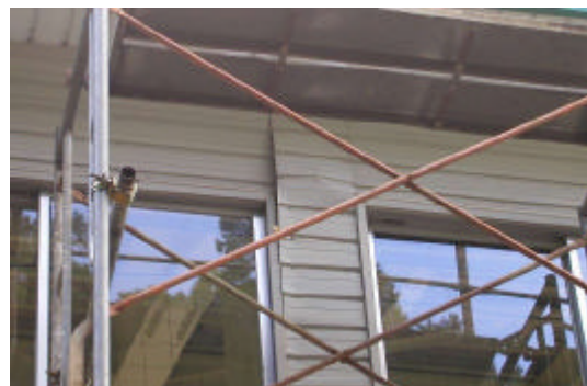
写真 7.39 下地の異常と思われる壁材の破損(OJY-21)
