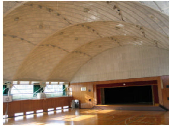
写真 7.54 左と同じ工法で被害の無かったもの(KWG-4)
