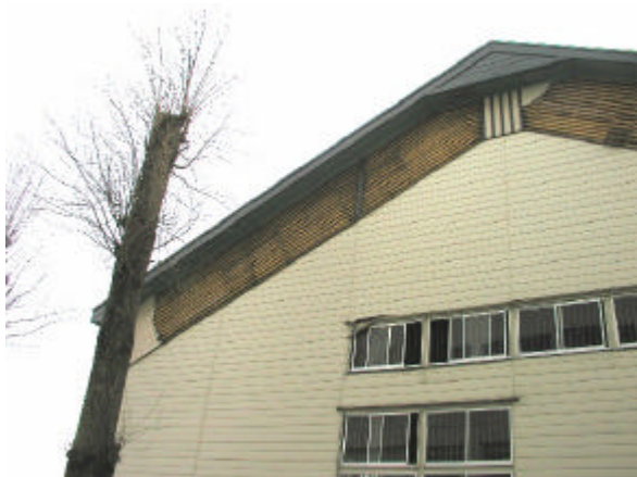
写真 7.45 ラスモルタルの脱落 (0JY-9)
