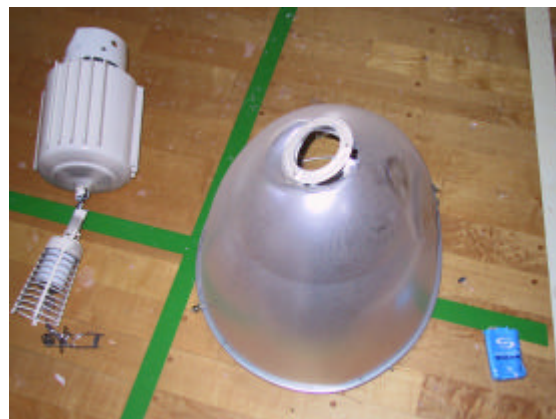
写真 7.64 落下した照明器具(HRN-5)
