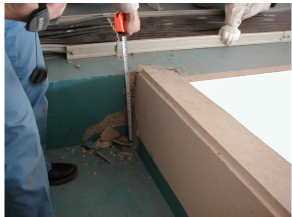
写真 2.4.8 下部 RC 造の梁端部に生じたクラック
