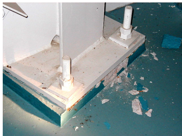
写真 2.4.7 ならしモルタルのひび割れ
