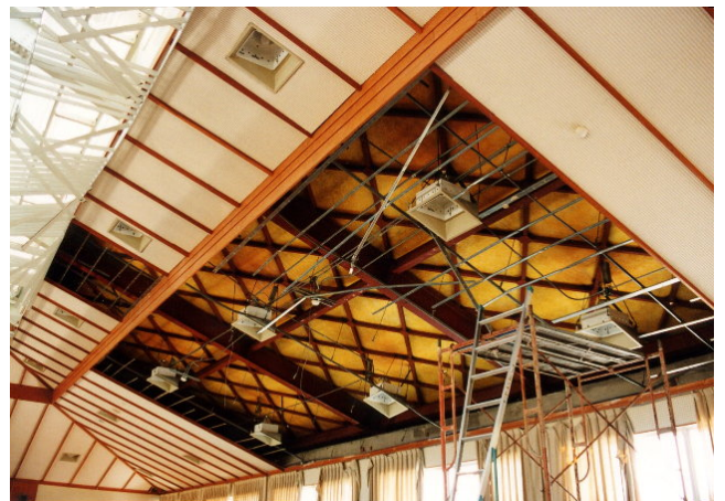
写真 2.2.4 天井落下状況（軽量鉄骨下地材も見える）
