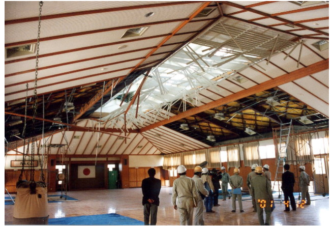
写真 2.2.2 武道場内部の損傷状況
