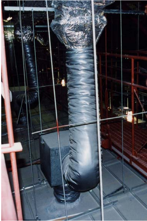
写真 2.1.9 空調用吹き出し口
