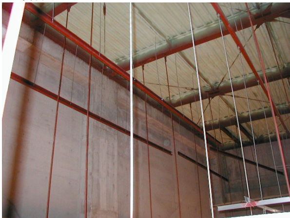
写真 2.1.5 斜めの振止めが配置されていない（水平方向の振止めも見られない）
