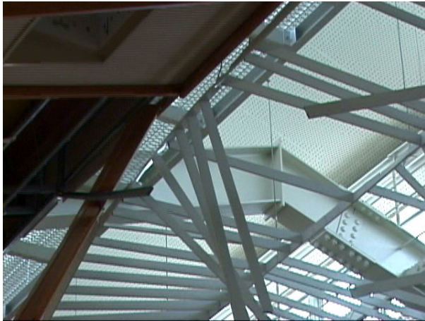
写真 2.2.1 棟部位につなぎ梁無し
