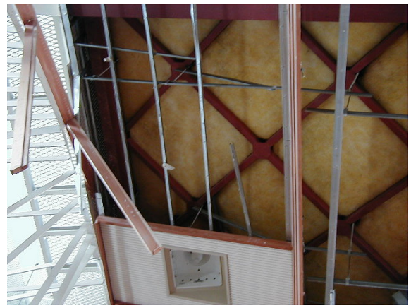
写真 2.2.8 天井中央に近い幕板の損傷
