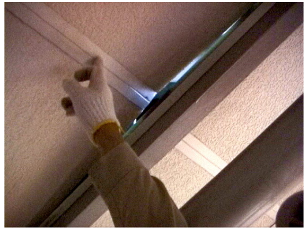
写真 2.3.3 置かれただけの天井材
