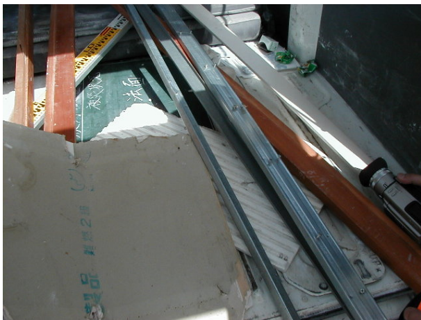
写真 2.2.11 落下した天井材他（一部保管していた物）
