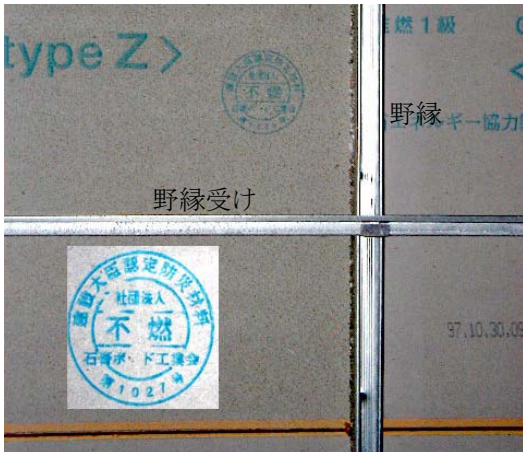
写真 2.1.3 アリーナ部分の天井に使用されていたせっこうボード（天井の裏側：縦の枠材が野縁、横材が野縁受け）
