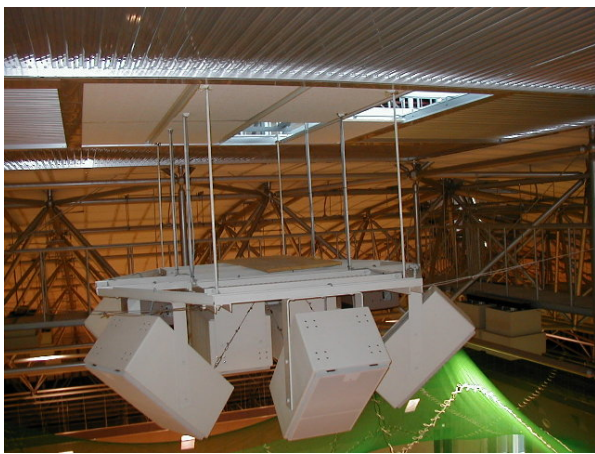
写真 2.3.4 天井材の落下（下より）
