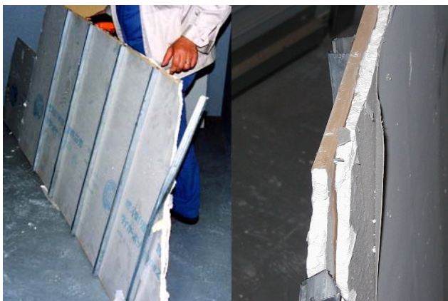
写真 2.1.11 落下した天井材
