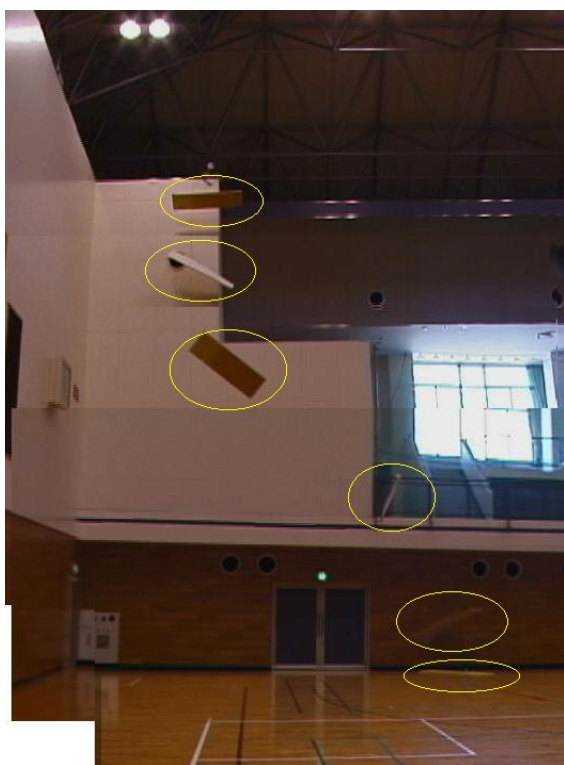
写真 4.1 グラスウールボードの落下状況
