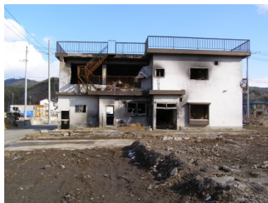
← 全焼した建物
